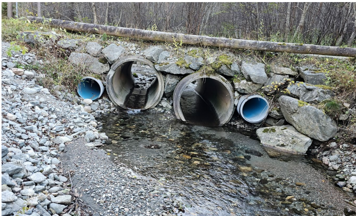
Bilde 11. Nederste vegkulvert i Sandgrova. Denne kulverten kan være vandringshindrende ved høy vannføring, da vannhastighetene kan bli høye. Foto: Espen Holthe.
