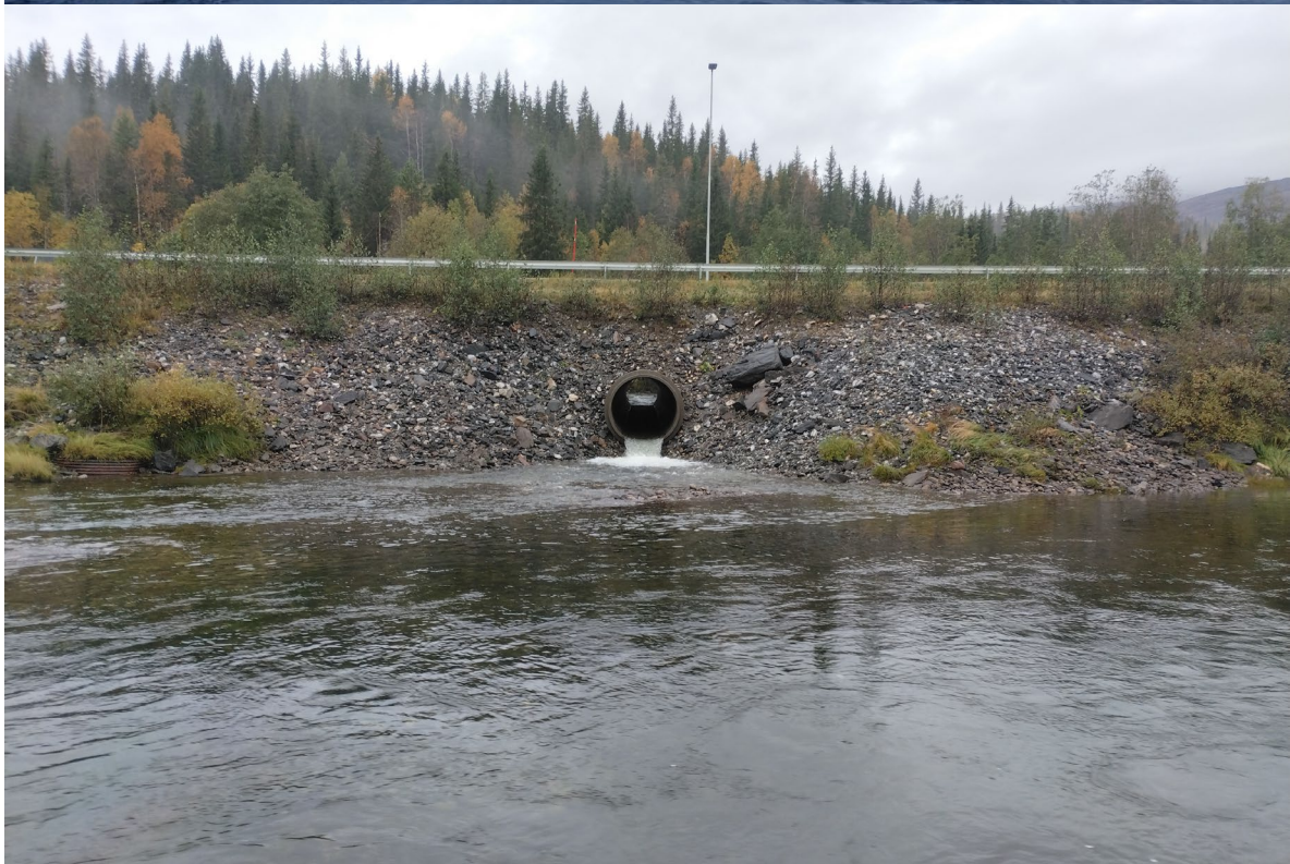
Bildeserie 9. I forbindelse med bygging av ny E6-trasé nord for Mo i Rana, har Neveråga blitt gjort utilgjengelig for oppvandrende fisk. Den feilkonstruerte veikulverten hindrer vandring fra Ranaelva til Neveråga. Dette gjelder ikke bare ved normale vannføringer som i starten av september 2022 (øverste bilde), men også ved høye vannføringer som i slutten av september 2023 (nederste bilde). Foto: Gunnbjørn Bremset.
