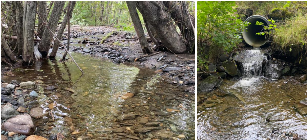
Figur 73. Strekninger i nedre del av sidebekken (t.v.) nedstrøms veikulverten (t.h.) under Rokkmakarvegen. Veikulverten stopper fiskevandring. Foto: @Morten Andre Bergan
