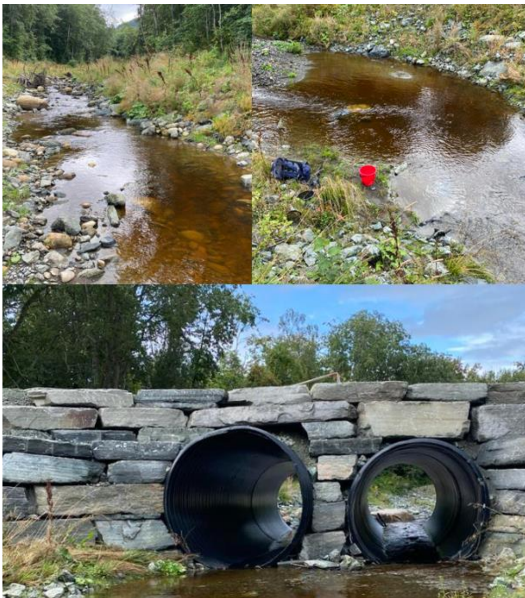
Figur 24. Øverst: Deler av stasjonsområde 4 – 3 og 4 – 4 i et øvre, nylig restaurert del av Ratbekken i 2023. Nederst: Nyoppført kulvert like nedstrøms begge nevnte stasjonsområder. Foto: @Morten Andre Bergan
