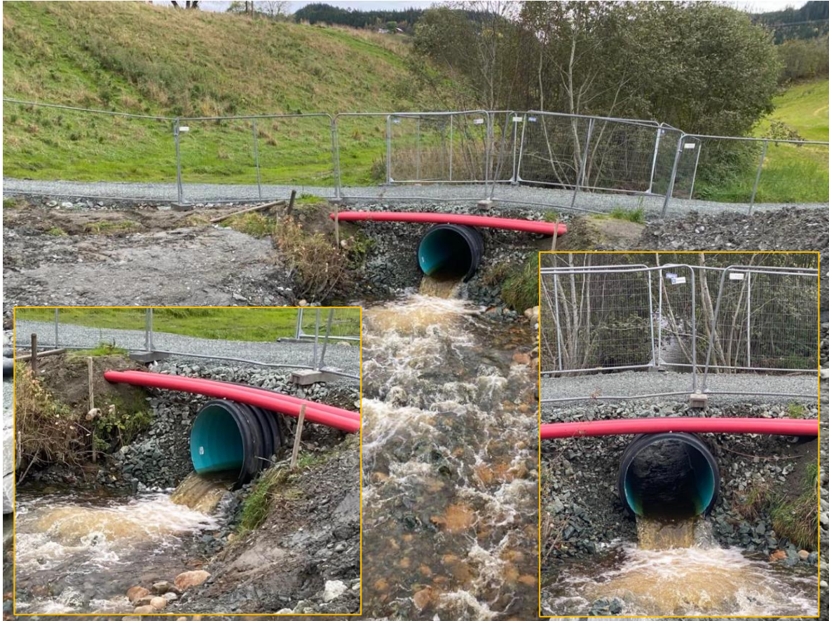
Figur 53. Status i anleggsområdet for ny kulvert i Bortna den 10. oktober 2023. Midlertidig løsning er forbedret. Dette ga et lavere sprang og dypere satskulp nedstrøms plastrøret, slik at noe gytefisk kunne vandre forbi. Foto: @Morten Andre Bergan
