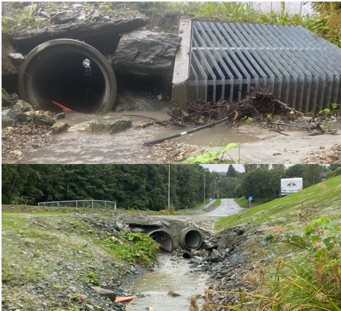
Figur 36. Kulverten under Varmbuvegen er i praksis fiskestoppende, men siden den nye kulverten under Statsråd Nissens veg allerede hindrer sjørrret fra å vandre, vises ikke dette i ungfisk-data i dag. Varmbubekken er fisketom ovenfor Varmbuvegen i dag. Foto ovenfra (øverst) og nedenfra (nederst) i bekkeløpet. Foto: @Morten Andre Bergan
