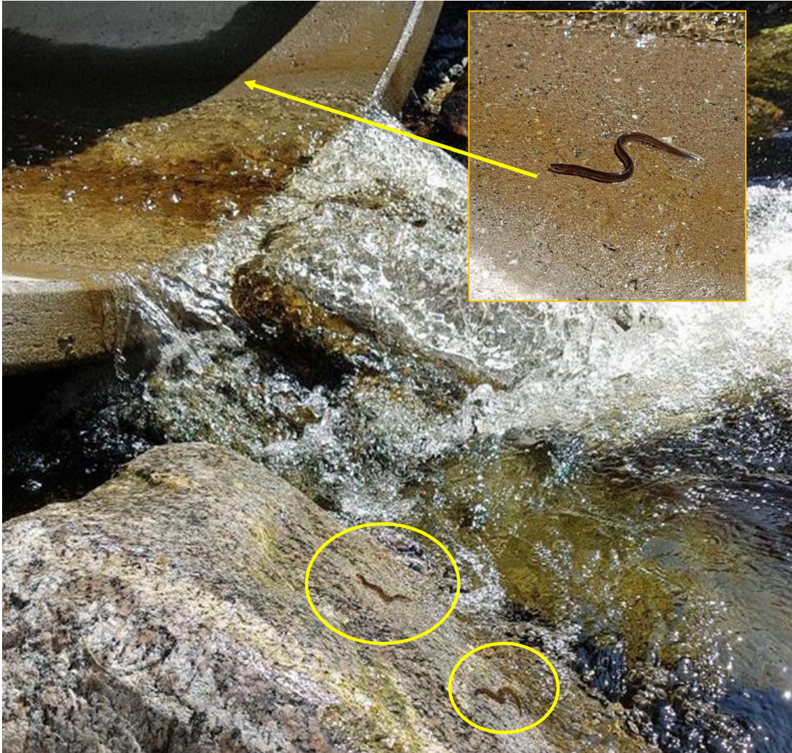
Figur 3. Små ålefaringer som har store problemer med å vandre forbi en veikulvert i et lite vassdrag i Heim kommune. Foto hentet fra Berg & Bergan (2023). Foto: @ Martin Georg Hanssen.
