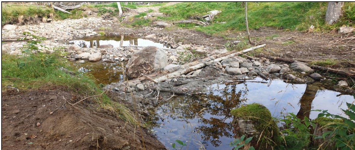
Bilde 17. Det har foregått omfattende gravearbeider i nedre deler av Aunskarelva der elva har blitt demmet opp. Bildet er tatt om lag 150 meter fra utløpet til Oksdøla.
