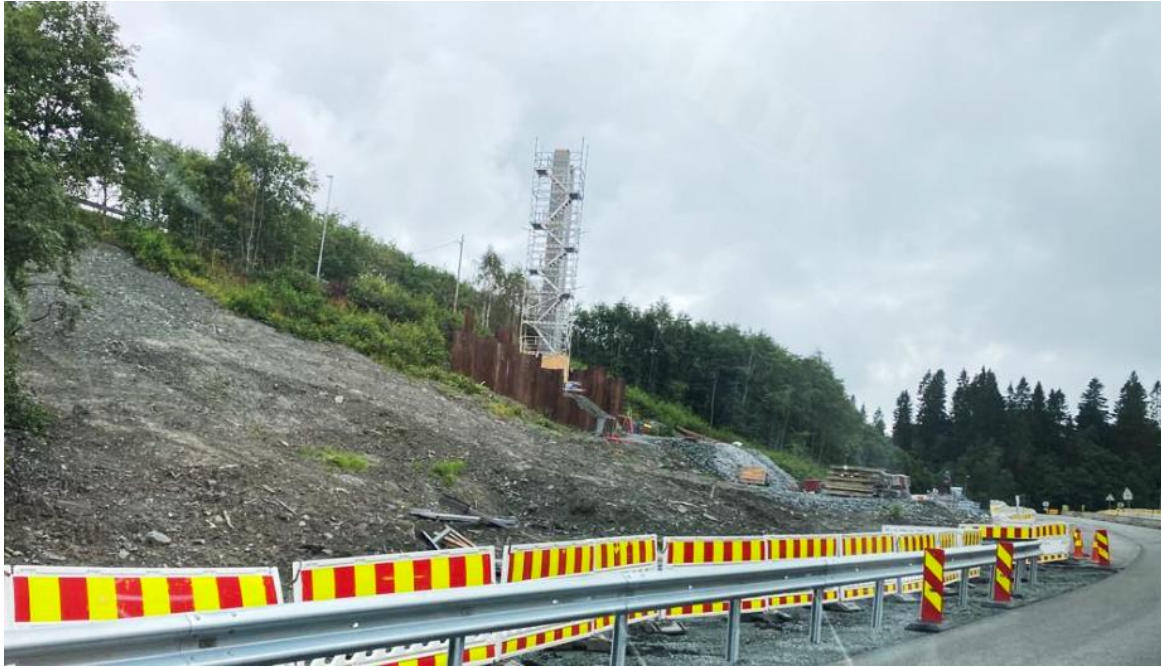
Figur 25. Grave- og anleggsarbeid i og langs bratte bekkesider i Heimdalsbekken det sist året. Denne «nye» belastningen kommer i tillegg til øvrig forurensning til bekken, og har bidratt i at samlet belastning av partikler og generell vannkvalitet har vært langt over bekkens selvrensningsevne de siste årene. Foto: @Morten Andre Bergan
