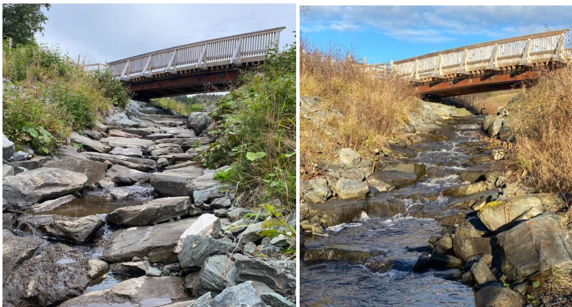
Figur 47. Strykparti nedstrøms første dam er vandringshindrende. Foto på lav vannføring i september 2022 (t.v.), og normal vannføring i oktober 2023 (t.h.). Foto: @Morten Andre Bergan
