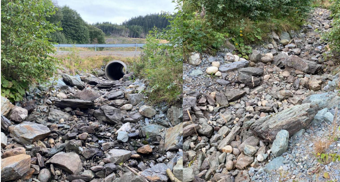
Figur 44. Periodevis tørt bekkeløp i Storvollbekken nedstrøms Sveanvegen skyldes utilstrekkelig tetting etter sikringsarbeider, slik at vannet renner under bekkebunnen ved lav vannføring. Foto fra september 2022. Foto: @Morten Andre Bergan
