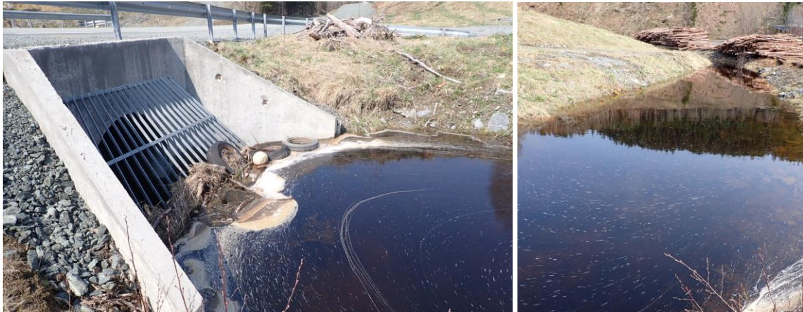
Figur 45. Tilstoppet rist stenger for fiskevandring og demmer opp Storvollbekken oppstrøms. Foto fra befaring i mai 2021. Foto: @Morten Andre Bergan
