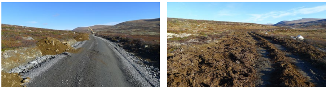
Figur 1.1. I slutfasen av anleggsarbeidet ble vegetasjon og jord lagt tilbake oppå bærelaget og vegen framsto som et kjørespor i terrenget. Foto: Dagmar Hagen.
