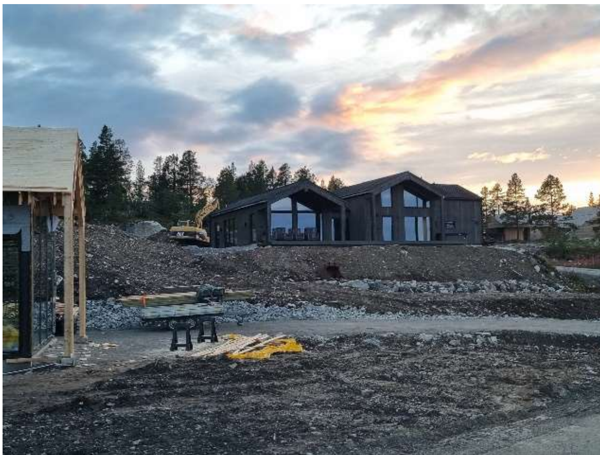
Figur 1. Bygging av nye hytter i Otrosåsen, Hovden. Veg, straum og anna infrastruktur er lagt fram til kvar hytte. Typisk byggemåte her ser no ut til å vere å legge ei pukkfylling i botn, støype ein betongsåle på fyllinga, og så sette opp resten av konstruksjonen på denne sålen. Eit stort areal rundt kvar hytte blir påverka. Foto: Trond Simensen 29.8. 2023.
