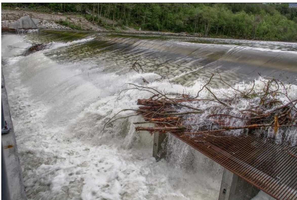
Bilde 1. Den opprinnelige sperrekonstruksjonen i Driva hadde en rist med finmasket gitter, som raskt ble tettet igjen og oversvømt i perioder med høye vannføringer. Foto: Michael Puffer, NGU.
