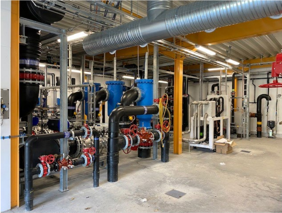
4. Teknisk rom, UV, filter, varmeveklser mm.
