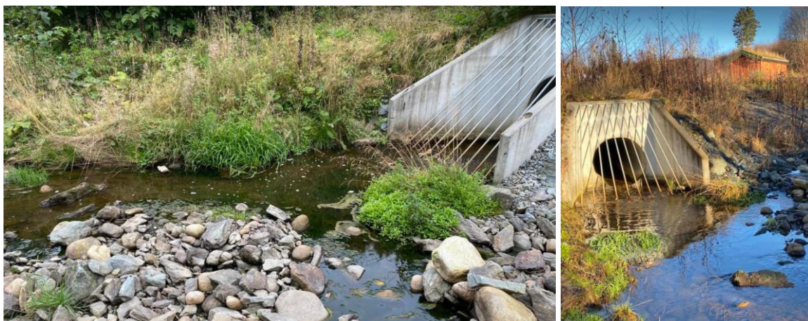
Figur 50. Foto fra 2022. Punktutslipp til Storvollbekken like nedstrøms Sveanvegen forverrer vannmiljøet, og gir risiko for redusert økologisk tilstand i bekken. Foto: @Morten André Bergan/NINA.
