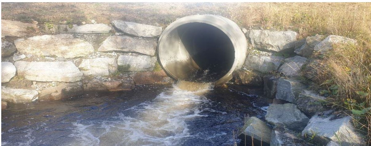
Bilde 1. Relativt nyetablert kulvert under Bjørknesveien ble på befaringdagen vurdert å være et vandringshinder på lavere vannføringer.
