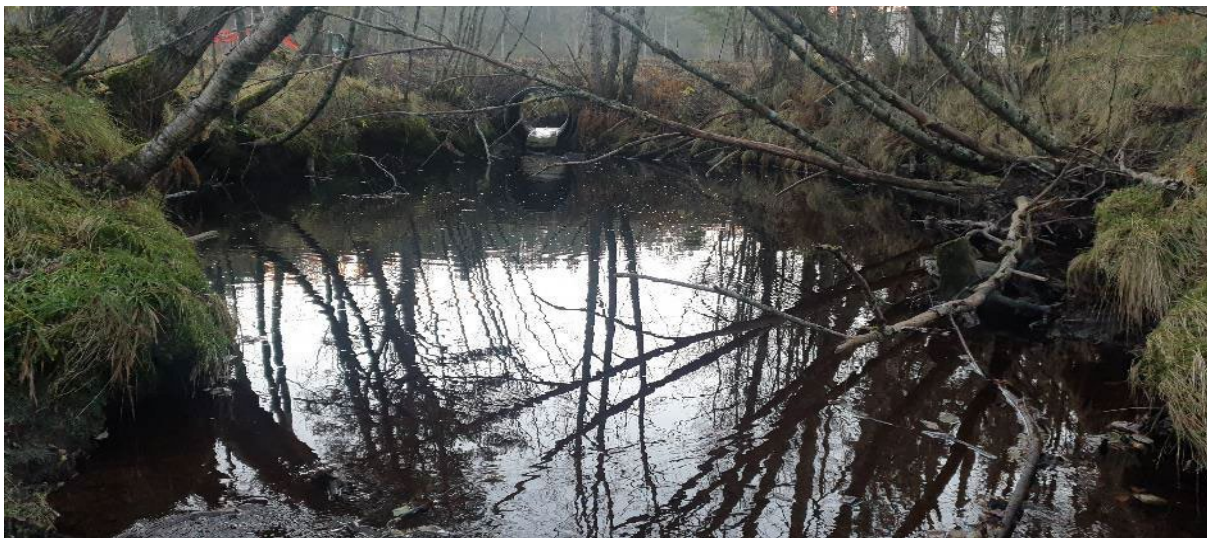
Bilde 4. Kulvert under Vågveien med kulp i nedkant.
