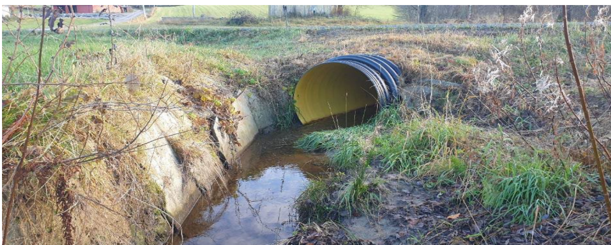
Bilde 1. Kulvert under Likrokveien. Det registreres noe nedslamming av substrat ned mot utløpet til Rovatnet.
