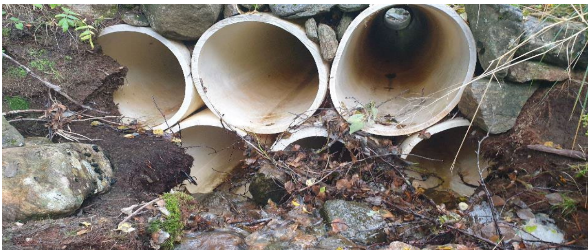
Bilde 3. Kulvert sett ovenfor veien. Kvist tetter innløpet.
