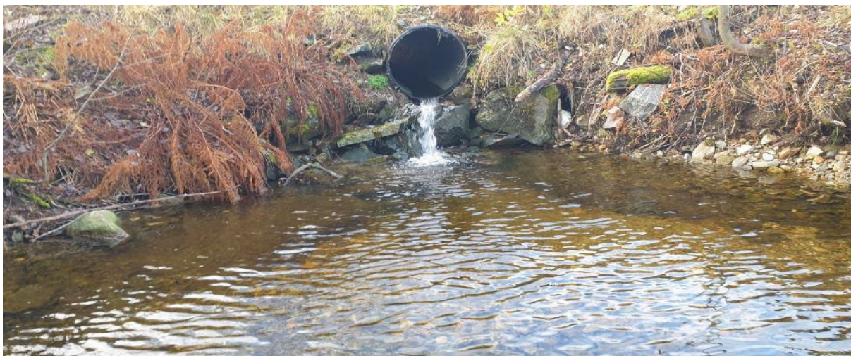
Bilde 2. Kulvert som i dag utgjør vandringsbarriere.
