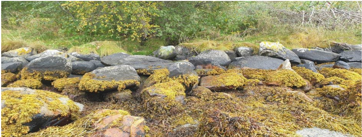
Bilde 1. Utløpsområdet til bekken i sjø er uegnet for oppvandrende fisk.
