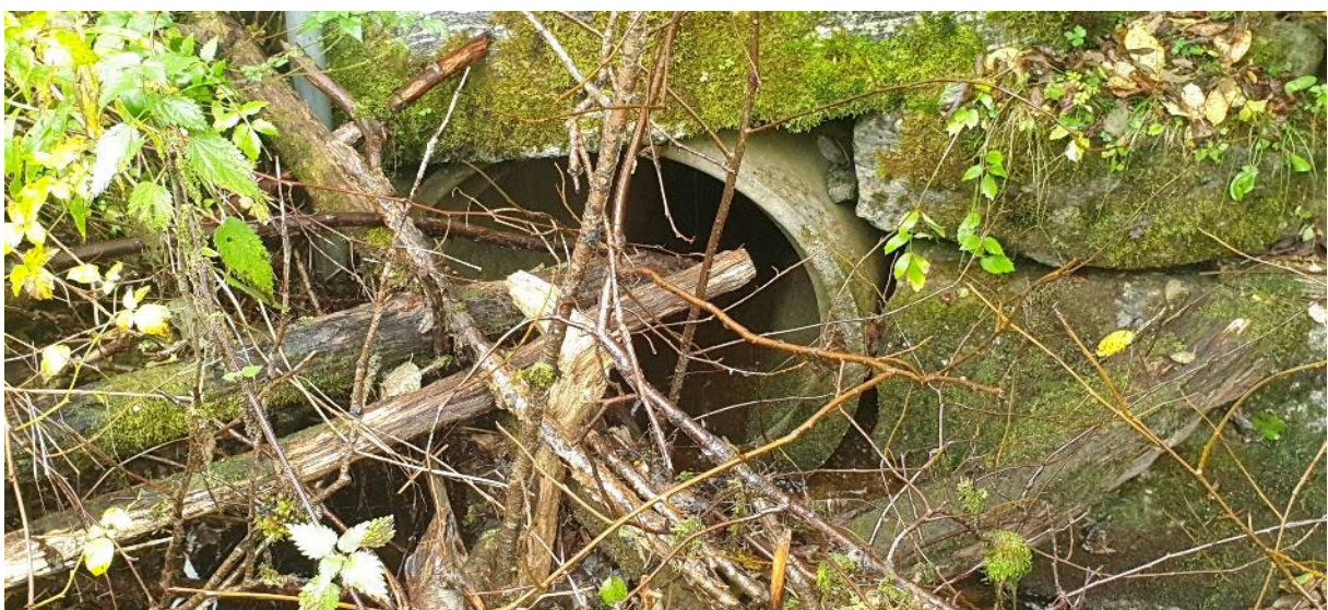
Bilde 2. Kulvert som leder ned mot industriområdet ved Grøtvågen.
