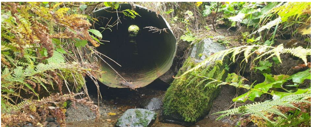
Bilde 2. Kulvert er gjennomrustet og utgjør barriere for eventuell fisk. Det ble ikke fanget fisk i bekken ved el-fiske.
