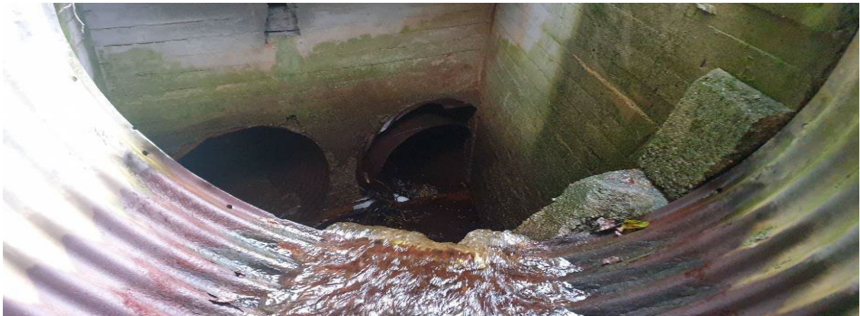
Bilde 3. Fra kulvert er bekken lagt i lukket rørgate forbi industriområdet på Grøtvågen og androm strekning er tapt.
