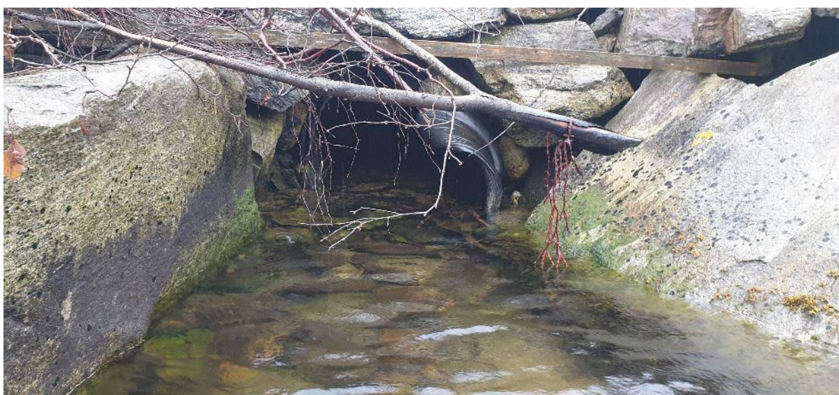
Figur 1. Kulvert til Litlbekken har rast sammen og hindrer oppgang av fisk fra sjøen.
