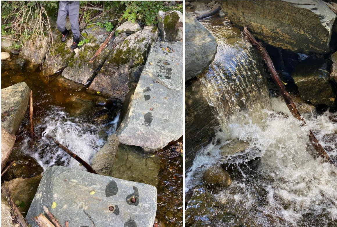
Figur 11. Problemområde i fisketrappløsning i Lauglobekken, som stoppet laks fra videre gytevandring i bekken høsten 2021, og som dermed ikke ga produksjon av årsyngel laks ovenfor i 2022. Punktet har potensiale til å gi vedvarende vandringsproblemer for mange størrelser av gytefisk, også sjørret, i årene som kommer, og bør avbøtes. Foto: NINA.
