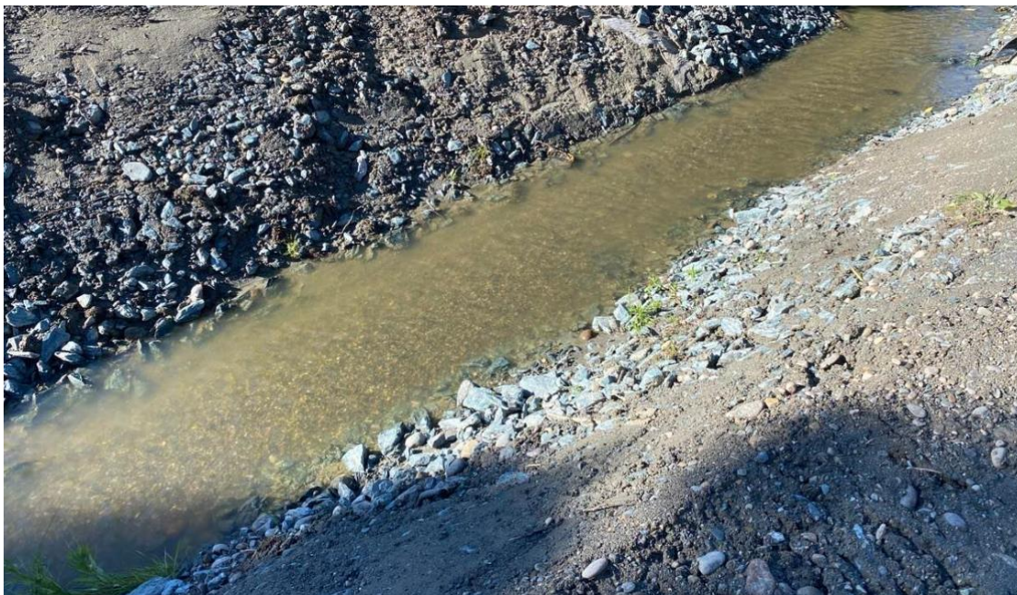
Figur 25. Bekkeløpet i store deler av anadrom strekning i Varmbubekken er fullstendig ødelagt etter anleggsarbeider siste år. Varmbubekken etterlates som ei nedslammet, kanalisert grøft etter arbeidets slutt. Foto fra 23. august 2022. Foto: NINA.
