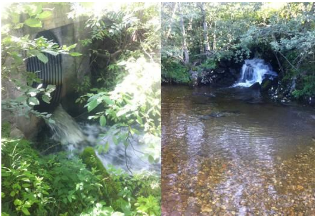
Figur 60. Veikulverten under Rørosveien, som tidligere stoppet all oppgang av sjørret og laks i Havsbakkbekken. Arkivfoto fra 2011, som viser status før tiltak. Foto: Morten André Bergan.
