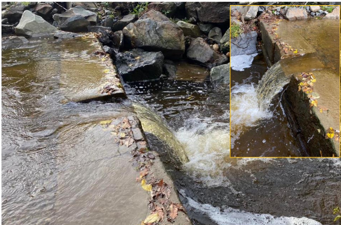
Figur 52. Første fall i den utbedrede fisketrappa nedstrøms jernbanen i Lynga er ikke optimalt utformet, med for stort fall for å tilfredstille en beste praksis løsning i sjørretbekker til Gaula. Foto på normal vannføring høsten 2022. Foto: @NINA.
