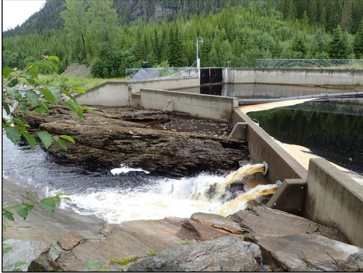
Figur 2. Inntaksdammen til Knutfoss kraftverk. Minstevannføringen forbi inntaket er 0,4 m 3 /s hele året. Foto: Bjørn Mejdell Larsen.
