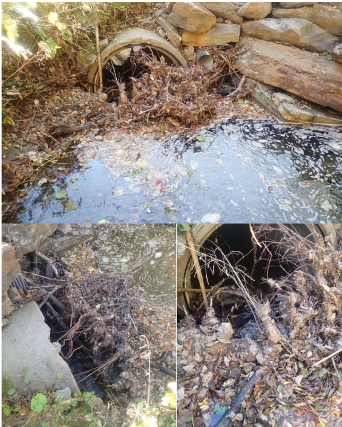
Figur 20. En utrangert traktorvei, med kulvert som er underdimensjonert for Florbekkens vannføring, er tett. Inngrepet vil på sikt stenge sjørret ut fra de viktigste gyteområdene oppstrøms. Status høsten 2021. Foto: Morten Andre Bergan.
