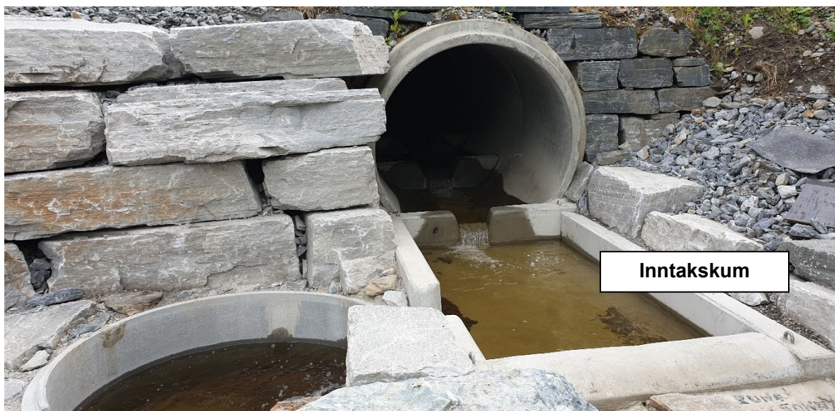
Figur 10. Inntakskum som lar flomvannet gå rett frem for å beskytte fiske-trappa. Grunn kum med skrå opp i front slik at grus og stein spyles ut. Foto er tatt før vangen er montert (se figur 12 ). Foto: Arne Jørgen Kjøsnes, NVE
