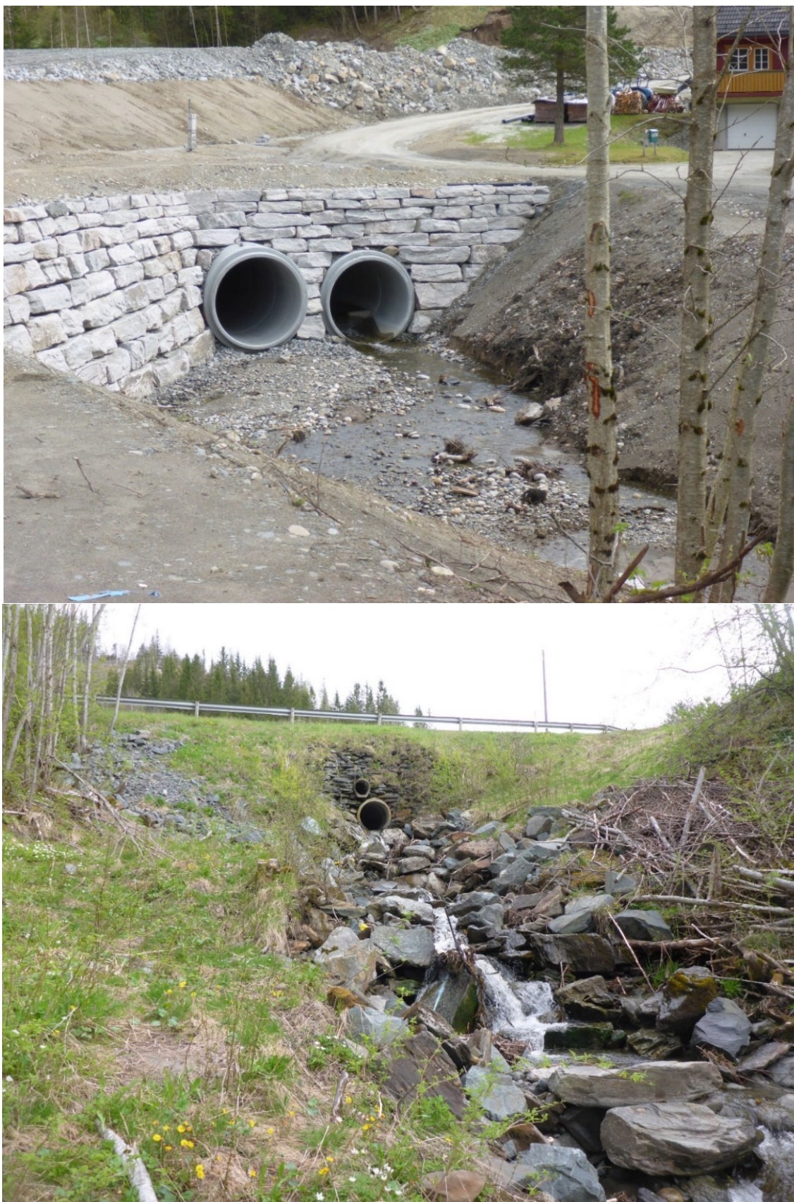
Figur 7. Øverst viser ny kulvert under den kommunale Melmyrvegen, mens bildet under viser tidligere kulvert under E14. Foto: Arne Jørgen Kjøsnes, NVE
