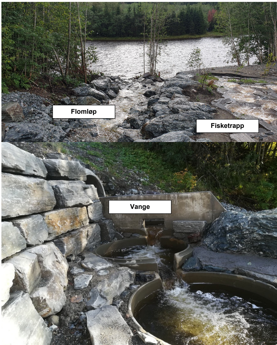
Figur 12. Øverst: Trappa til høyre og flomløp rett fram. Foto på høy vannføring. Merk at flomløp og fisketrapp har felles samløp med elva. Nederst: Vange som begrenser vannmengde inn i trappa. Foto: Øverst: Arne Jørgen Kjøsnes, NVE. Foto nederst: Sonny Bolin.
