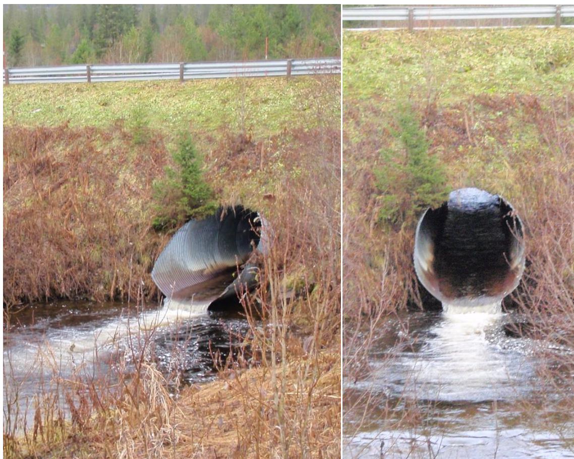
Figur 25. Kvitnesbekken passerer Nesnaveien i en ugunstig utformet kulvert med hensyn til fiskevandring. Bilder fra 2009. Foto: Morten Andre Bergan.
