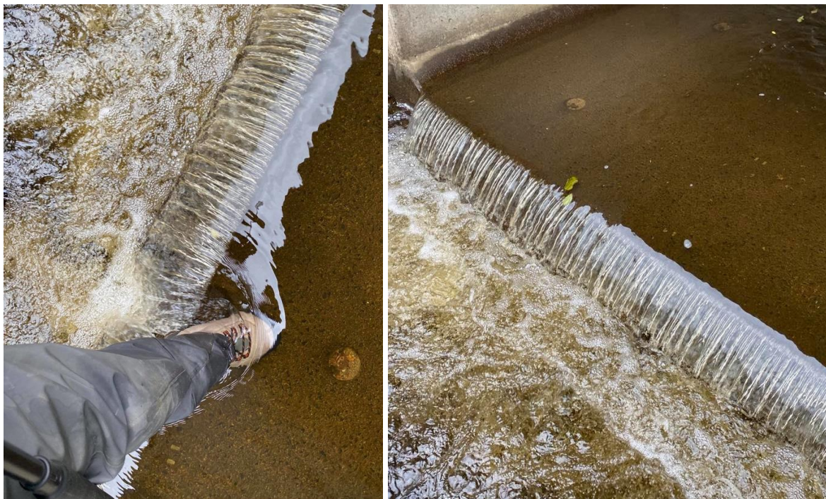
Figur 67. Kulvert med flat betongbunn og omlag 10 cm vanddyp, med 30 cm fall nedstrøms (t.h.). Foto: NINA.
