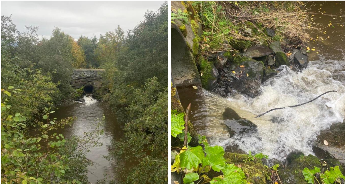
Figur 11. En underdimensjonert betongkulvert under eldre traktorvei (til venstre.) stenger i enkelte år for oppvandring av sjøørret, dersom optimal vannføringen uteblir før gytetidspunktet. Høsten 2021 sto ei jernstang ut i bekkeløpet nedstrøms utløp fra kulverten (foto til høyre) Foto: NINA.
