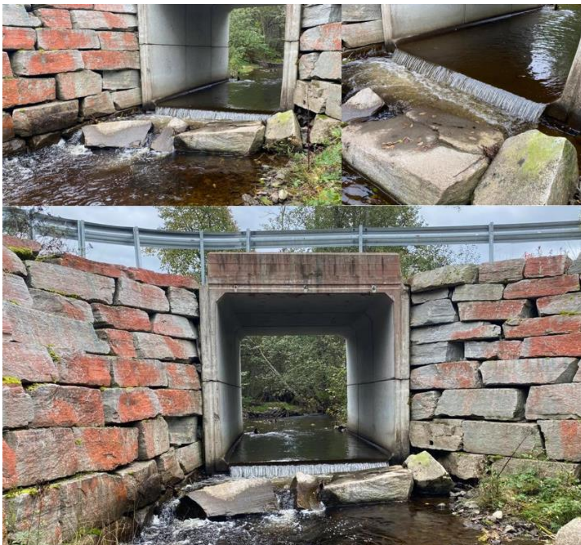
Figur 66. Storstein og blokk ligger utlagt like foran kulverten (t.v. og under), som har flat betongbunn med 30 cm fall nedstrøms (t.h.). Inngrepet i vandringsveien for laks og sjørret synes helt unødvendig. Foto: NINA.
