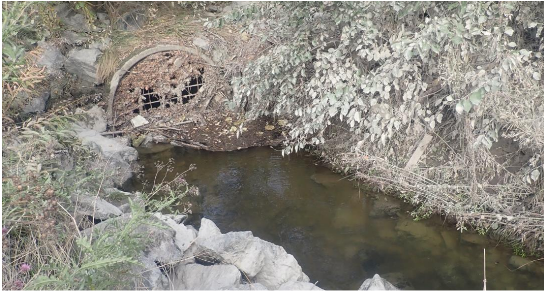
Figur 25. Overside av jernbanekulvert med delvis tett rist høsten 2021. Foto: NINA.
