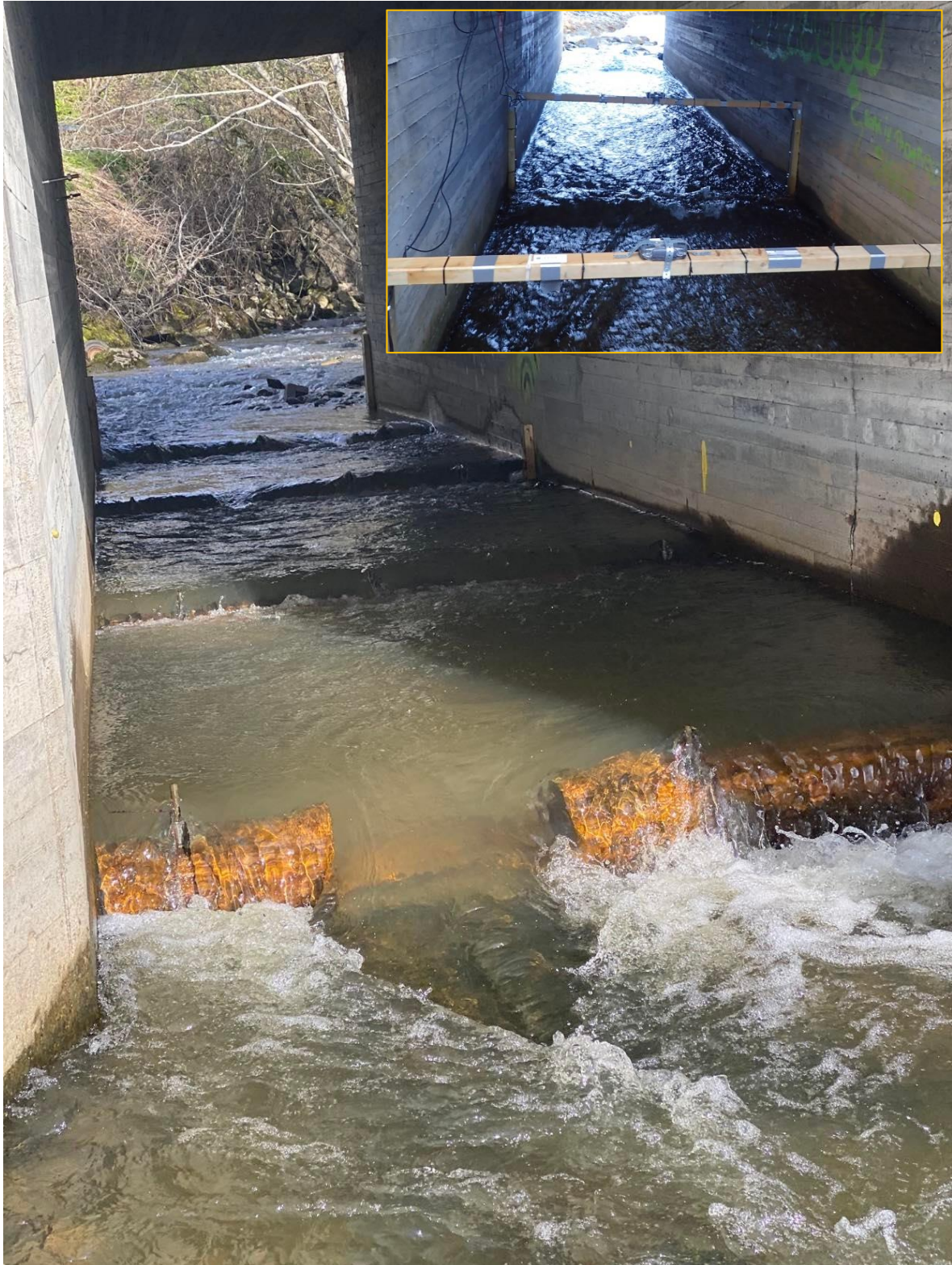
Figur 70. Terskel-/buneløsning, med fastmonterte trestammer på flat betongbunn, som har bedret vandringsveien for laks og sjørrett i Klefstadbekken på Byneset. Løsningen anbefales for problemkulverten i Folstadbekken. Foto: NINA. Innfelt bilde viser status i 2016, før tiltak. Foto: Aslak Sjursen, NTNU Vitenskapsmuseet..
