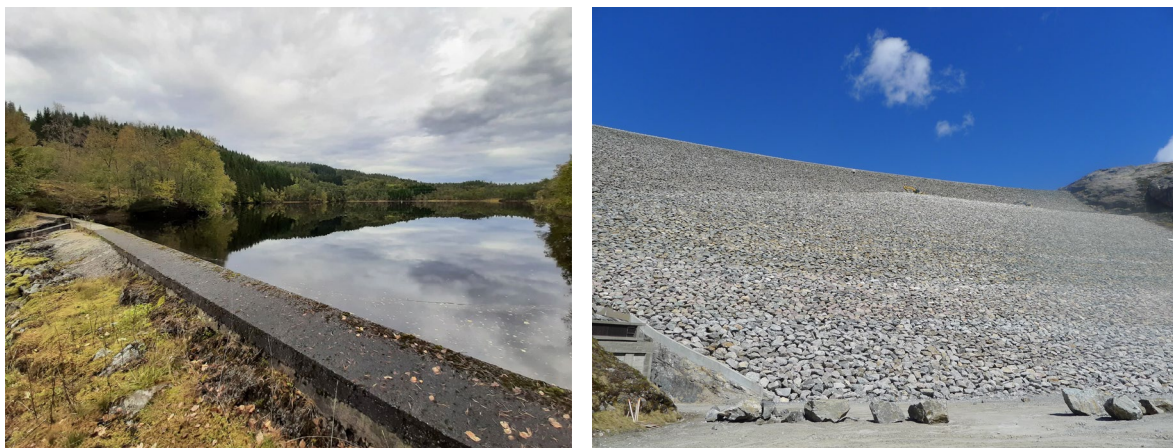
Figur 2. Dammer kan variere fra små og enkle byggverk (til venstre) for regulering av vannstand i små skogsvann opp til enorme konstruksjoner i store vannkraftreservoarer (til høyre). Foto Dagmar Hagen.
