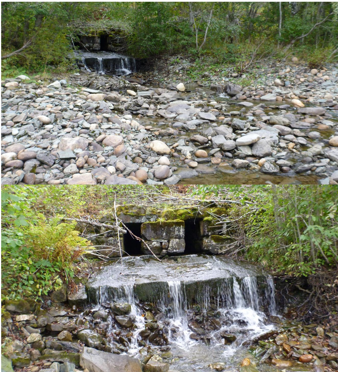
Figur 77. Bjørkbekken munner til Gaula over en høy, oppmurt betongkant i tilknytning til stikkrenna under jernbanen. Dette er én av to årsaker til at Bjørkbekken er fisketom i dag. Foto: Morten André Bergan.
