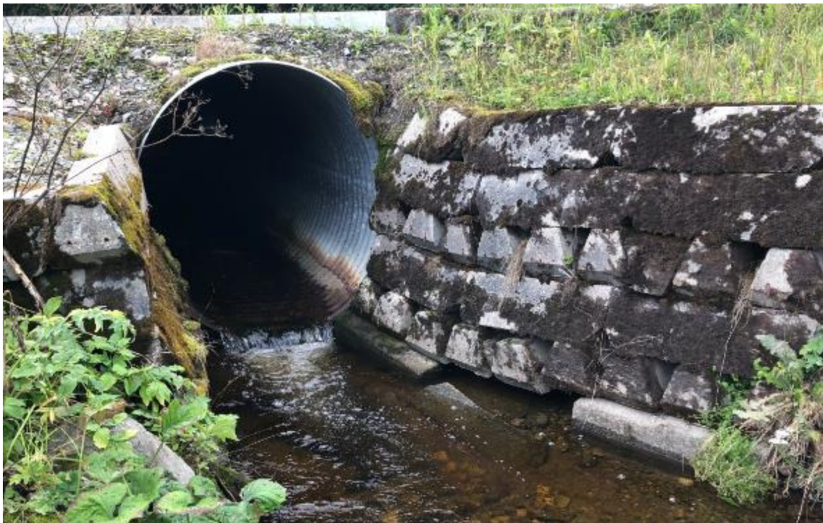
Figur 51. Grinnibekken krysser Grinnisvegen i en kulvert som burde vært byttet til løsning med bevart bekkedunn og større diameter. Foto: Morten André Bergan.
