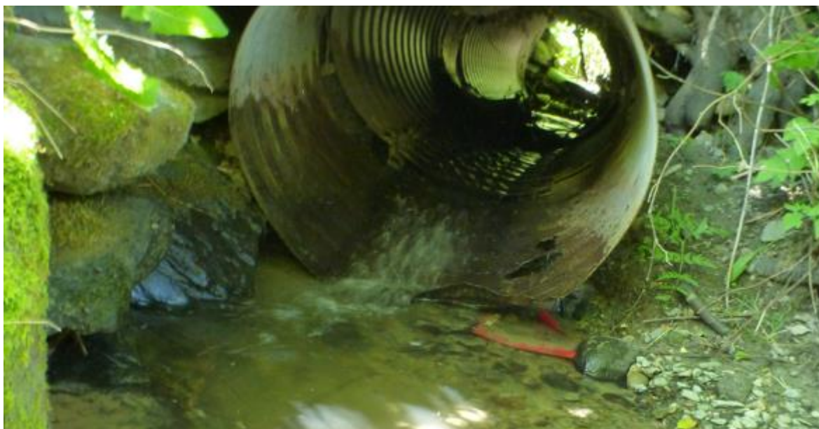
Figur 23. Kulvert i Reitbekken under en gammel gårdsvei som krysser bekken. Foto: Morten André Bergan.
