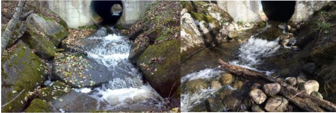
Figur 9. Situasjonen ved kulvert i Lauglobekken i 2013 før avbøtende tiltak ble gjennomført (venstre bilde), og situasjonen i 2015 etter heving av elvebunn og etablering av en enkel bune laget av stein og tre (høyre bilde). Før gjennomførte tiltak var det svært vanskelige oppgangsforhold for laks og sjørret. Foto: Morten André Bergan.
