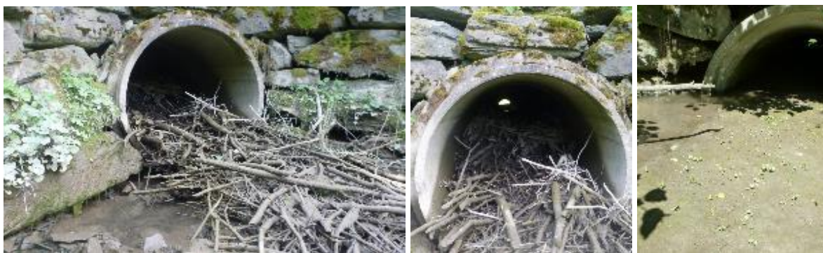
Figur 21. Situasjonen nedstrøms (venstre og midtre bilde) og oppstrøms (høyre bilde) en kulvert under E39 i Reitbekken i 2014. Foto: Morten André Bergan.
