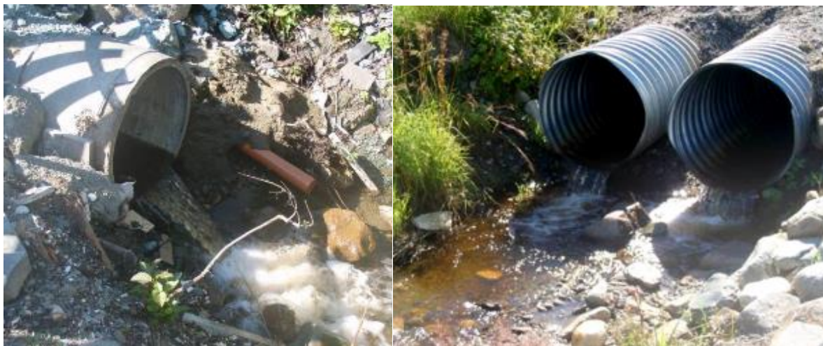
Figur 43. Kulverter i Storrassbekken ved Svingen, Lundamo skole og barnehage (venstre bilde) og Ringvegen (høyre bilde). Foto: Morten André Bergan.
