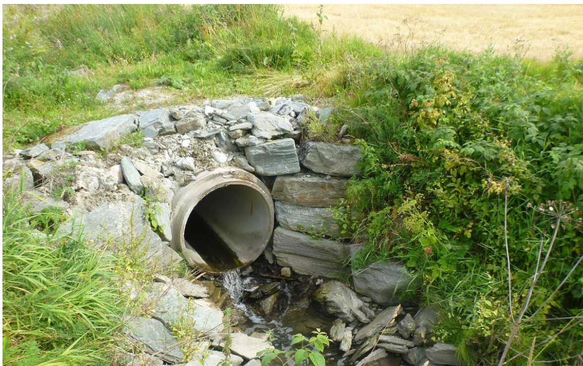
Figur 17. Kulvert under gårdsvei i Ustbekken hindrer oppvandring av fisk. Bekken er derfor fisketom oppstrøms kryssningen. Foto fra 2014: Morten André Bergan.
