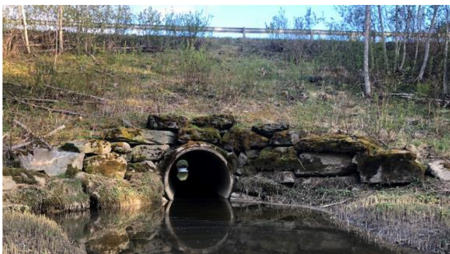
Figur 22. Situasjonen ved kulvert under E39 i Reitbekken på flo sjø. Foto fra mai 2019: Morten André Bergan.
