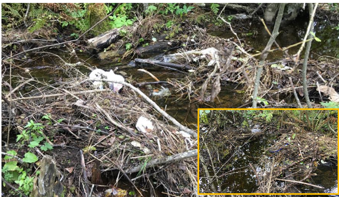
Figur 104. Ringåa nedstrøms fylkesvei 30 og jernbanen er over lang tid tettet av søppel, skrot, hageavfall og trevirke, noe som har gitt oppdemming og oppgangsproblemer for sjørret. Foto: Morten André Bergan.
