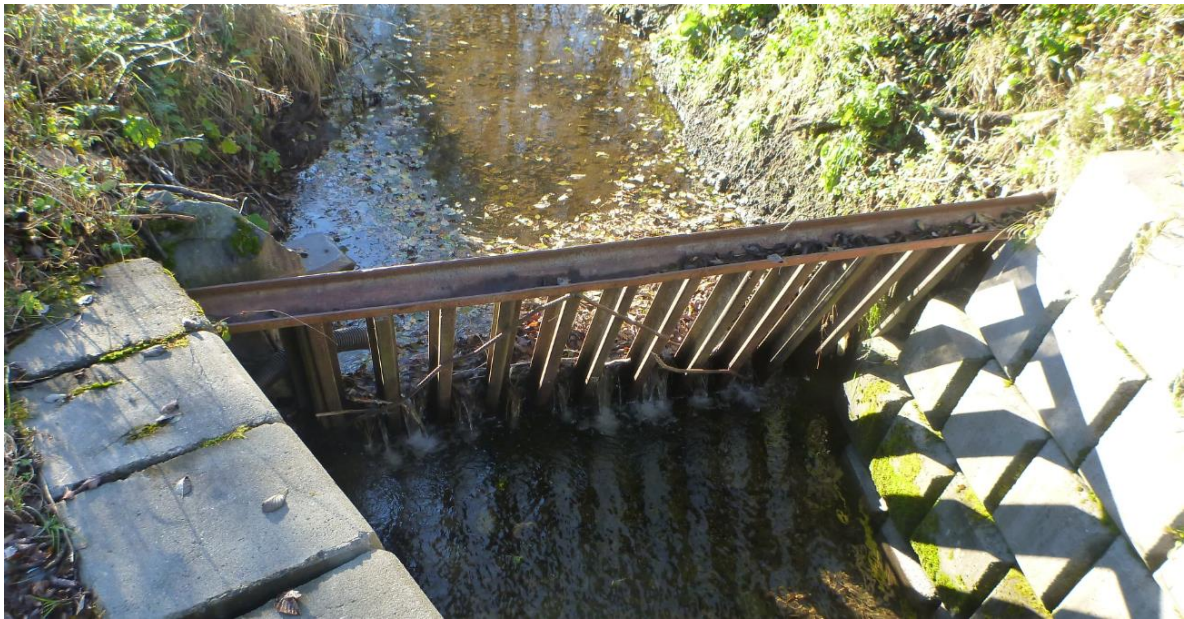
Figur 109. Rist foran kulverten under E6 (venstre bilde) og jernbane (høyre bilde) i Langbekken på Melhus. Foto: Morten André Bergan.
