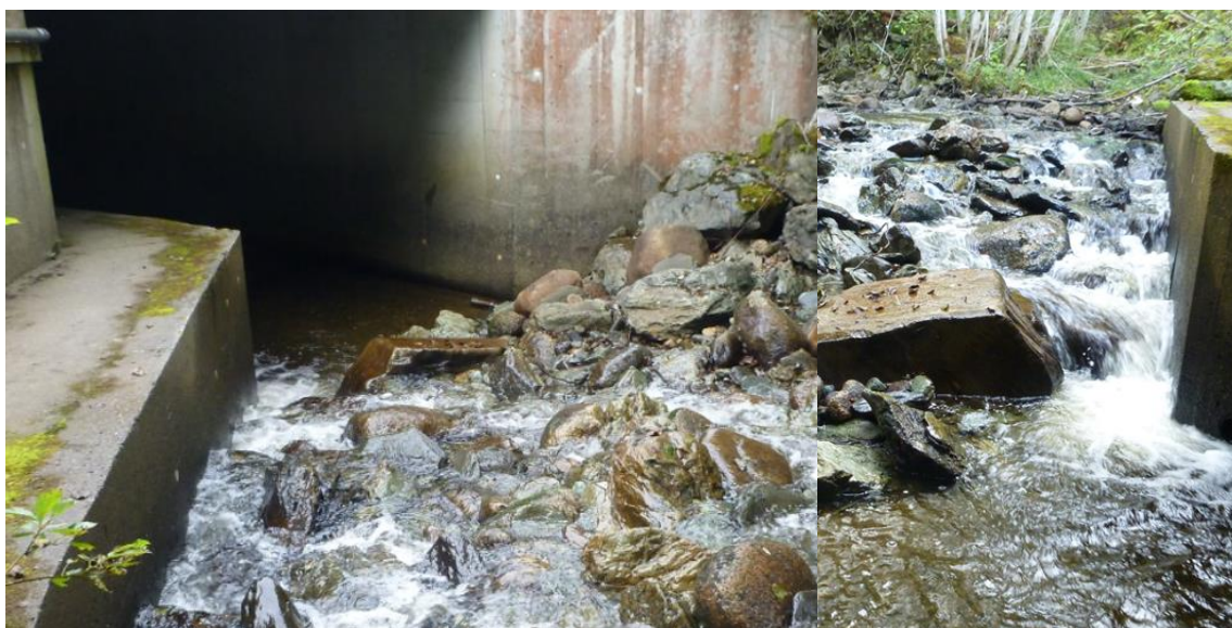
Figur 82. Kulverten under E6 har frie vandringsveier under veien, men bratt fall og avsmalnet bekkeløp ved kulvertinnløpet gjør at vandringsvinduet for fisk er innsnevret. Dette kan få følger for Ræas fiskebestander og gyting i enkelte år. Foto: Morten André Bergan.
