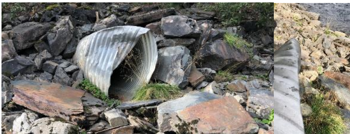
Figur 45. En flomskadd kulvert i Floksa før utløp til Gaula ligger høyt oppe i forbygninga. Foto: Morten André Bergan.
