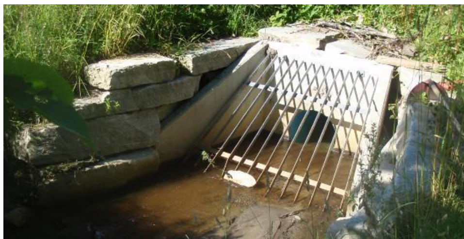
Figur 42. Kulvertinngang for bekkelukking og krysning under Lyngenveien i Storvassbekken. Foto: Morten André Bergan.
