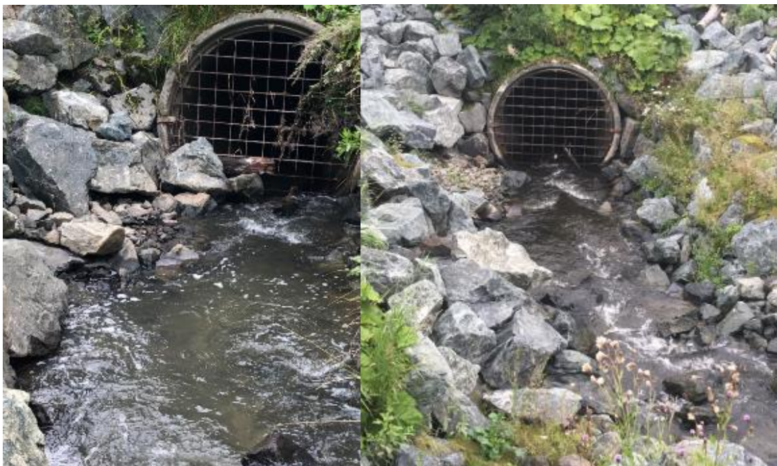
Figur 27. Nedre jernbanekrysning i Langbekken stopper gytefisk som følge av for små åpninger i rista. Dette problemet har vært kjent i lang tid uten at tiltak er gjennomført. Fotografiene er fra 2019 (venstre bilde) og 2016 (høyre bilde). Foto: Morten André Bergan.
