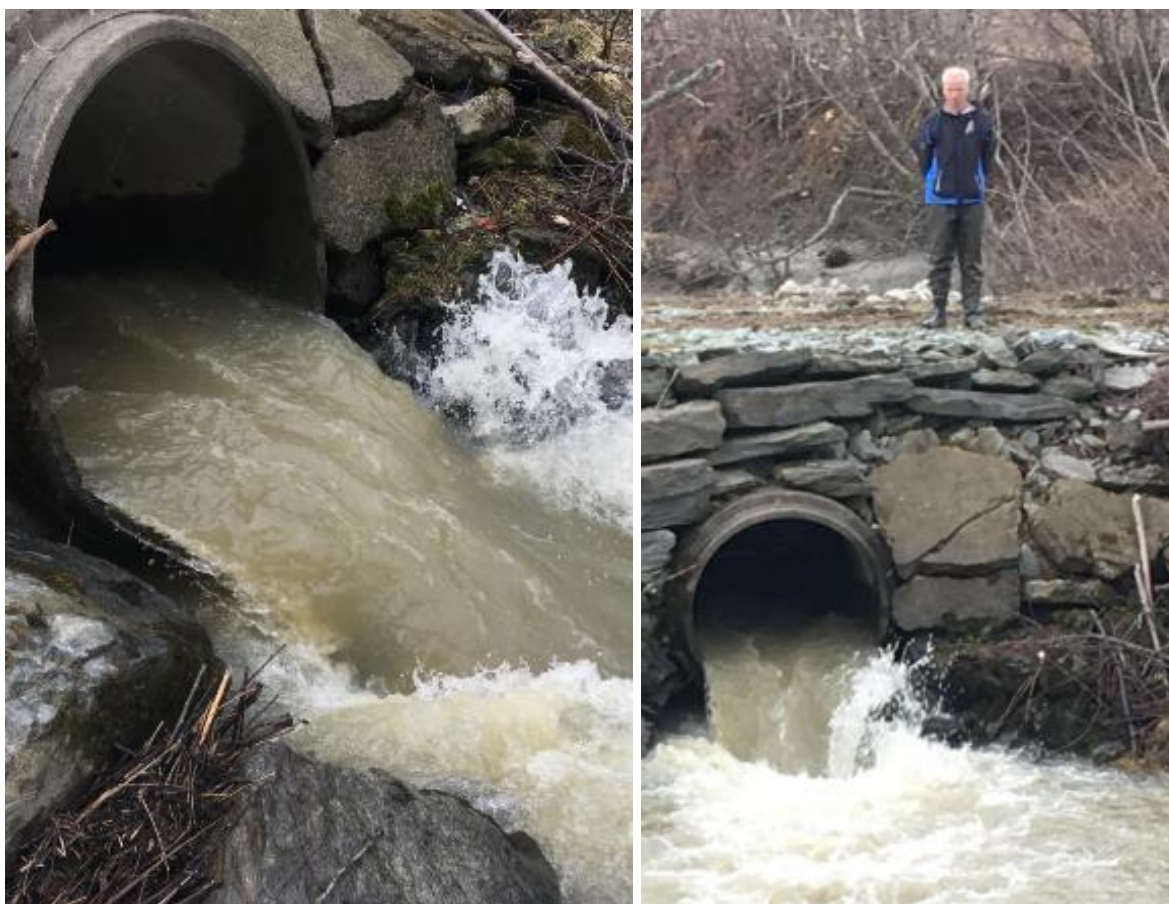
Figur 18. Kulvert under avlingsvei i Eggbekken er svært vandringshindrende på mange vannføringer, og har ført til kollaps i gyting i Eggbekken i enkelte år. Foto: Morten André Bergan.
