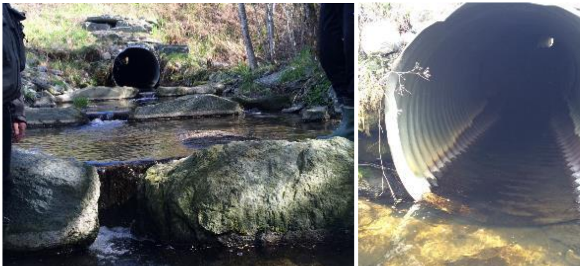
Figur 19. Kulvert under fylkesvei 707 Buskleinbekken er vandringstoppende, tross tiltak nedstrøms veien (venstre bilde), men problemet ligger nå i overkant av fylkesveien (høyre bilde), der fallgradienten gjennom kulverten er høy. Foto: Morten André Bergan.
