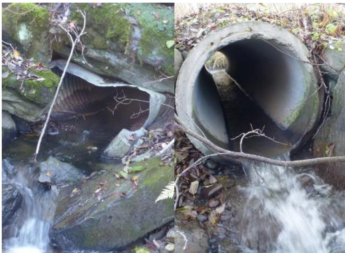
Figur 34. Kulvert under Lebergsveien (venstre bilde) og under grusvei i nedre del av Lera (høyre bilde) må saneres og erstattes med veikrysninger med bevart bekkebunn og vesentlig større diameter. Foto: Morten André Bergan.
