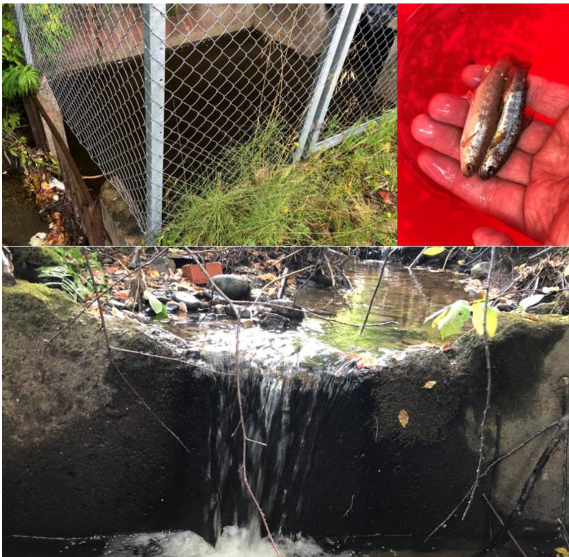
Figur 84. Det registreres ørretunger på strekninger oppstrøms industriområdet (øverste bilde). Ørret i Enganbekken, oppvandet fra Gaula, passerer både stikkrenne under jernbane, veikulvert og lukking under industriområdet, men stoppes av murt betongkant (nederste bilde) rett oppstrøms industriområdet. Foto: Morten André Bergan.
