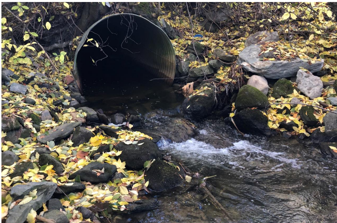
Figur 7. Grilstadbekkens utløp fra kulvert etter lang bekkelukking fra Brundalen til nedre anadrom strekning. Foto: Morten Andre Bergan.
