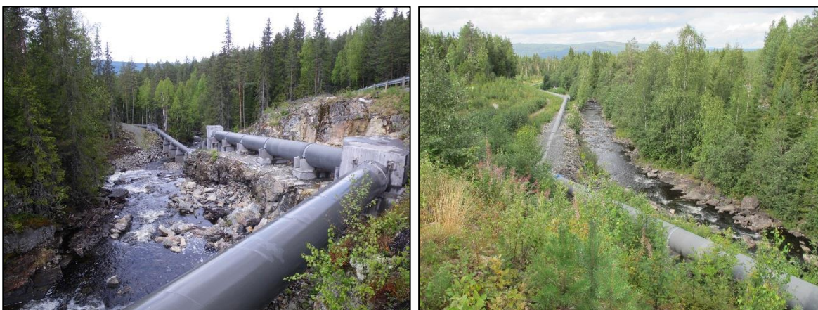
Det er lagt rørgate langs vassdraget fra Linderuddammen til Skrankefossfløyta. Rørgata krysser elva to steder. Foto: Bjørn Mejdell Larsen.
