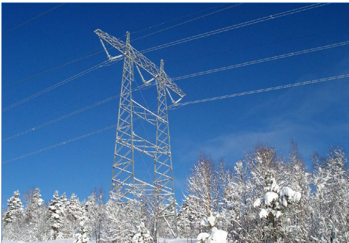
Standard portalmast, bæremast for 420 kV duplexledning, med isolatorskåler av glass opphengt i v-kjeder. (Foto: Statnett).
