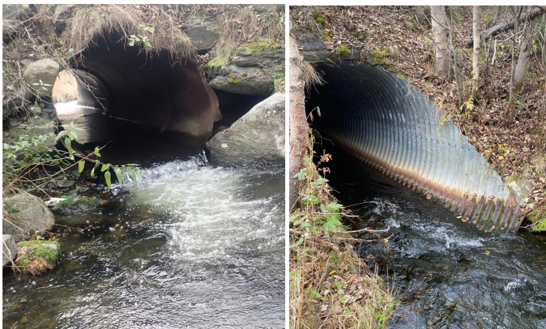
Figur 23. En veikulvert hindrer fiskevandring mellom st. 3 og 4 i øvre del av Retta, men kan svømmes forbi på gunstig vannføring og vanntemperatur. Foto: @Morten Andre Bergan
