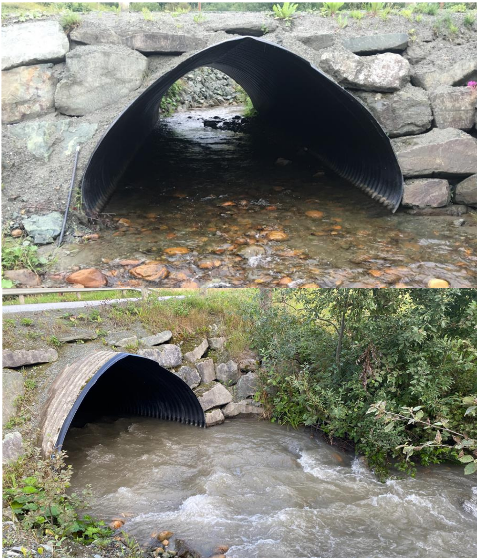
Figur 1. Halvkulvert under Lebergsveien (veinr. 6578) i sidevassdraget Loa til Gaula. Denne veikulverten har vist seg å tåle ekstremvær («GYDA»), store flommer og isgang, og fører ål, laks og sjørørret i alle størrelser forbi veien uten hindring. Dette skyldes bevart bekkebunn og ingen fall nedstrøms. Dermed er også kulverten optimal for ål. Diameteren på veikulverten tilpasset den naturlige vassdragsbredden, og har minimal avsmalning av naturlig elvebredde, og dermed ingen unaturlig forhøyd vannhastighet på høy vannføring. De opprinnelige vandringsveiene forbi Lebergsveien er dermed uforandret sammenlignet med naturtilstanden.
