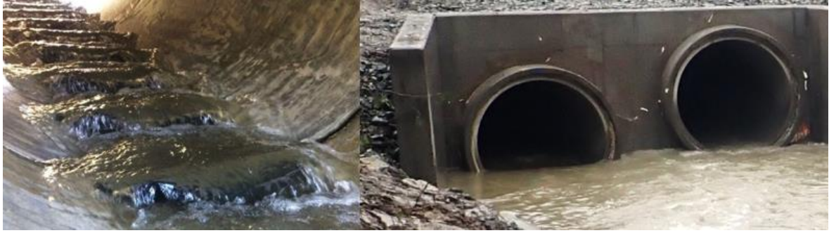
Figur 2. Eksempel på fleksiterskjer (t.v., hentet fra https://www.ats-environmental.com/solutions/culvert-baffles/ ), og ny dobbelkulvert i Sjøskogbekken etter nedlegging. Foto på høy vannføring høsten 2023. Foto: @Morten Andre Bergan
