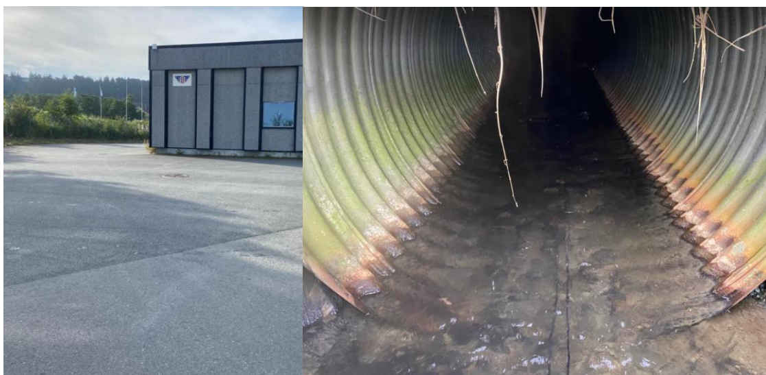
Figur 16. Bekkelukking av Sjøskogbekken opp mot E6 (t.v.) går i kulvert (t.h.) med uavklart vandringsvei for fisk. Foto fra befarings i 2023. Foto: @Morten Andre Bergan
