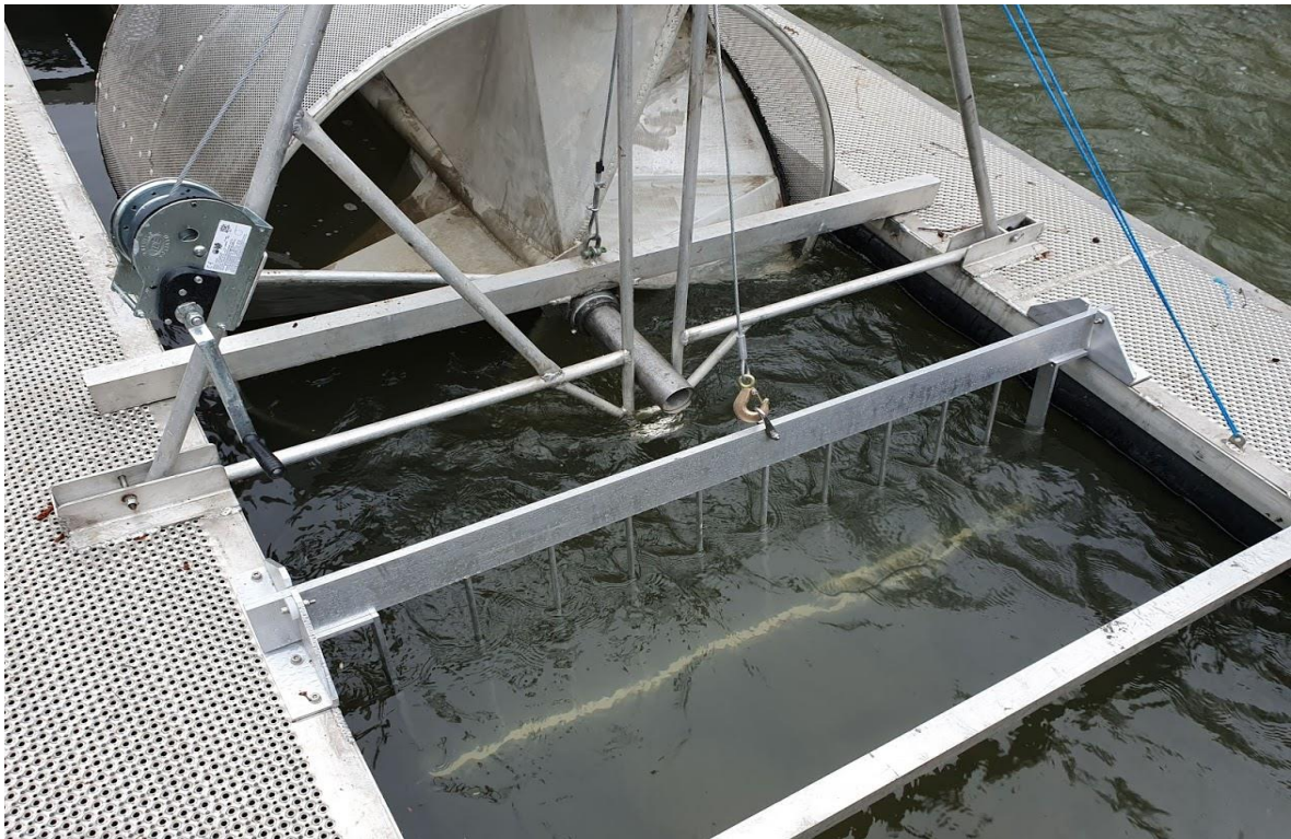
Vedleggsbilde 4. Rist som ble montert foran på smolthjulet for å hindre at bever ble fanget. Rista kan heises opp og renses ved vinsj som ses til venstre i bildet. Foto: Øyvind Solem, NINA.
