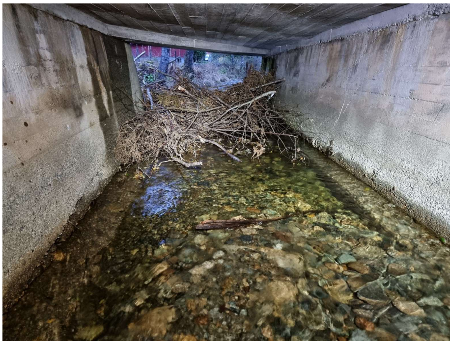
Figur 3.25 Kulvert under Suldalsvegen er i utgangspunktet godt tilpasset fiskevandring, men opphopning i kvist i kulvertinnløpet kan ha påvirket oppvandring høsten 2022.
