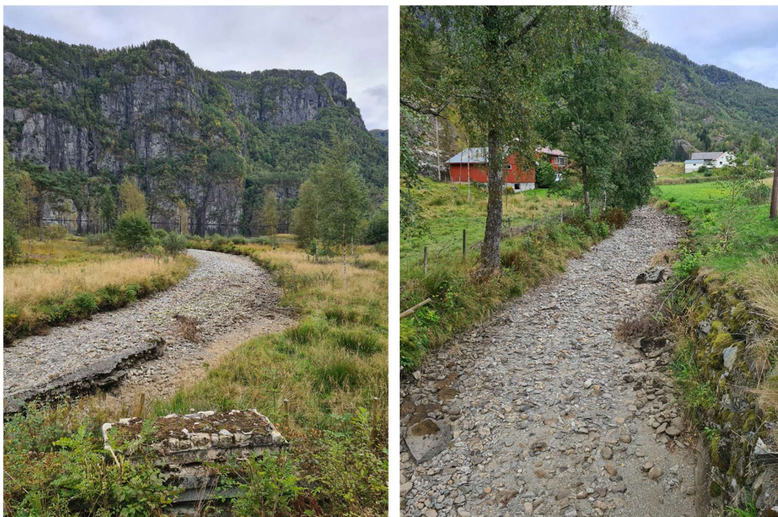
Figur 2.3 Det var planlagt strandnært elektrisk fiske i tilløpselva Veka, men denne var helt tørr i perioden 19. – 22. september 2022. Bildet viser Veka nedstrøms (venstre) og oppstrøms (høyre) kulvert under riksvei 13.
