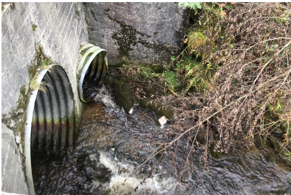
Figur 23. Ulsetbekken er rørlagt et godt stykke i nedre del, før den munner til Solembekken gjennom et rør ved vegkrysningen til Amundalsvegen. Foto fra 2017. Foto: @Morten André Bergan.
