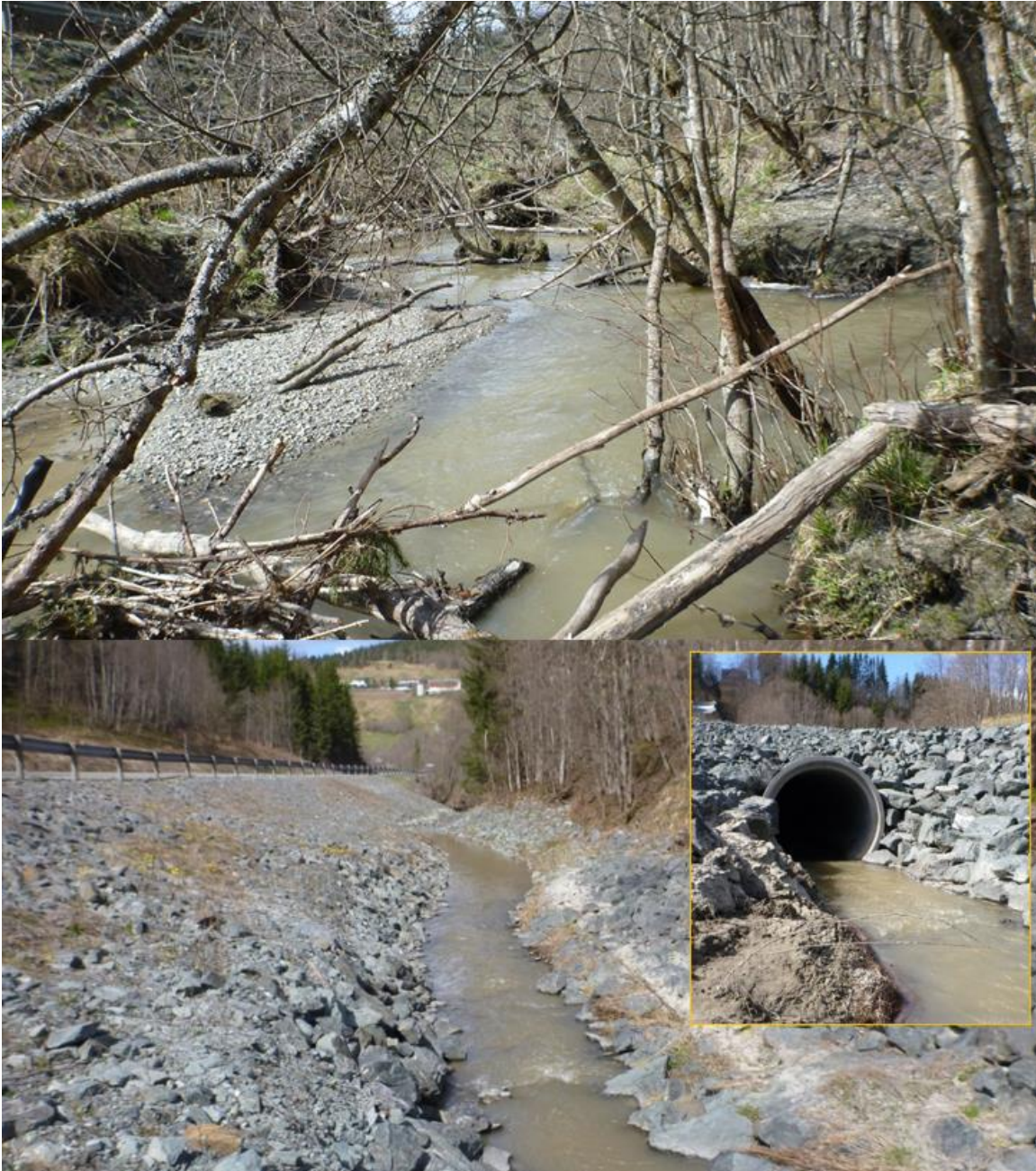
Figur 21. Solemsbekken i mai 2013. Store deler av Solemsbakkens strekninger var ikke påbegynt i sikringsarbeid (øverst), og man fikk ett innsyn i bekkens naturtilstand. Andre strekninger var ferdig sikret ifbm veiarbeid noen år tidligere (nederst), og etterlatt mer som en smal, monoton kanal med grovt substrat og skuttstein. I dag er hele denne nedre delen av Solemsbekken steinsatt, modifisert og endret, og bekken krysser både en veinær oppstillingsplass og Amundalsvegen gjennom rørformet betongkulvert (innfelt foto) på strekningen. Foto: @Morten André Bergan.
