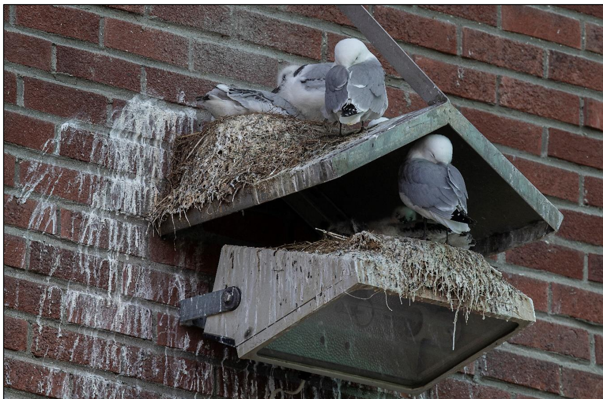
Figur 2.4. Mislykket tiltak for å hindre krykkjene å hekke på en lyskaster på Mack-bygningen. Dette fungerer faktisk mer som tilrettelegging da flere par hekket her. Karl-Otto Jacobsen©
