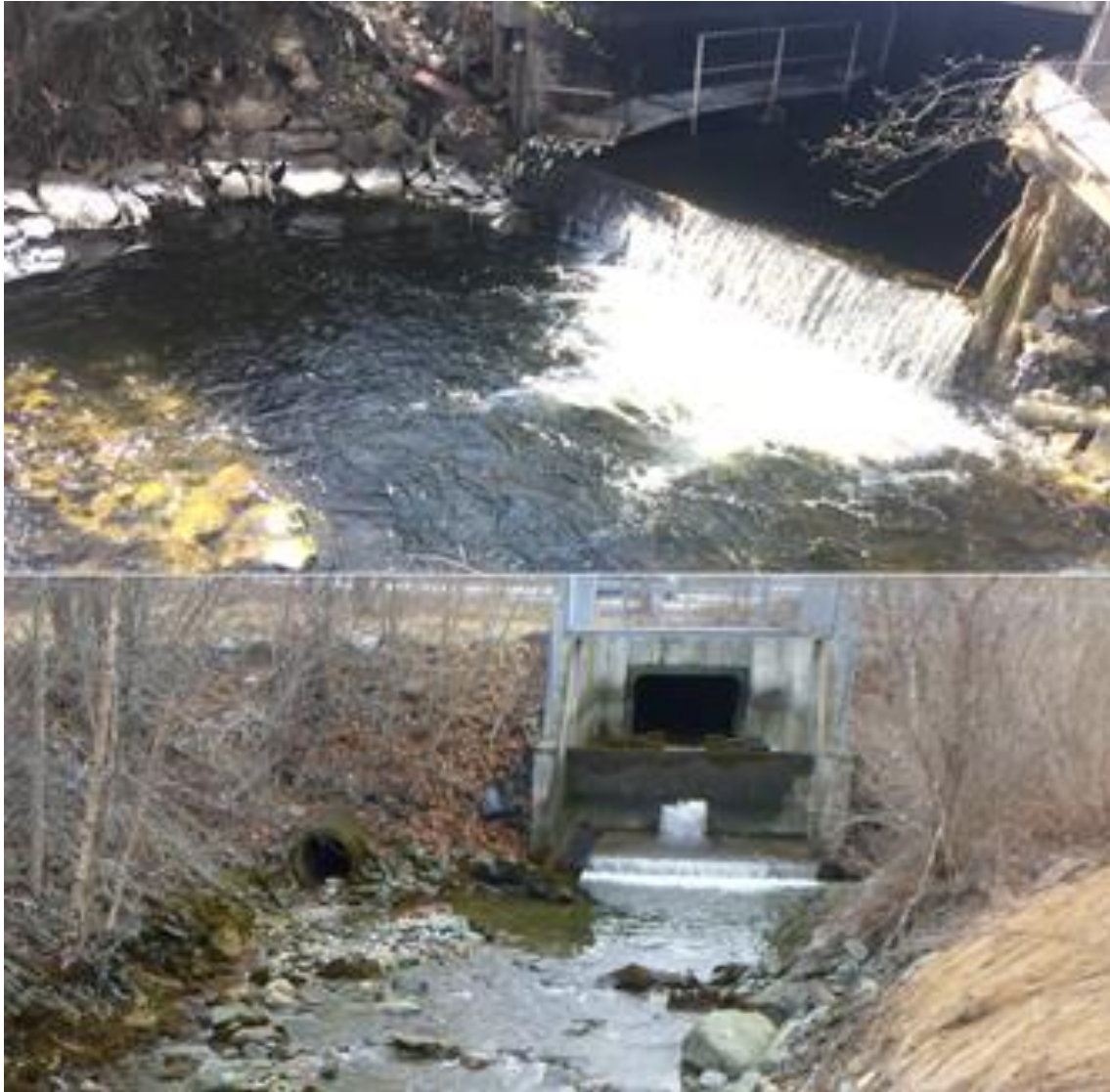
Figur 3. Øverst: I dag stoppes fisken trolig av lukkingen i forbindelse med fabrikkområdet for papirfabrikken. Nederst: Veikulvert under veianlegget for E6 og tidligere Fv 950 (foto nedstrøms vei) er umulig å forsere både for ål og laksefisk. Foto: @ Morten André Bergan.
