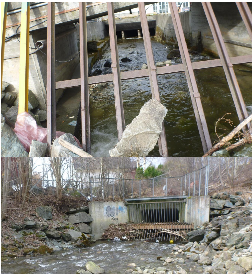
Figur 4. Øverst: Lukkingen i forbindelse med fabrikkområdet til papirfabrikken. Foto nedover elva i fabrikkområdet. Nederst: Vikelva går inn i lang lukking under veianlegget E6/FV 950. Foto oppstrøms vei. Foto: @Morten André Bergan.
