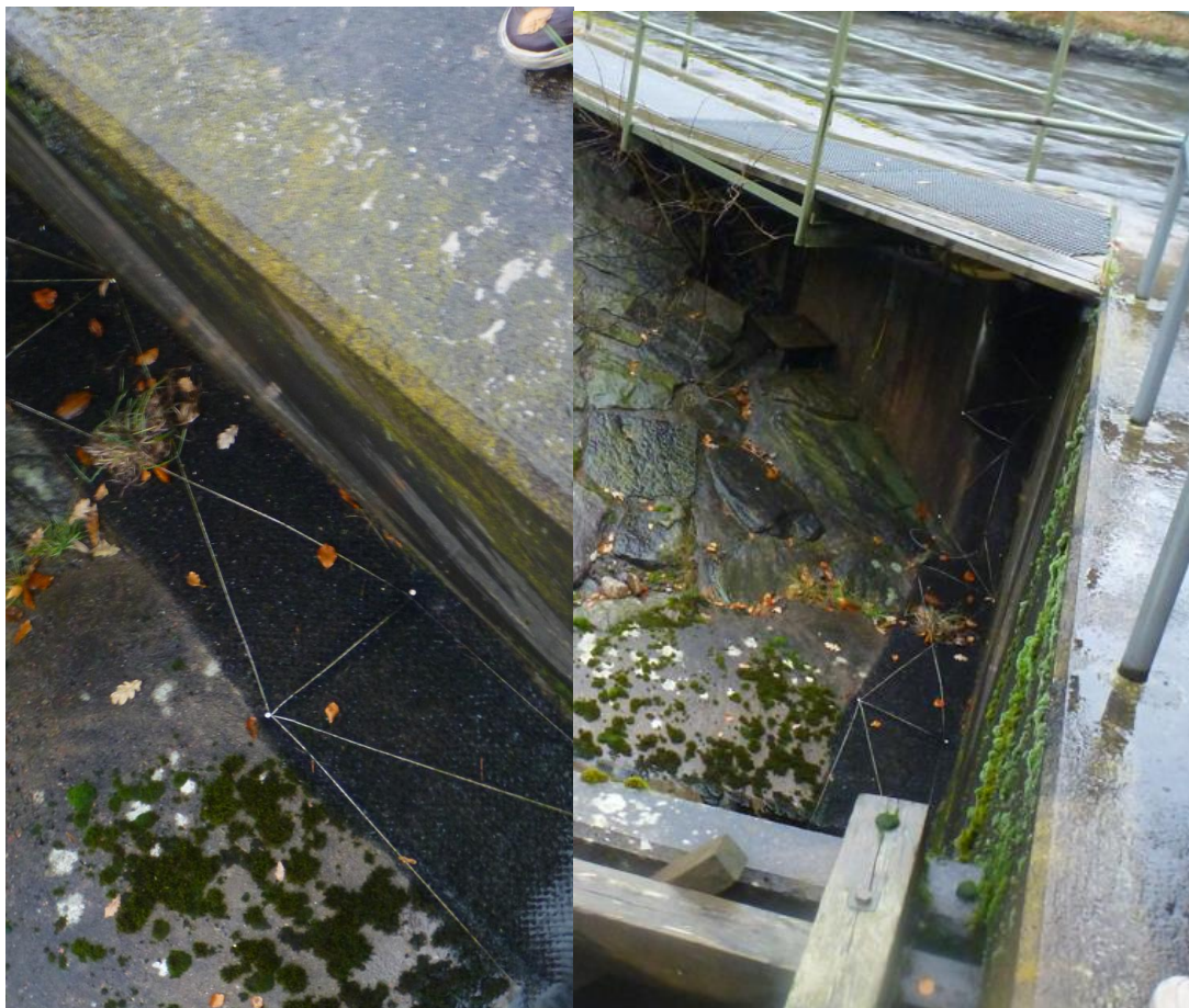
Figur 49. Nettingmatter montert for å gi små ål/ålefaringer gi mulighet til passering forbi demning i et vassdrag i Sverige. Løsningen synes aktuell for Vikelva under papirfabrikken og for kulverten under E6. Foto: ©Morten André Bergan, NINA.
