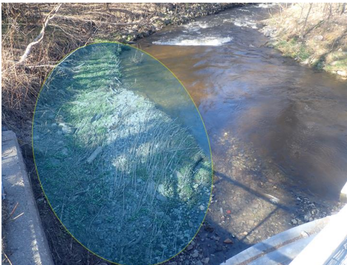
Figur 28. Sedimentert stein- og sandsubstrat i kulp nedstrøms kulverten. Utviklingen har skjedd over mange år. Dette har etter hvert innsnevret kulpen, og dannet begrodd elvekant. Massen (rund sirkel) foreslås å traues ut, og den naturlige elvesteinen legges tilbake i elva på strykstrekninger nedstrøms. Foto: @Morten Bergan.
