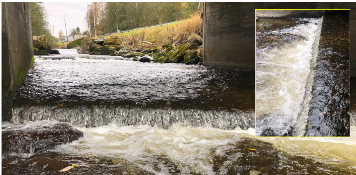
Figur 6. Betongbunn og terskler i tilknytning til bru for tidligere påkjøringsrampe fra E6. Foto nedenfra og oppover i 2019, på over middels vannføring i Leirelva. I bakgrunnen skimtes vannmålerstasjonen (betongkonstruksjon) omtalt i avsnitt 2.1.2 . Foto: @Morten Bergan.
