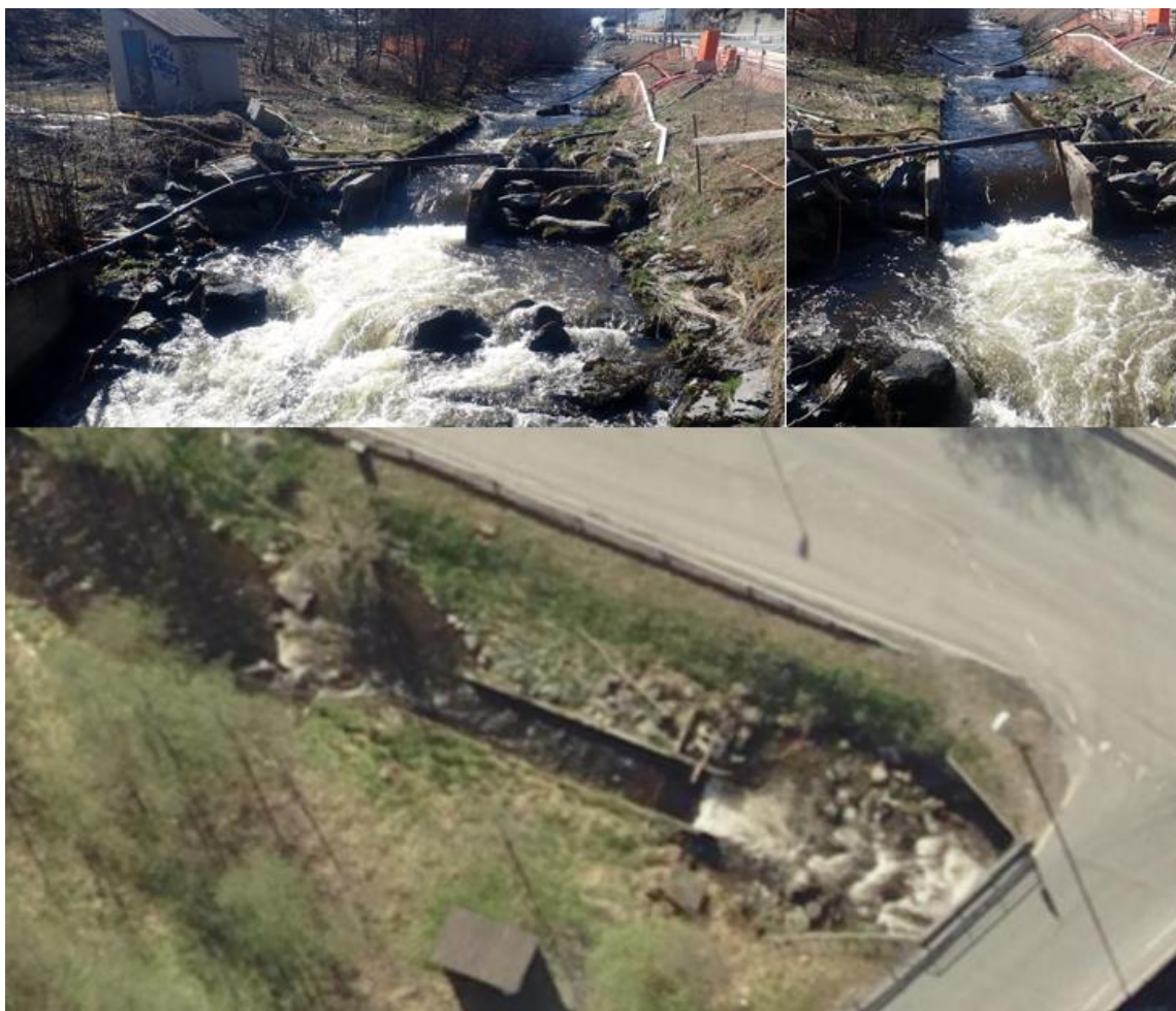
Figur 7. Øverst: Foto av betonginngrepet fra april 2022. Høy vannføring i Leirelva som følge av snøsmelting i Bymarka. Nederst: Flyfoto over partiet (2016). Flyfoto: https://kart.finn.no/ . Foto: @Morten Bergan.
