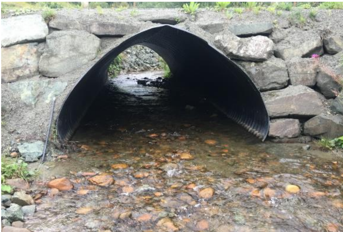
Figur 15. Den nye kulverten i Loa under Lebergsveien har bevart elvebunn og tilnærmet naturlig elvebredde, i en konstruksjon som har vist seg å tåle dagens flom og isgangsforhold i vassdraget. Foto: @Morten Bergan.
