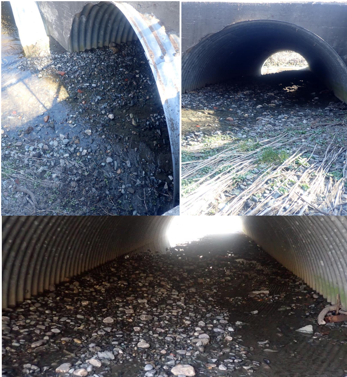
Figur 26. Tilnærmet tørrlagt elveløp og sedimentert stein- og sandsubstrat i venstre kulvert samtidig som Leirelva går på høy vannføring. Foto tatt nedstrøms kulverten i april 2022. Utviklingen har skjedd over mange år. Foto: @Morten Bergan.
