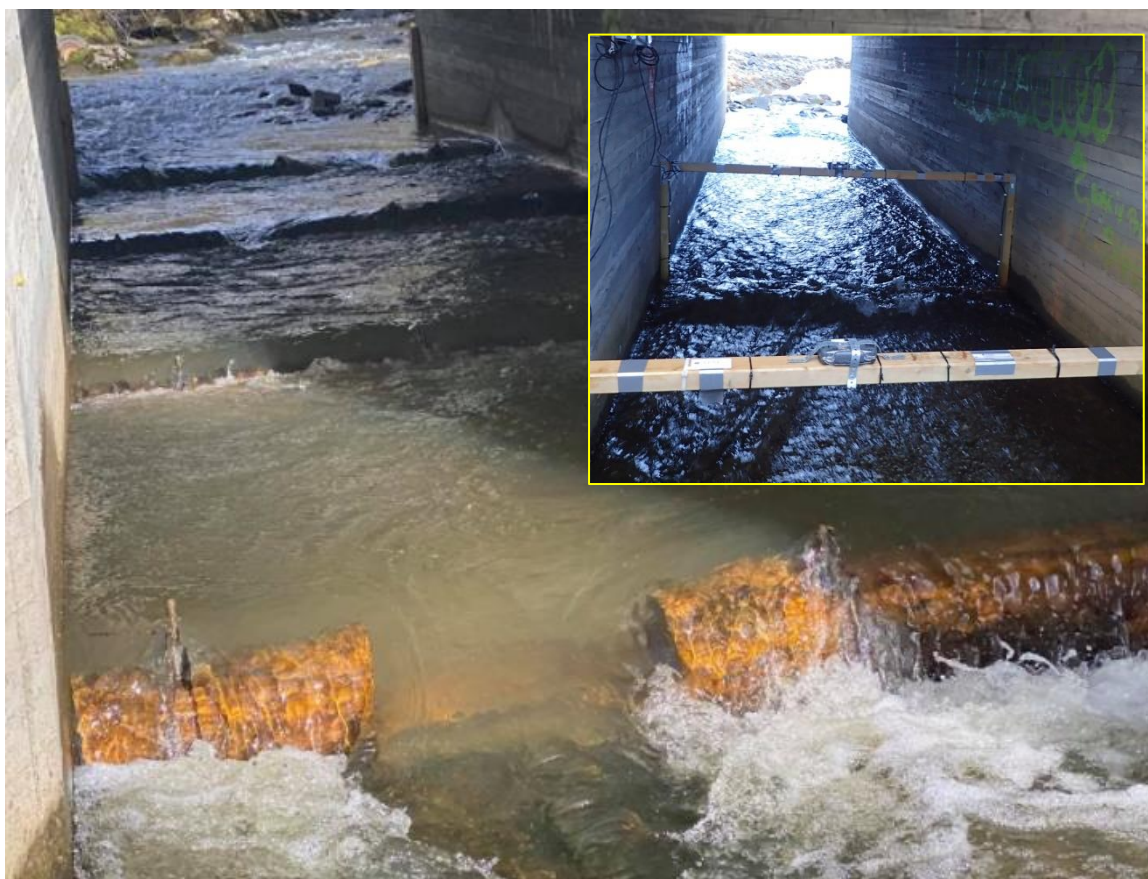
Figur 41. Stort bilde: Fastmonterte buner på flat betongkulvert under Fv 707 i Klefstadbekken er et fungerende eksempel til etterfølgelse for kulvert under avkjøring til Romolslia i Leirelva. Innfelt bilde: Status før tiltak. Foto: @Morten Bergan, NINA, @Aslak Sjursen, NTNU Vitenskapsmuseet.
