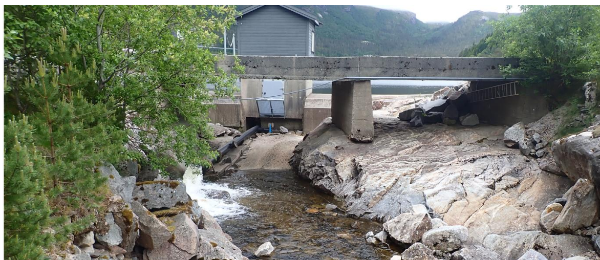
Figur 51. Foto tatt nedstrøms og oppover av demning uten overløp. Foto: ©Morten André Bergan, NINA.
