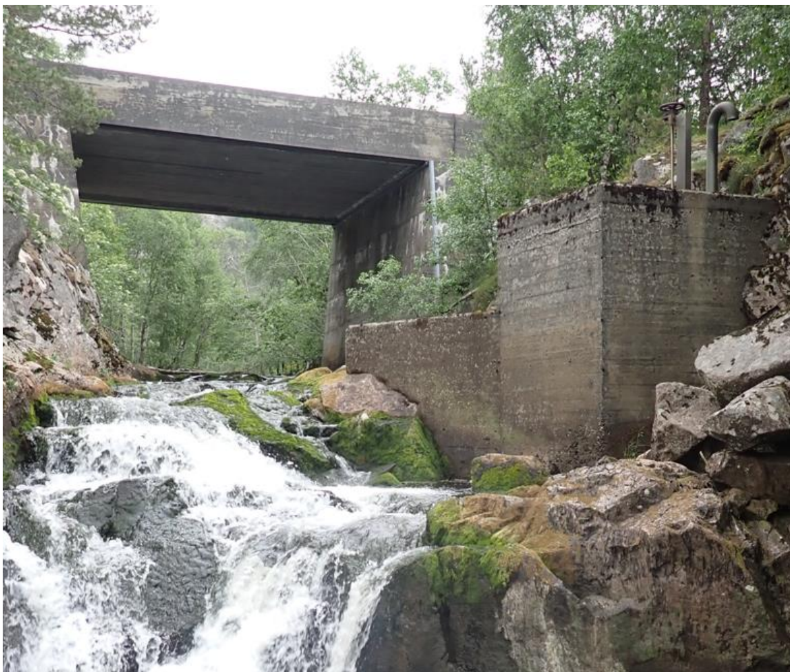
Figur 37. Betongkonstruksjonen midt i den nederste fossen i Slørdalselva kan ha gjort oppgangsforholdene for anadrom laksefisk vesentlig verre enn hva opprinnelig status skulle ha vært. Det er vanskelig å visualisere seg fossen uten betongkonstruksjonen, men den har i dag smalnet av elveløpet over fossen. Dersom denne konstruksjonen ikke har en viktig funksjon i dag, bør den vurderes fjernet. Foto: ©Morten André Bergan, NINA.
