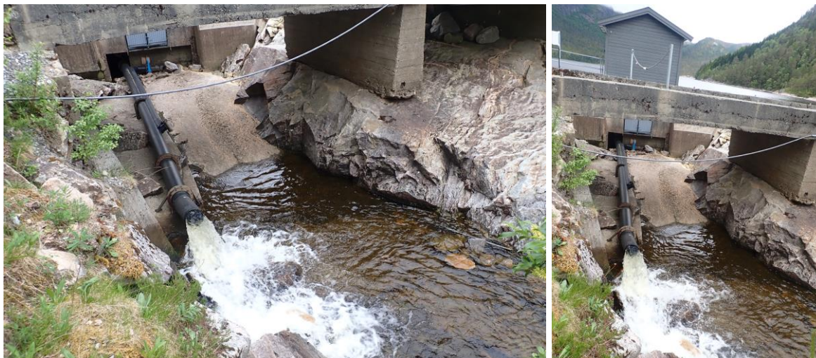
Figur 50. Tørrlagt demningsområde uten overløp, og tilsig av minstevannsføring gjennom et svevende rør med minimum 50 cm sprang. Foto: ©Morten André Bergan, NINA.
