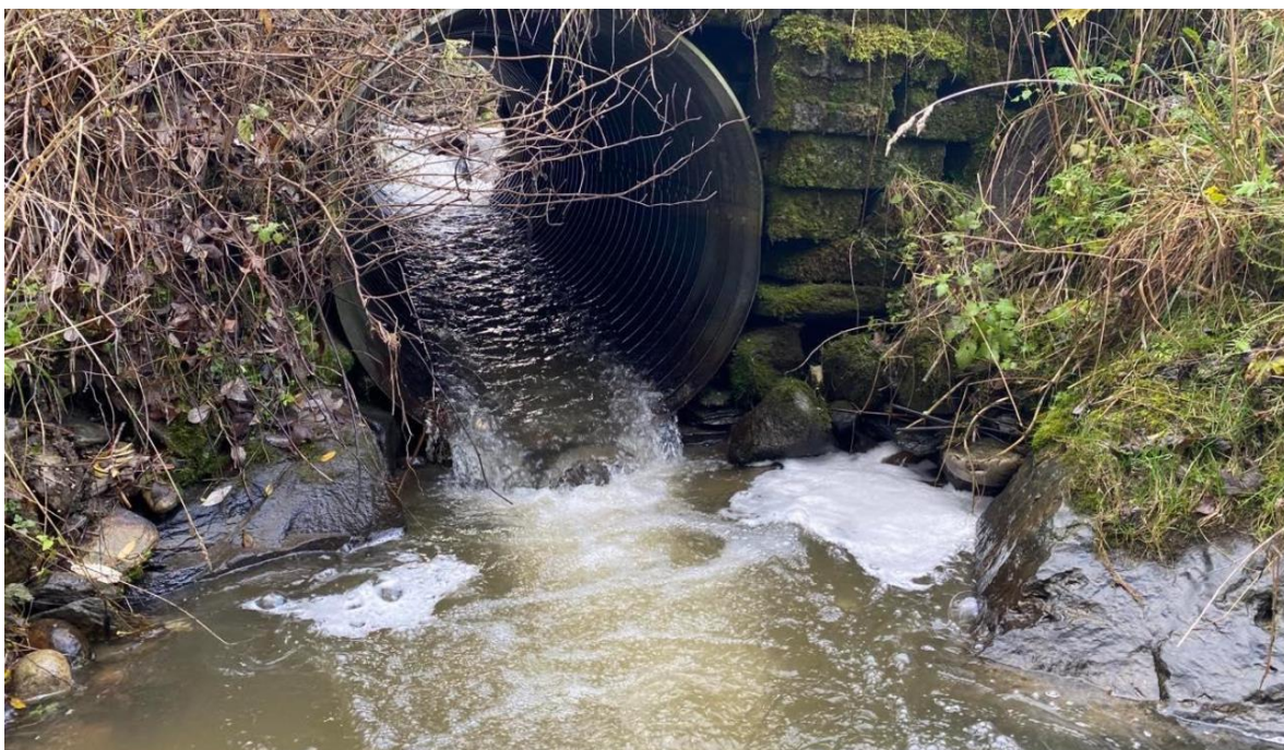
Foto 2: Første kulvert under nederste private bilvei i sidebekk til Kaldvella. Punkt 2 i kart 2. Foto: NINA.
