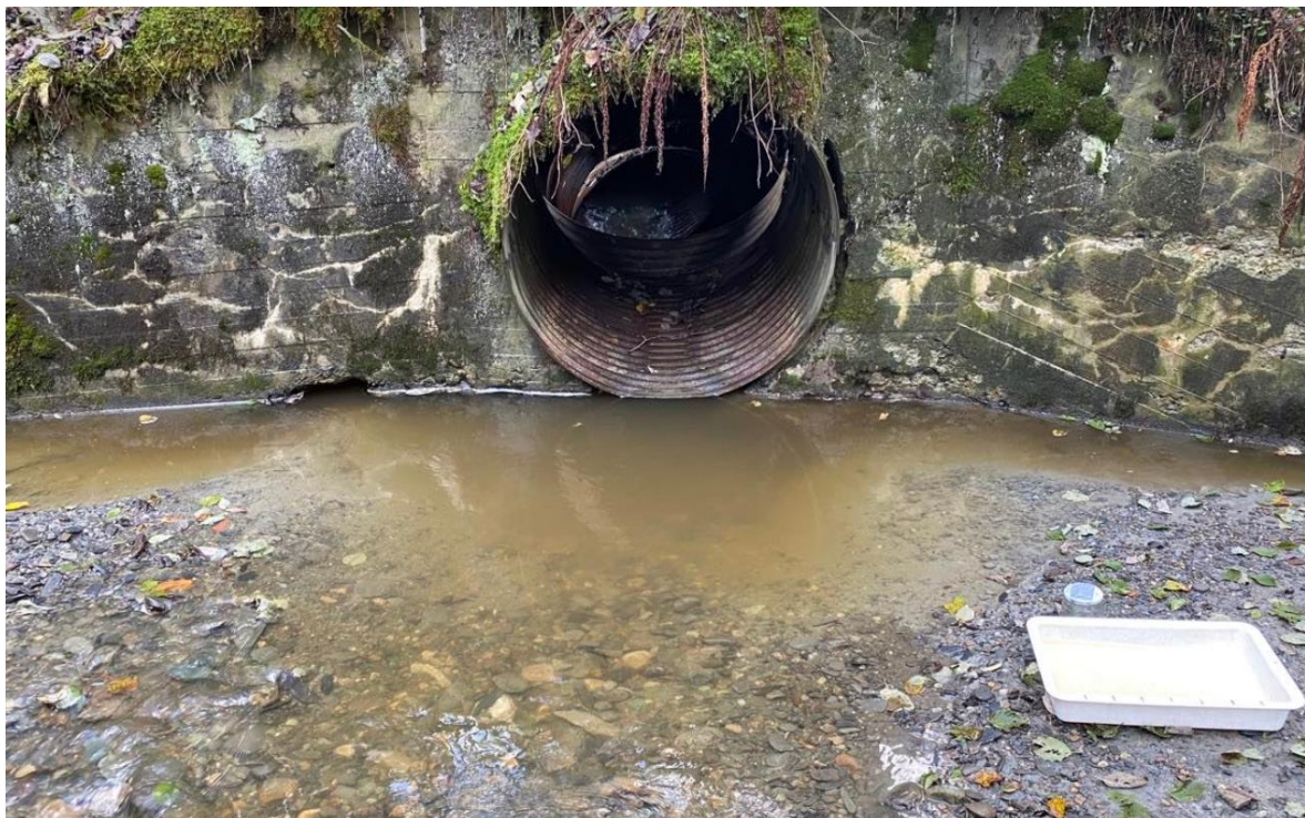
Foto 10: Kollapset kulvert under Langlandsvegen. Punkt 10 i kart 3. Foto: NINA.
