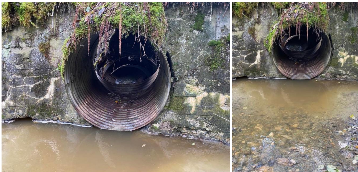
Figur 22. Underdimensjonert og kollapset veikulvert under Langlandsvegen. Foto: NINA.
