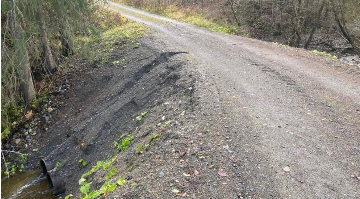
Foto 12: Kryssende grusvei og nedstrøms kulvertutløp. Punkt 12 i kart 4. Foto: NINA.
