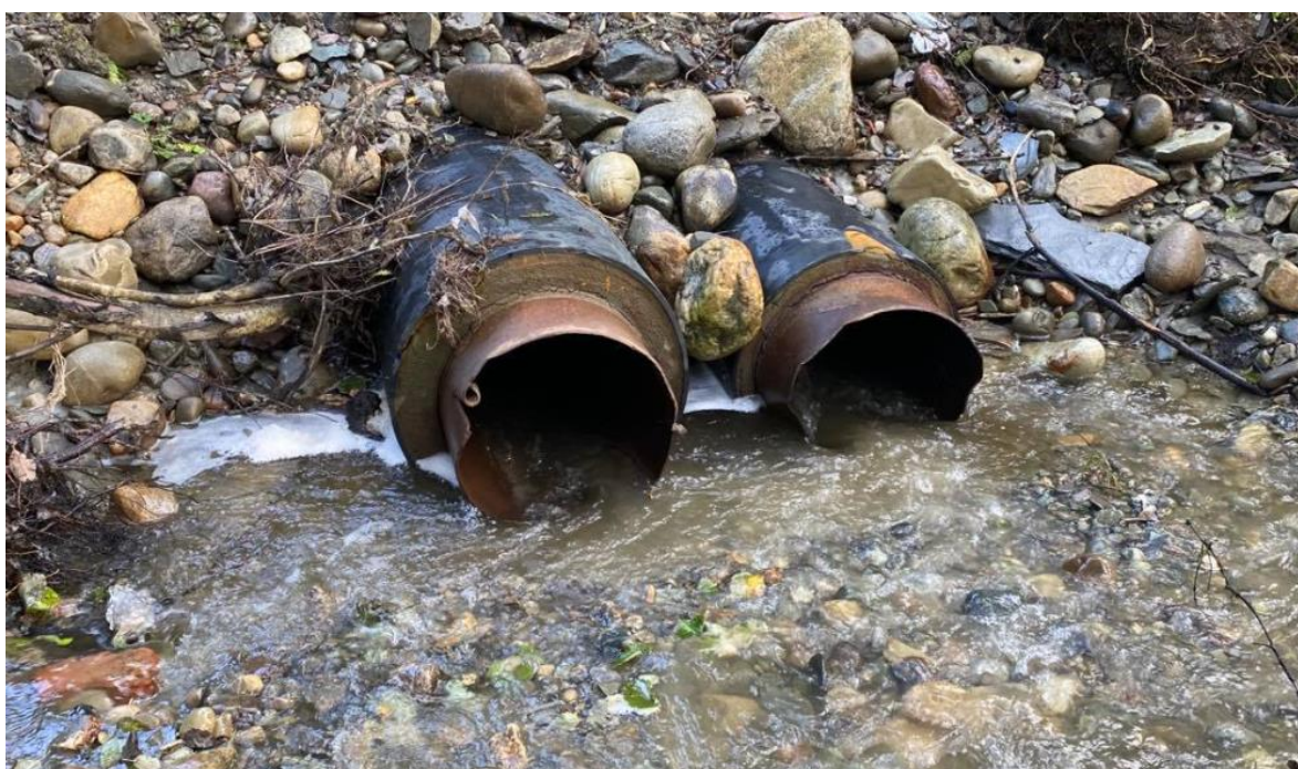
Figur 23. Underdimensjonerte rør utgjør veikulvert under privat vei ovenfor Langlandsvegen. Foto: NINA.
