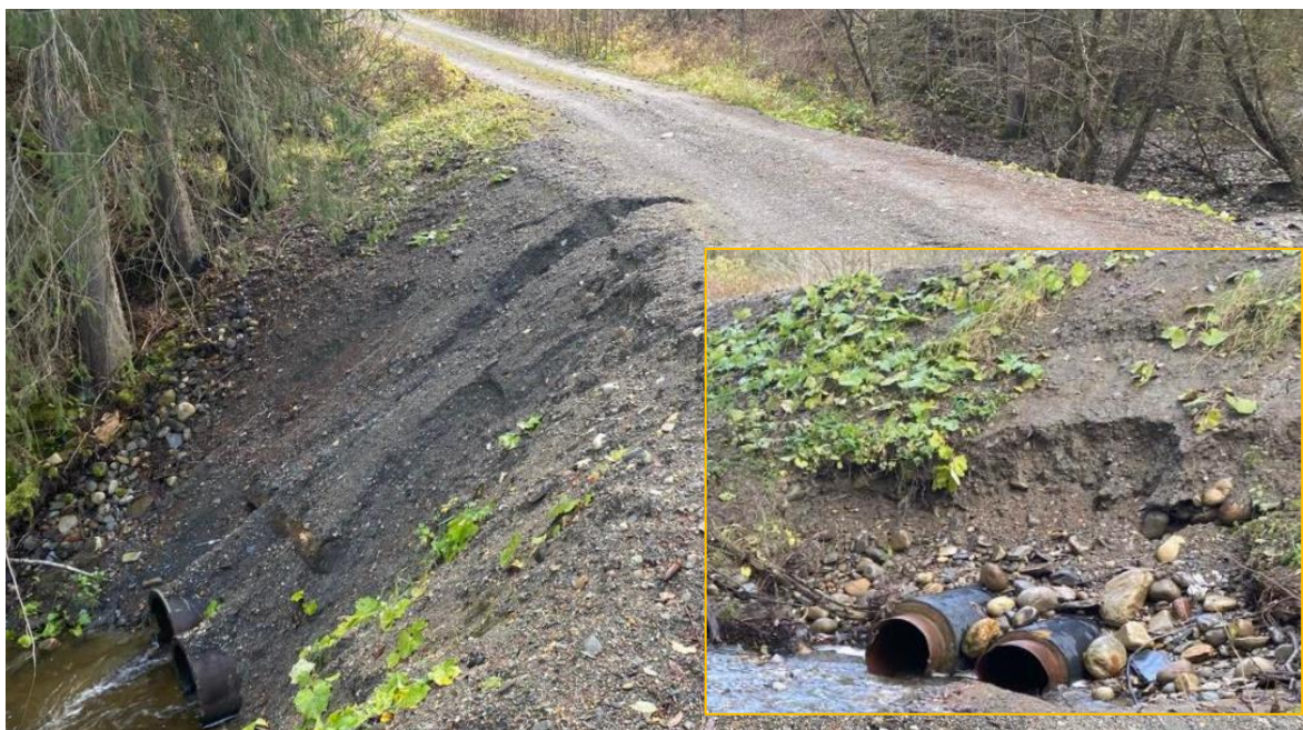
Figur 20. Stor risiko for økt partikkelforurensning, spesielt ved flom, knyttet til veikrysning i øvre del av sidebekken. Innfelt foto er overside av veien. Foto: NINA.
