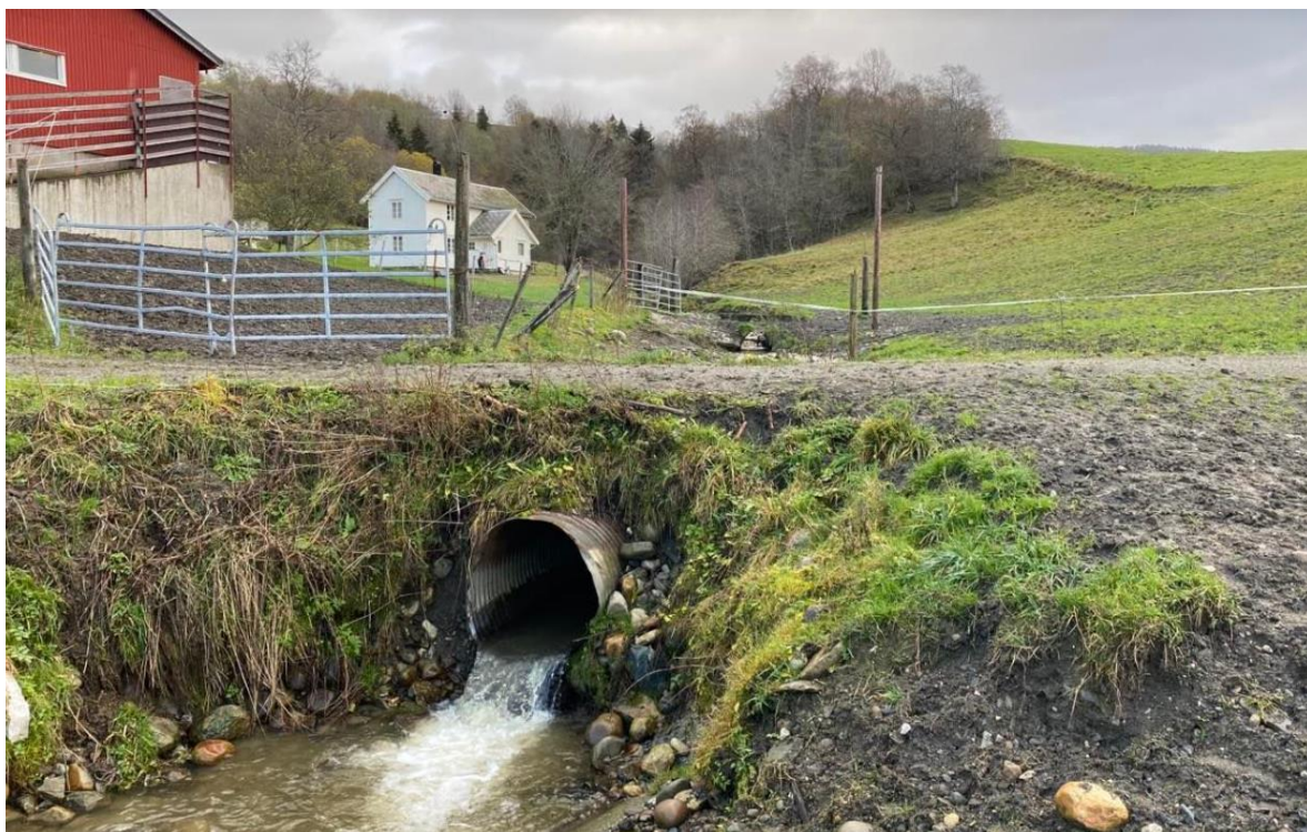
Foto 5: Andre veikulvert under andre veikrysning (traktorvei) i sidebekk til Kaldvella. Tredje veikulvert skimtes i bakgrunnen. Punkt 5 i kart 2. Foto: NINA.
