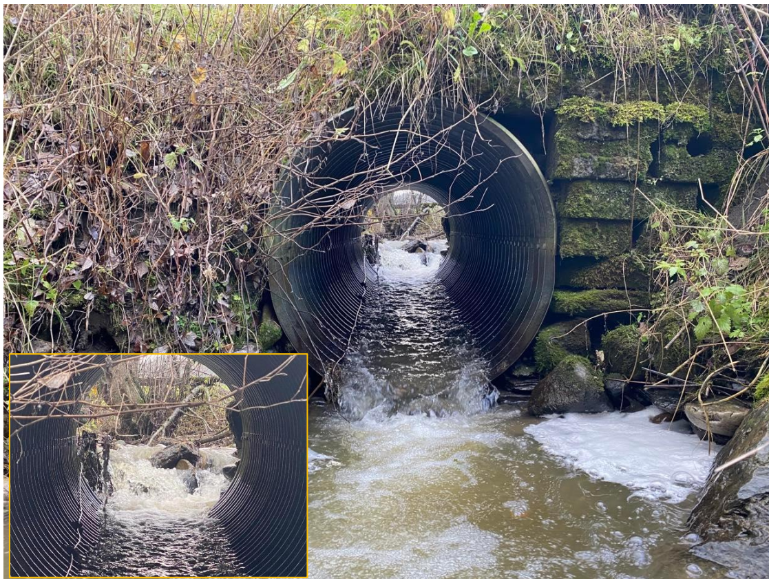
Figur 17. Nedre vegkryssning i kulvert er vandringshindrende for fisk, men kan trolig passeres på optimal vannføring. Foto: NINA.
