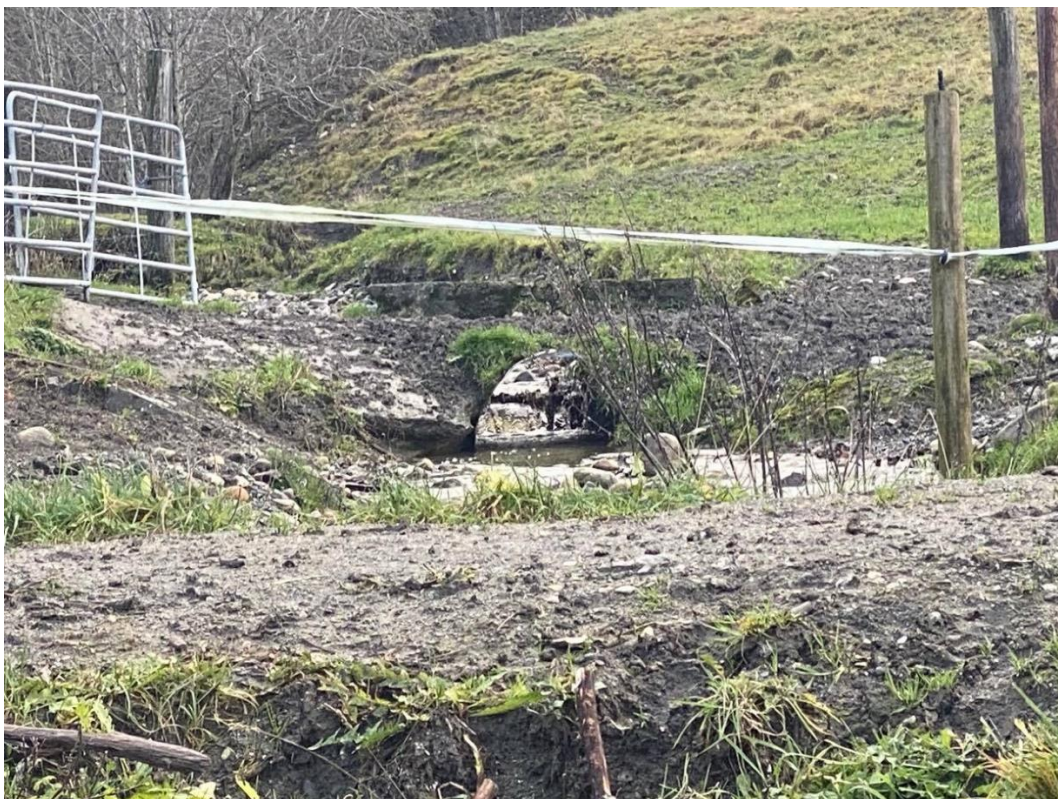
Figur 16. Kvegtråkk i og ved bekkens i nedre del, i tillegg til flere kulvertkryssninger (se figur 17 og 18). Foto: NINA.
