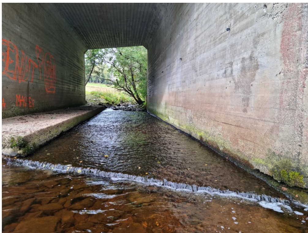
Bilde 16. Brustuelva passerer Namsosvegen gjennom en betongkulvert med flat bunn, omtrent 2,6 kilometer fra samløpet med Ferja. Fisk kan passere, men løsningen er dårlig og kan over tid ha negativ effekt på fiskebestander i bekken. Foto: Eva M. Ulvan, NINA.
