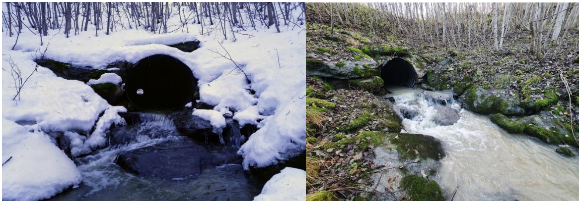
Bilde 11. Kulvert under Valsetvegen høsten 2019 (venstre) og høsten 2021 (høyre). Inngang til kulverten skimtes som et lys i enden av røret på venstre bilde. Foto: Øyvind Solem, NINA.
