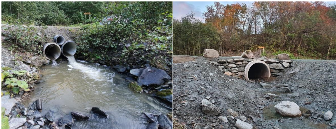
Bilde 3. Venstre bilde viser kulvert i form av tre rør under tursti ca. ti meter oppstrøms der Valsetbekken renner ut i Vigda høsten 2019. Kulverten var et klart vandringshinder for anadrom laksefisk. Høyre bilde er fra en periode med lav vannføring høsten 2020 og etter at det ble satt inn ny kulvert samme høst. Den nye kulverten er større, senket ned og har naturlig bekkebunn, noe som letter oppvandring for fisk. Foto: Øyvind Solem, NINA.
