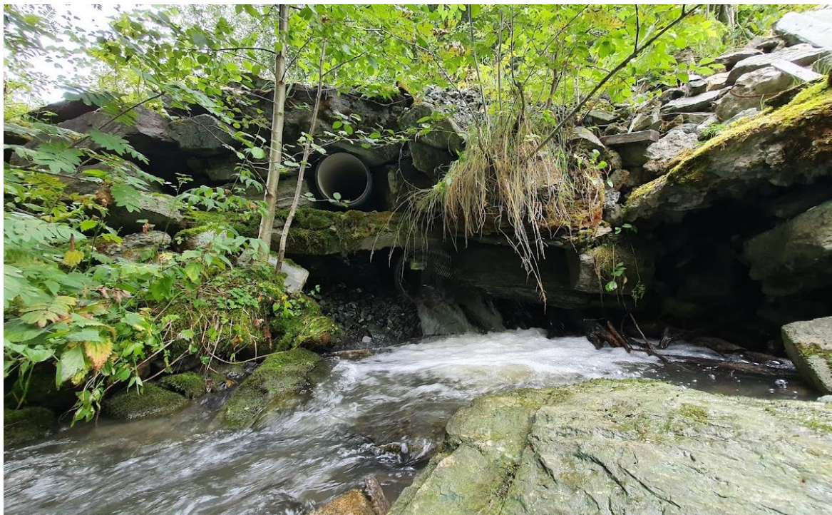
Bilde 5. Kulvert under avlingsvei i nedre deler av Kjølvassbekken høsten 2021 utgjør en kunstig vandringsbarriere for anadrom laksefisk. Foto: Øyvind Solem, NINA.
