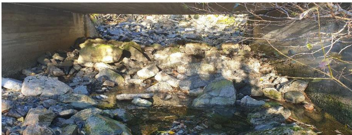
Bilde 104. Skrøvsetelva manglet vannspeil frem til vegkrysningen, 30 meter oppstrøms utløpet til sjø.
