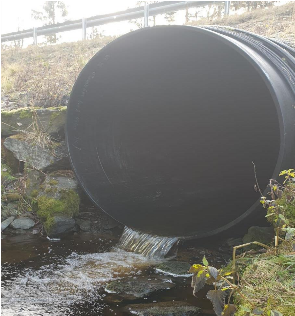
Bilde 84. Kulvert under E39 som er passerbar for fisk.
