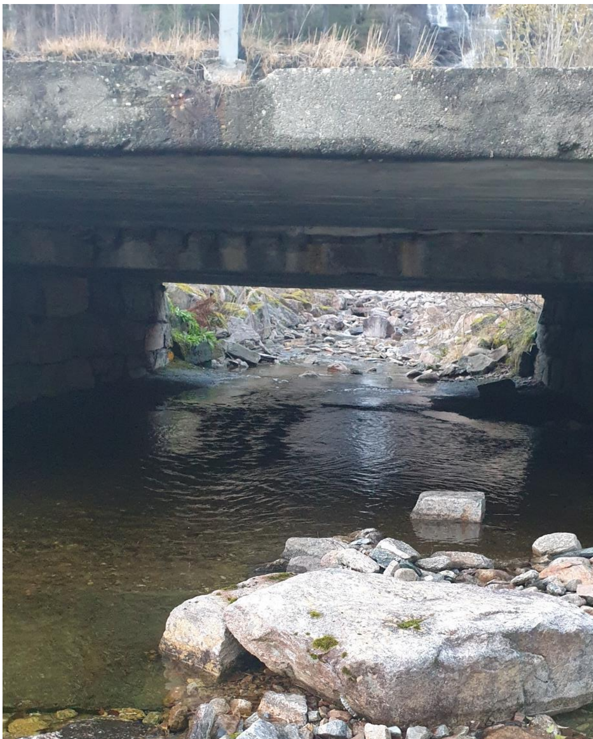
Bilde 112. Ørabekken sett oppstrøms mot vandringsbarriere rett ovenfor riksveg 65.
