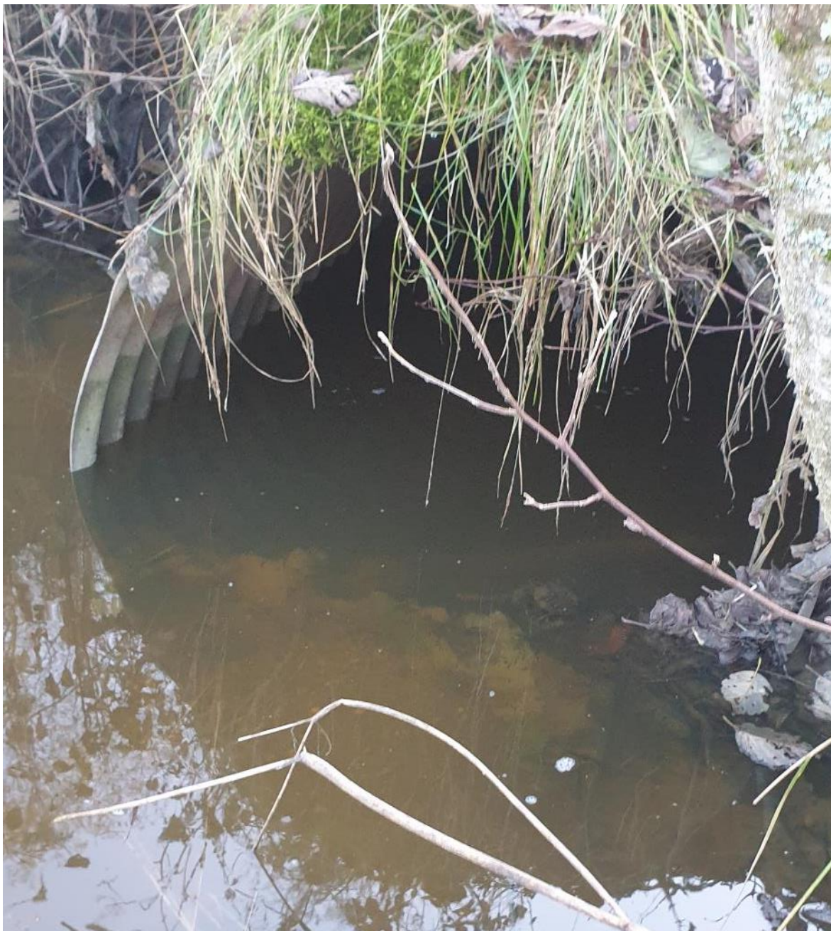
Bilde 83. Sidebekk med kollapset kulvert under vegkrysning i utløpet til Vågåa om lag 70 meter fra utløpet i Reitvågen.
