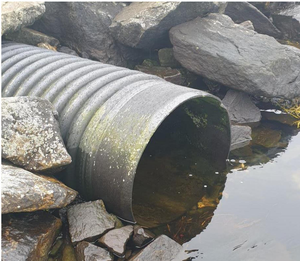
Bilde 36. Over 100 meter av bekken før utløpet til sjø i Otnesbukta. Bildet er tatt på flo sjø. Med unntak av utløpet er resterende rørgate i betong.
