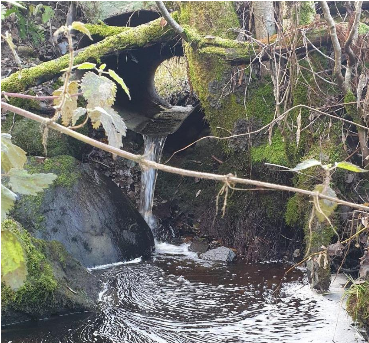
Bilde 82. Kulvert som sperrer for oppgang av fisk i sidebekk vest for der Vågåa krysser E39.
