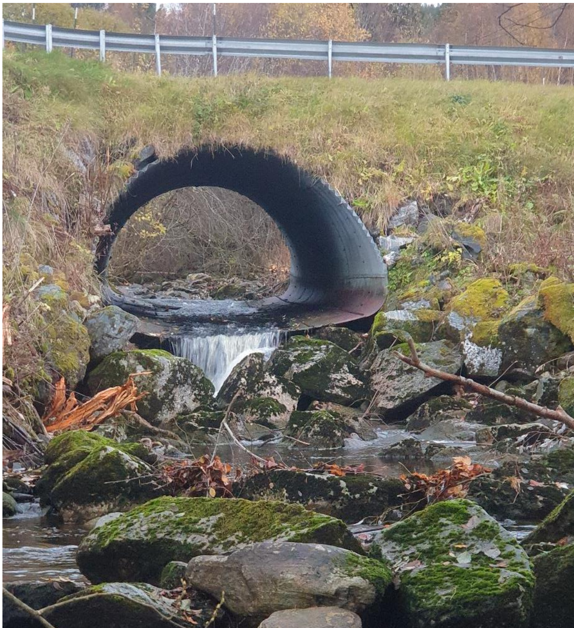
Bilde 19. Kulvert under E39 er vandringsbarriere for oppvandrende fisk fra sjøen. Plasseringen av kulverten i forhold til naturlig elvebunn er svært uheldig.
