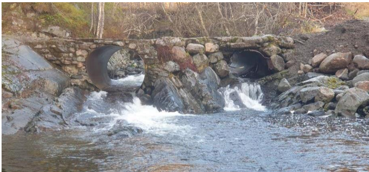
Bilde 109. Kulvert i hovedelva om lag 300 meter oppstrøms skytebanen.
