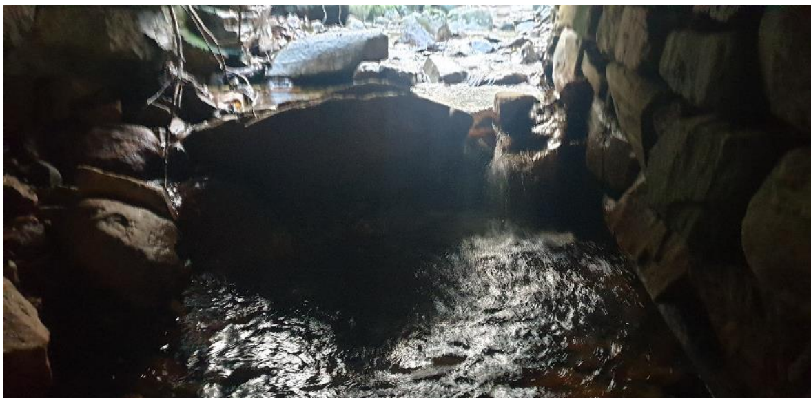
Bilde 7. Blokkstein inni kulvert som antas å være vandringshinder i Ytterbønbekken. På høye vannføringer kan fisk trolig passere dette punktet. Barriere ligger 140 meter ovenfor der bildet er tatt.
