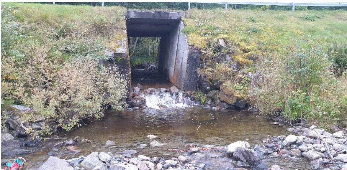
Bilde 41. Betongkulvert under E39 gir utfordrende oppvandringsforhold.
