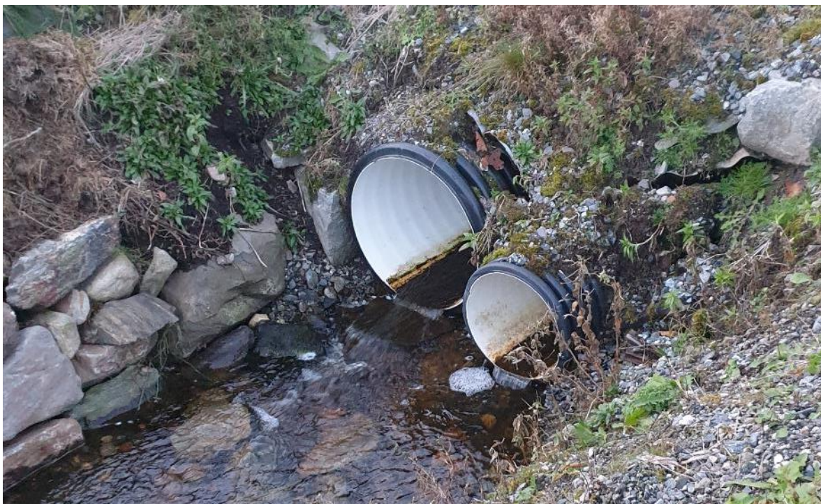
Bilde 75. Vegkryssing under Hamnavegen ovenfor anadrom barriere. Se for øvrig begroing inni rørene. Bekken har til tross for store sum-belastninger et svært egnet bunnsubstrat for både gyting (2-12 cm stein) og oppvekstareal (stein > 25 cm).
