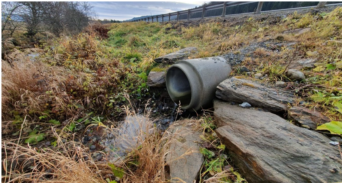
Bilde 4. Kulvert under Fv. 65, som fører en mindre bekk fra vest inn i Kjelbekken. Vannføring høsten 2019 var veldig lav, selv om det dagen før hadde regnet noe. Foto: Øyvind Solem, NINA.
