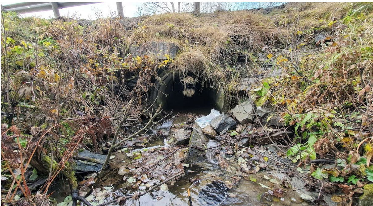
Bilde 6. Kulvert under Fv. 65 fremsto høsten 2019 som et vandringshinder på noen vannføringer, da det i nedre del var lagt opp en del stein i munningen. Innløp var delvis blokkert og skimtes så vidt gjennom røret. Foto: Øyvind Solem; NINA.
