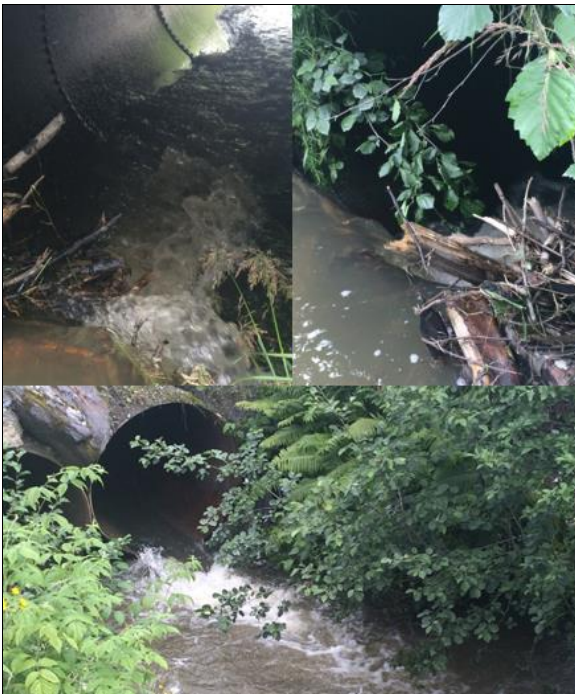
Figur 52. Problemkulvert i Hofstadelva, august 2015. Tilstoppet innløp (øverst), i tillegg til i utgangspunktet vanskelige oppgangsforhold med forhøyd vannhastighet for både stor gytefisk og små ungfisk. Forholdene ved veikrysningen ble vurdert som en vandringsbarriere i forkant av gytesesongen 2015 for laks og sjørret. Foto: Morten André Bergan, NINA.
