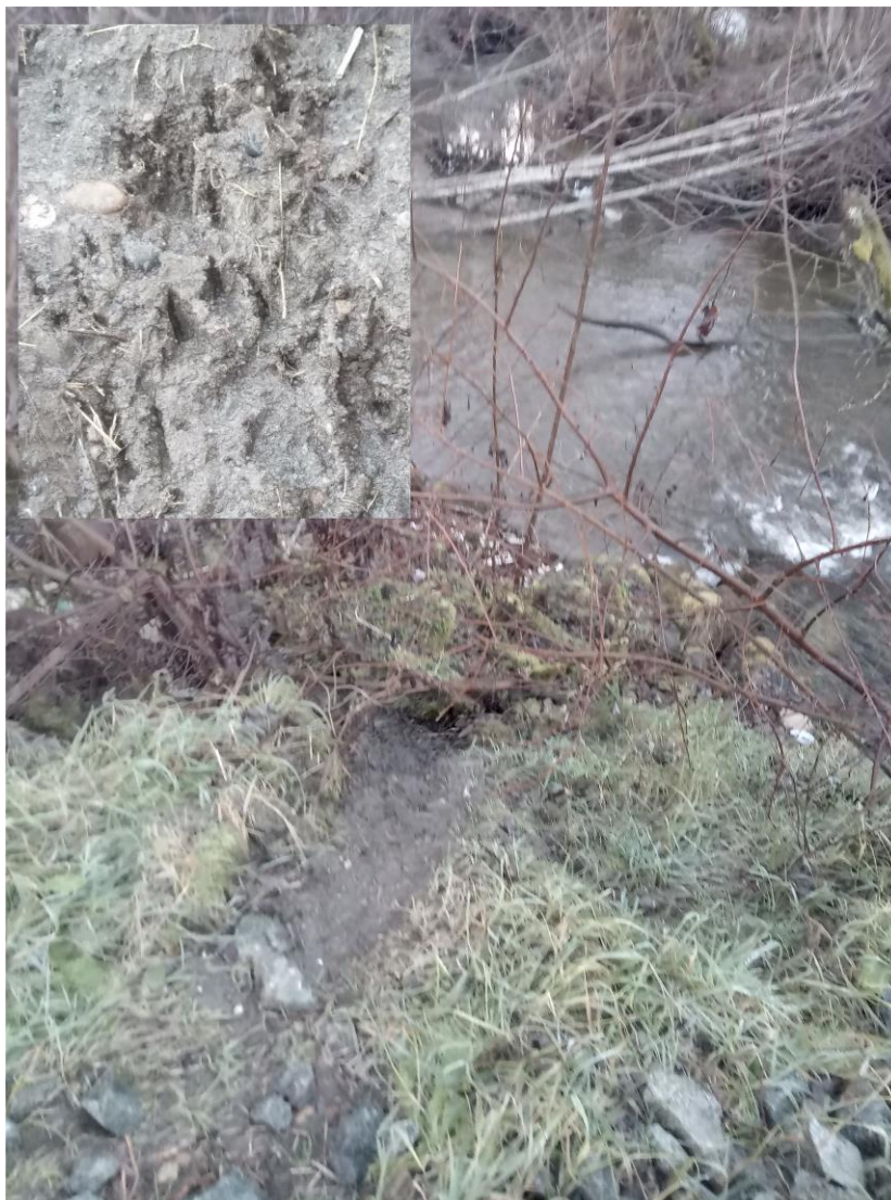
Figur 66. Bratt beversti forbi en kulvert og traktorvei over Egganbekken, litt nedstrøms fra den nedre demningen, 01.12.2020. Kulvertens utløp er ca. 1m over vannivået nedstrøms, noe som betyr at beverne ikke kan bruke den for ferdsel oppstrøms. Satt inn: ferske fotspor (framføtter) fra en bever som klatrer opp stien.
