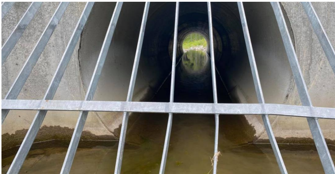
Figur 34. Kulvert under Sveanvegen i Storvollbekken. Foto: Morten Andre Bergan
