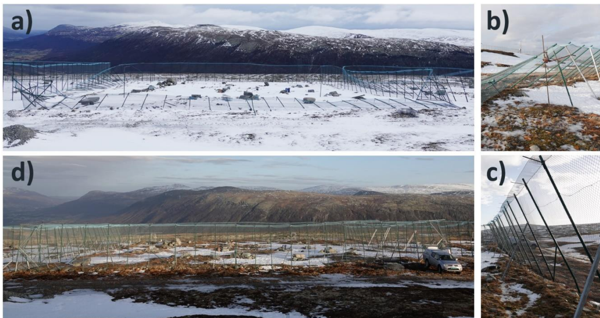
Figur 7. Hegn 5 etter stormen (a). Veggene ble jekket opp gradvis og metallstolper ble brukt for å støtte opp veggene (b – d). Foto: Avlsprogrammet, NINA.
