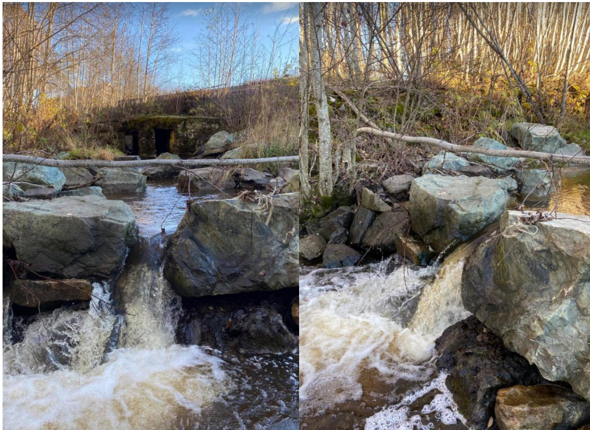
Figur 39. Åpningene i fisketrappa/terskelen nedstrøms jernbanen i Lynga er for smale i dag, og går lett tett. Dette gir forhøyd sprang nedstrøms, samt at det blir utfordrende for sjørreten å treffe den smale glippen i terskelen under gytevandringen. Foto: NINA.
