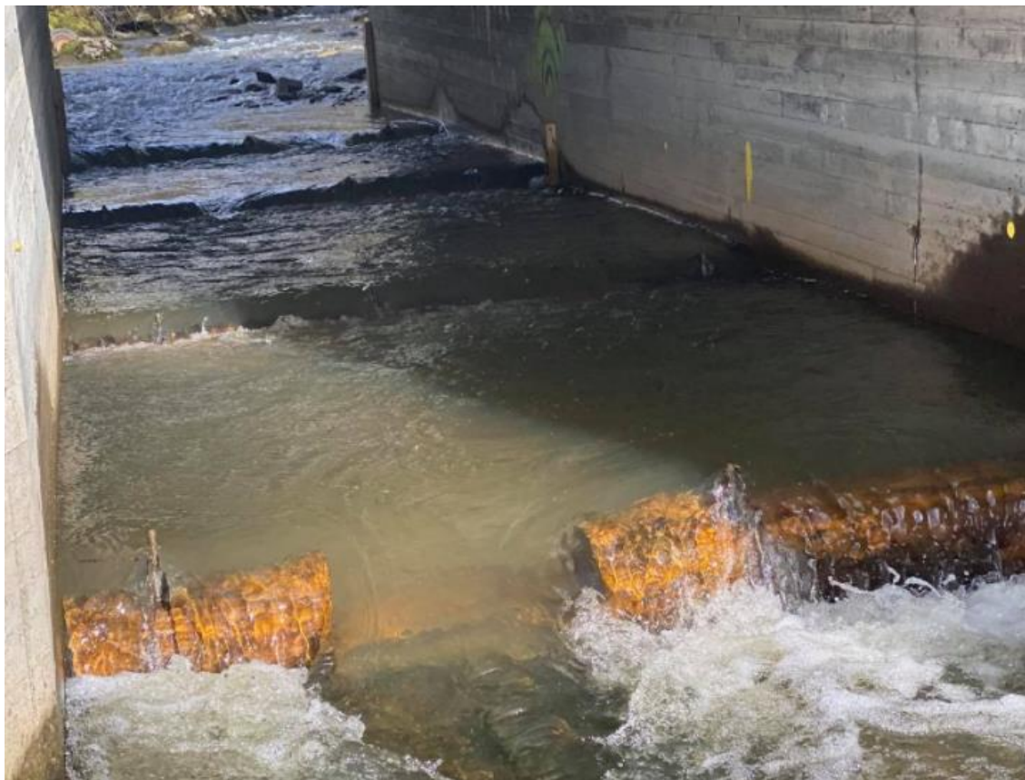
Figur 14. Fastmonterte buner på den flate betingkulverten under Fv 707 i Klefstadbekken er et eksempel til etterfølgelse for Ratbekkens stikkrenne under jernbane. Foto: NINA.
