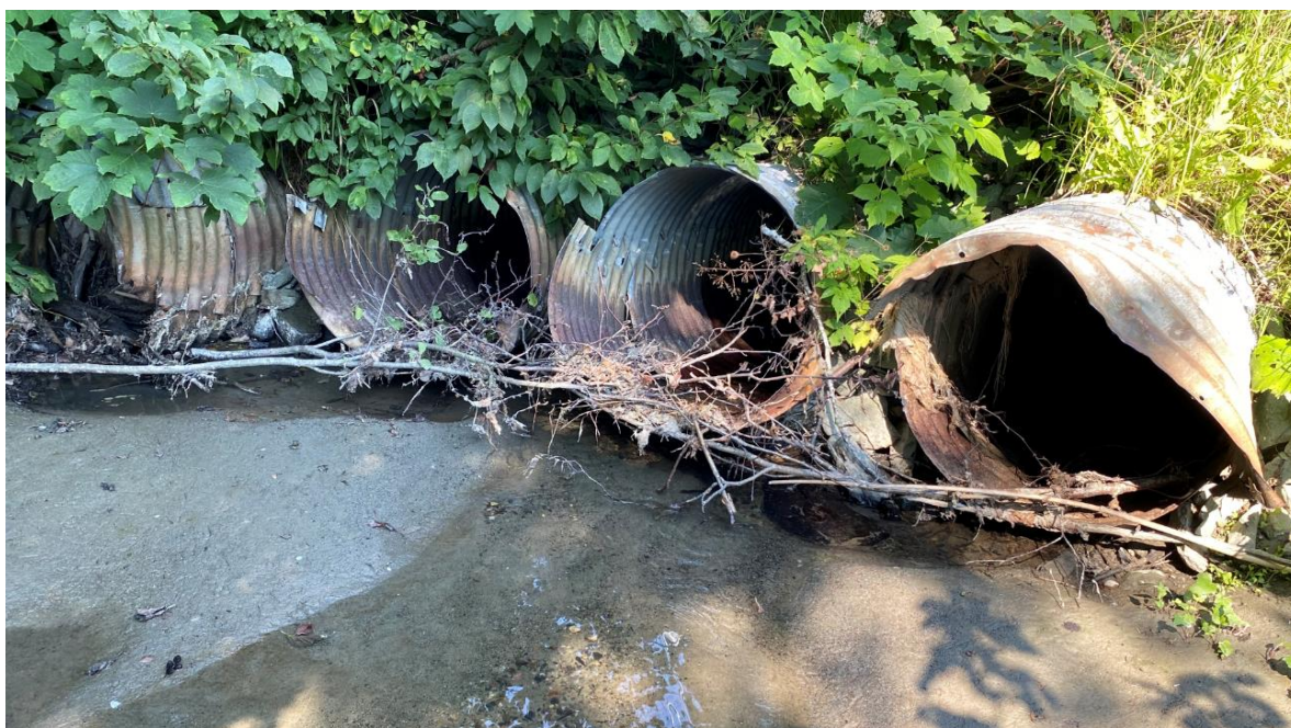
Figur 26. Utrangerte kulvertløsninger i Varmbubekken. Foto: NINA.
