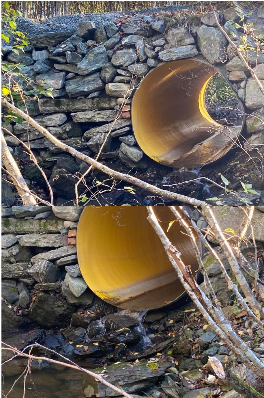
Figur 22. Ny kulvert under avlingsvei ved Haugen Gård er svært ugunstig utformet, og er ikke anlagt med hensyn til fiskens frie vandringer i Langbekken. Foto: NINA.
