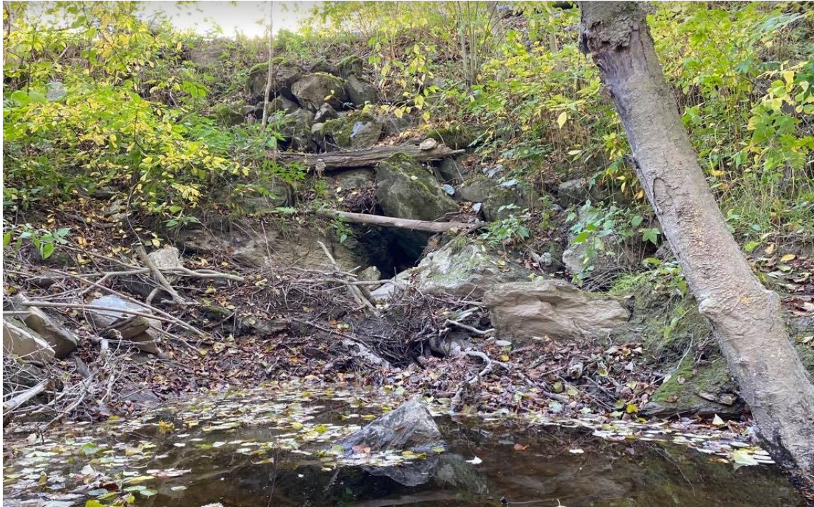
Figur 16. Overside av kulverten under Hjellhaugveien er dekt av utrast eller dumpet storstein, og har gått tett av dødt trevirke og kvist. Foto: NINA.
