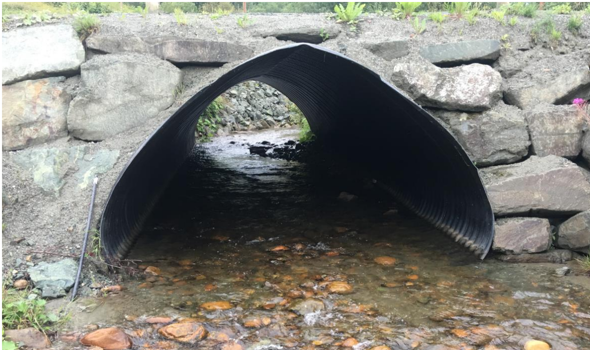
Figur 32. Den nye kulverten i Loa under Lebergsveien er et forbilledlig eksempel på en god løsning på krysning av vei over vassdrag. Foto: NINA.
