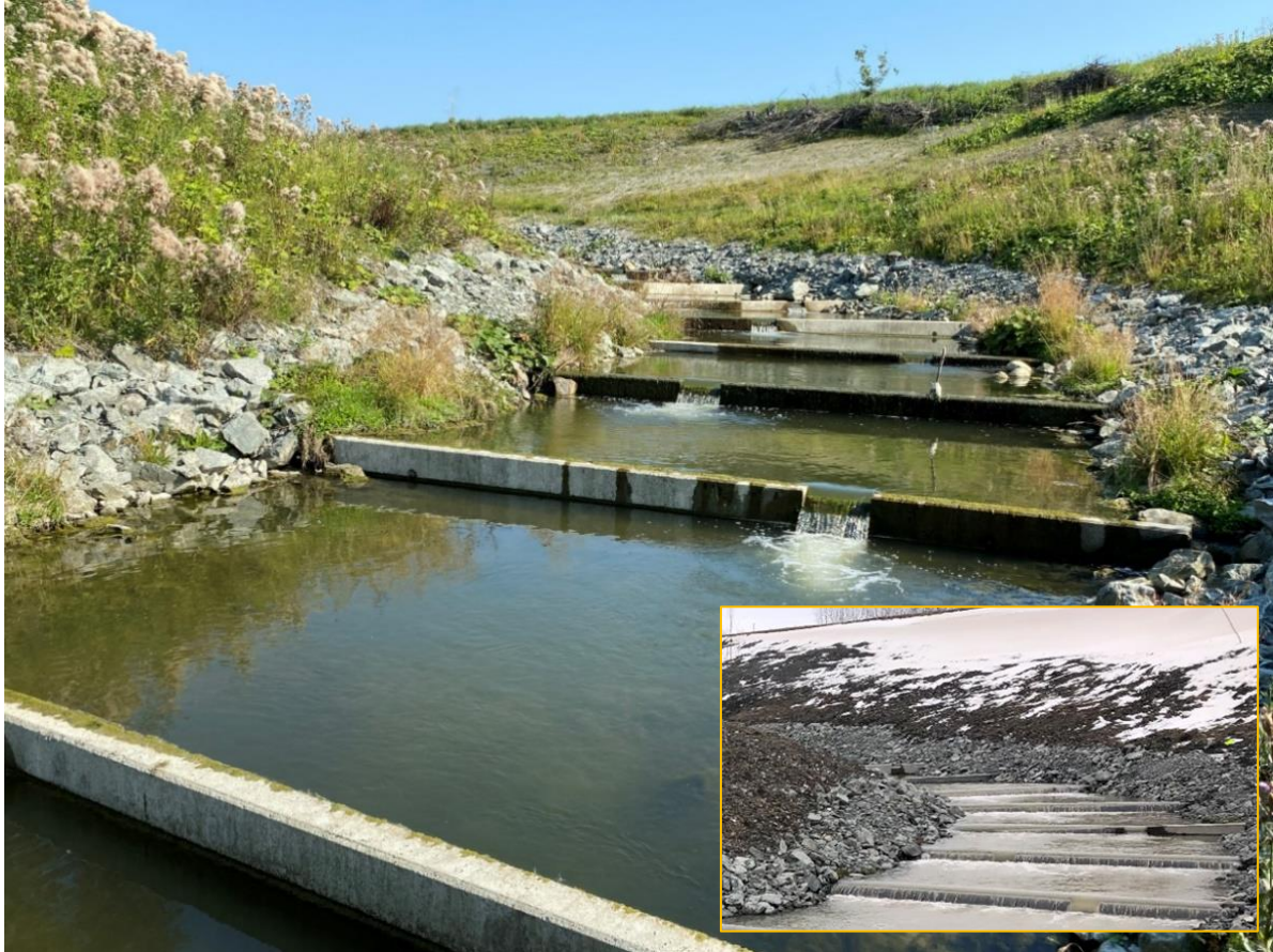
Figur 2. Terskler i Sørå ovenfor stasjonsområdet. Foto fra 2020, på lav vannføring. Innfelt: Samme bekkeparti i mars 2019, på høy vannføring og overløp i tersklene. Foto: NINA.
