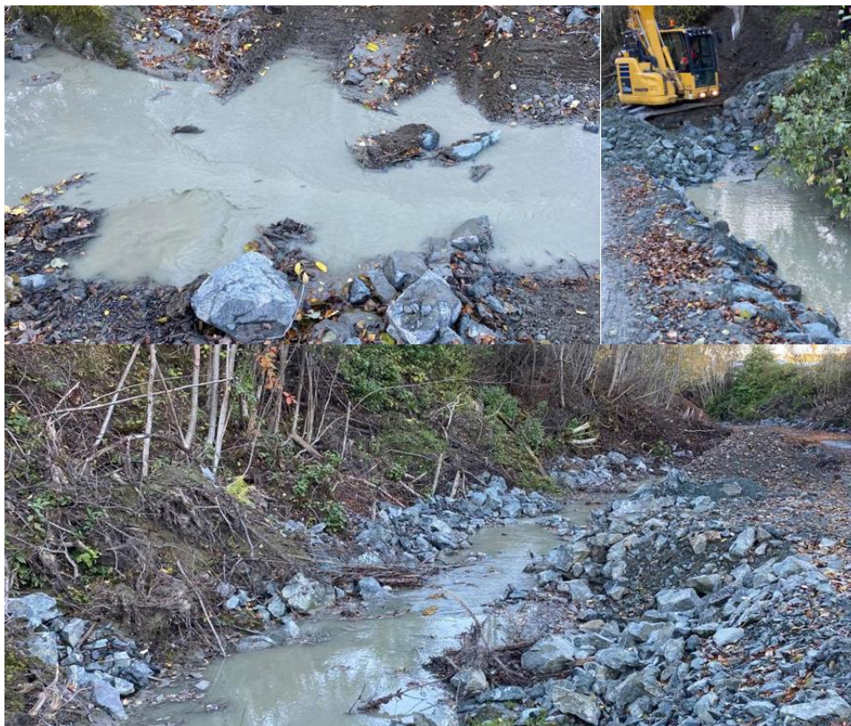
Figur 23. Vassdragsparti i Langbekken ved Kvamsleret i ferd med å sikres for ras høsten 2020. Arbeidet gir stor slam- og partikkelbelastning til Langbekken. Foto: NINA.
