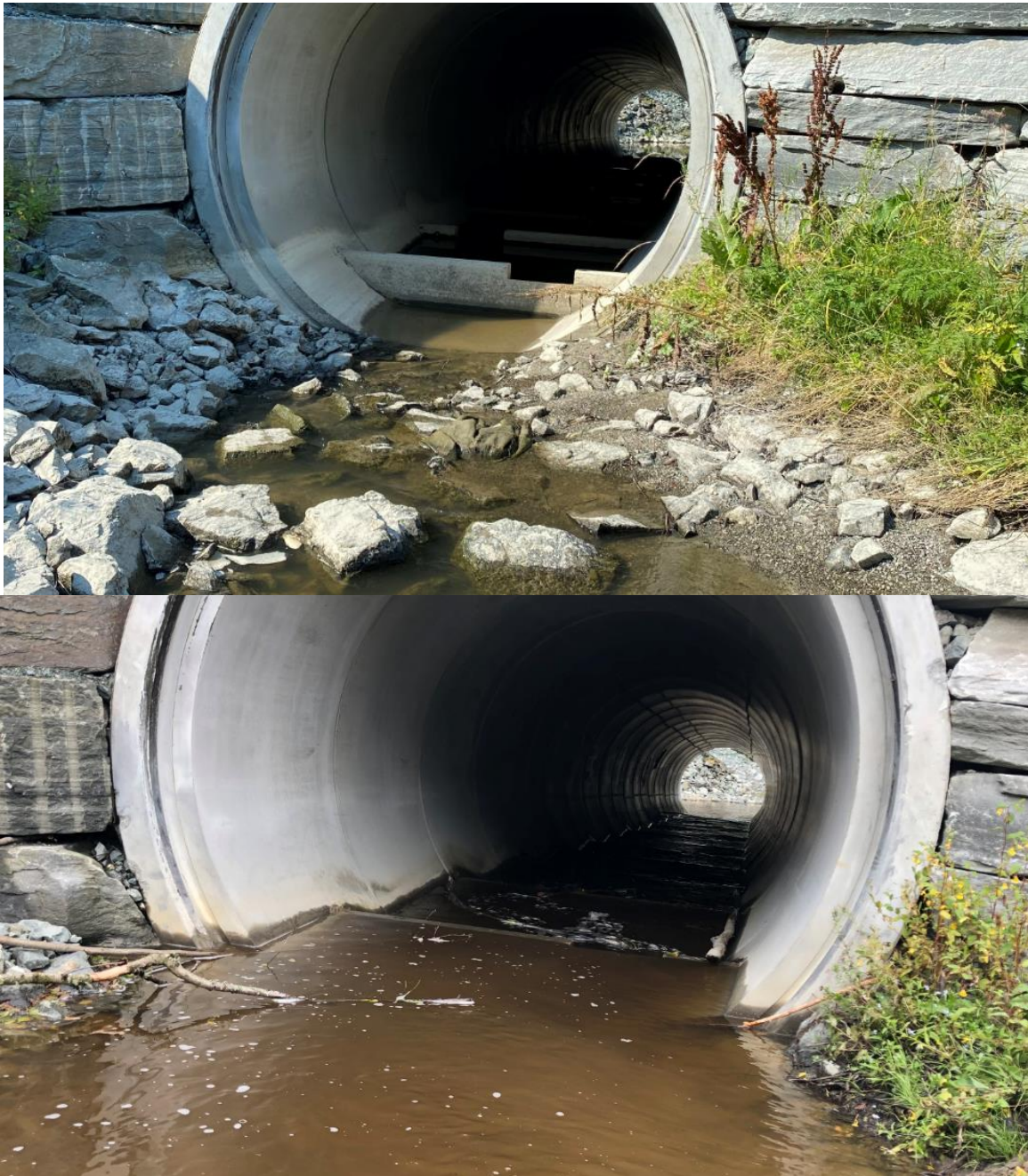
Figur 7. Veikulvert med innlagte terskler som fungerer som fisketrapp i Ratbekken når vannføringen er over middels høy. På lav vannføring (øverst, foto fra 2020) er tiltaket vandringstoppende, mens høy vannføring gir gode vandringsforhold (nederst, foto fra 2019). Foto: NINA.
