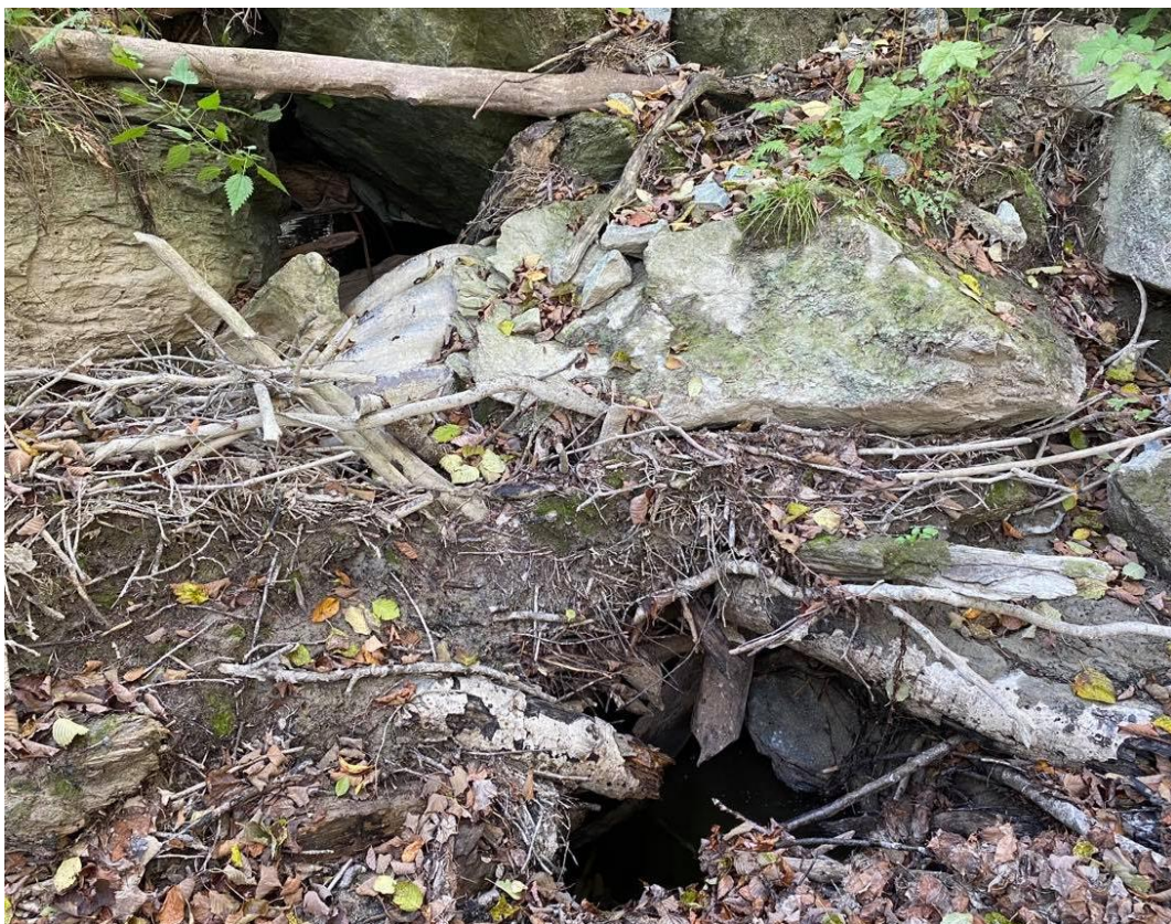
Figur 17. Sammenrast kulvert under Hjellhaugveien er dekt av utrast eller dumpet storstein, og har gått tett av dødt trevirke og kvist. Foto: NINA.
