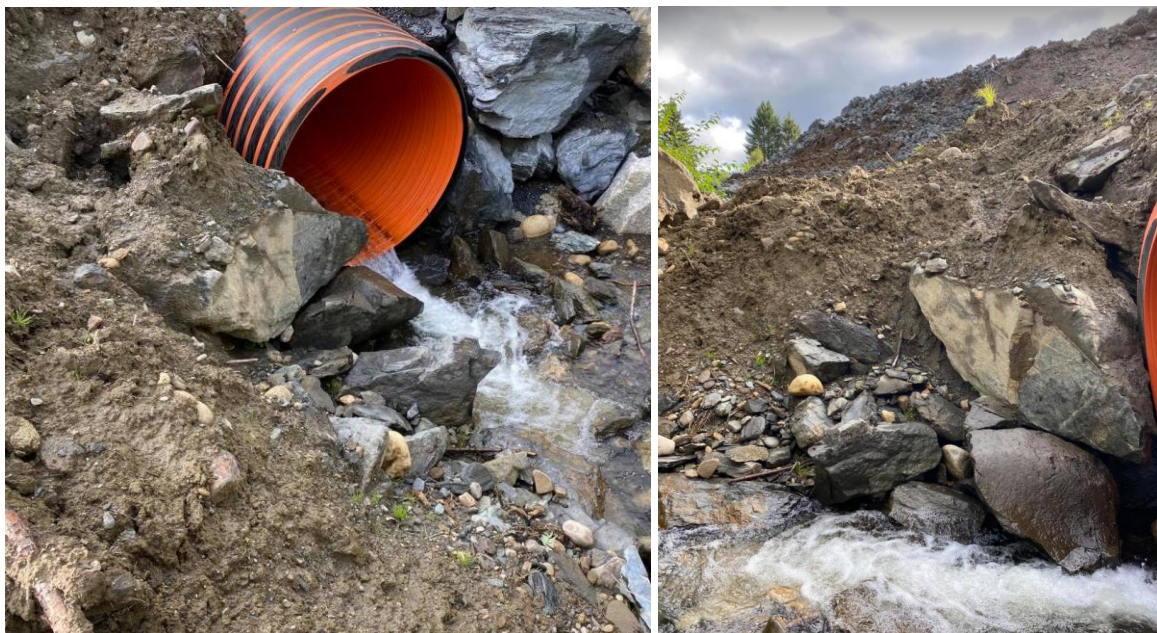
Figur 57. Jord, finpartikler og slam finner lett veien ut i Skårvollbekken etter stor graveaktivitet nær bekkeløpet i 2020. Bratt gradient ned mot bekkeløpet og mye regn spylar dette ut i bekken, og gir kraftig partikkelforurensning. Nedslamming kan kvele rogn og føre til fiskedød dersom omfanget overskrider Skårvollbekkens tåleevne/resipientkapasitet. Foto: NINA.
