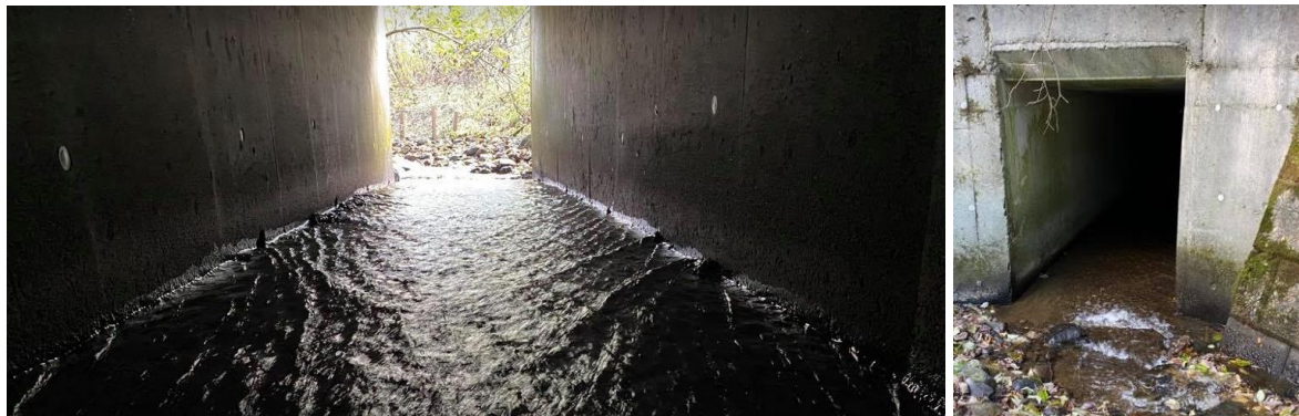
Figur 11. T.v.: Foto oppover Ratbekken, fra innside av stikkrenna. Flat asfalt/betongbunn som bør få fastmontert buner, som skaper større vanndybde, roligere vannhastighet og bedre vandringsforhold for sjørret. T.h.: Inngangen til stikkrenna, foto fra overside. Foto: NINA.
