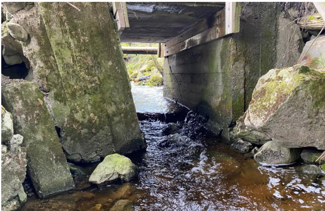
Foto 27. Stikkrenne under Erviknesveien. Foto: Morten André Bergan.
