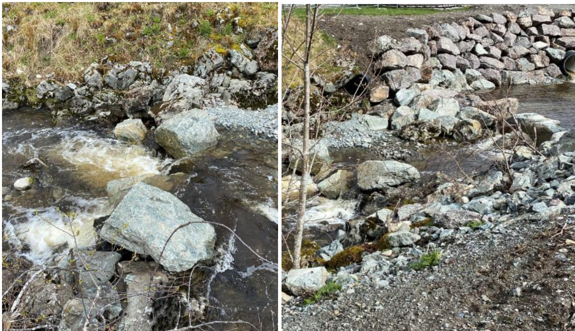
Foto 6. Oppterskling nedstrøms kulvert under Fylkesvei 710. Foto på vannføring over middels. Foto: Morten André Bergan.
