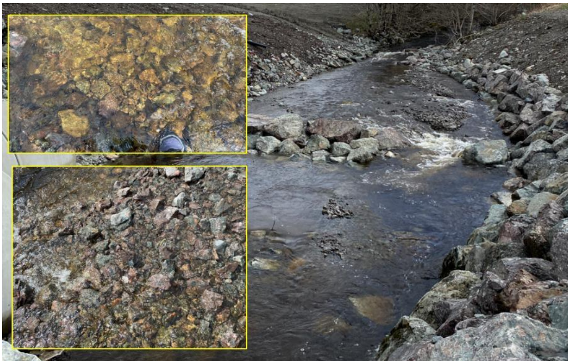
Foto 4. Elvestrekning i Botngårdselva etter at anleggsarbeid på Fylkesvei 710 er gjennomført. Steinsetting med utelukkende bruk av sprengstein har ført til at opprinnelige gyteområder (se foto 3 ) er tapt. Foto: Morten André Bergan.
