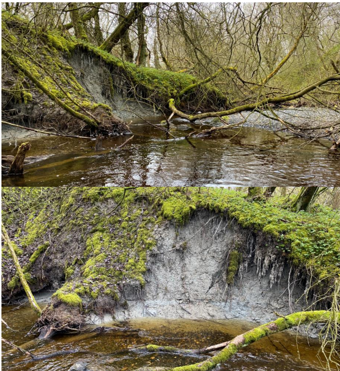
Foto 31. Stor erosjons- og rasproblematikk knyttet til unaturlig forhøyd vannhastighet nedstrøms kulvert under Fylkesvei 710. Foto: Morten André Bergan.
