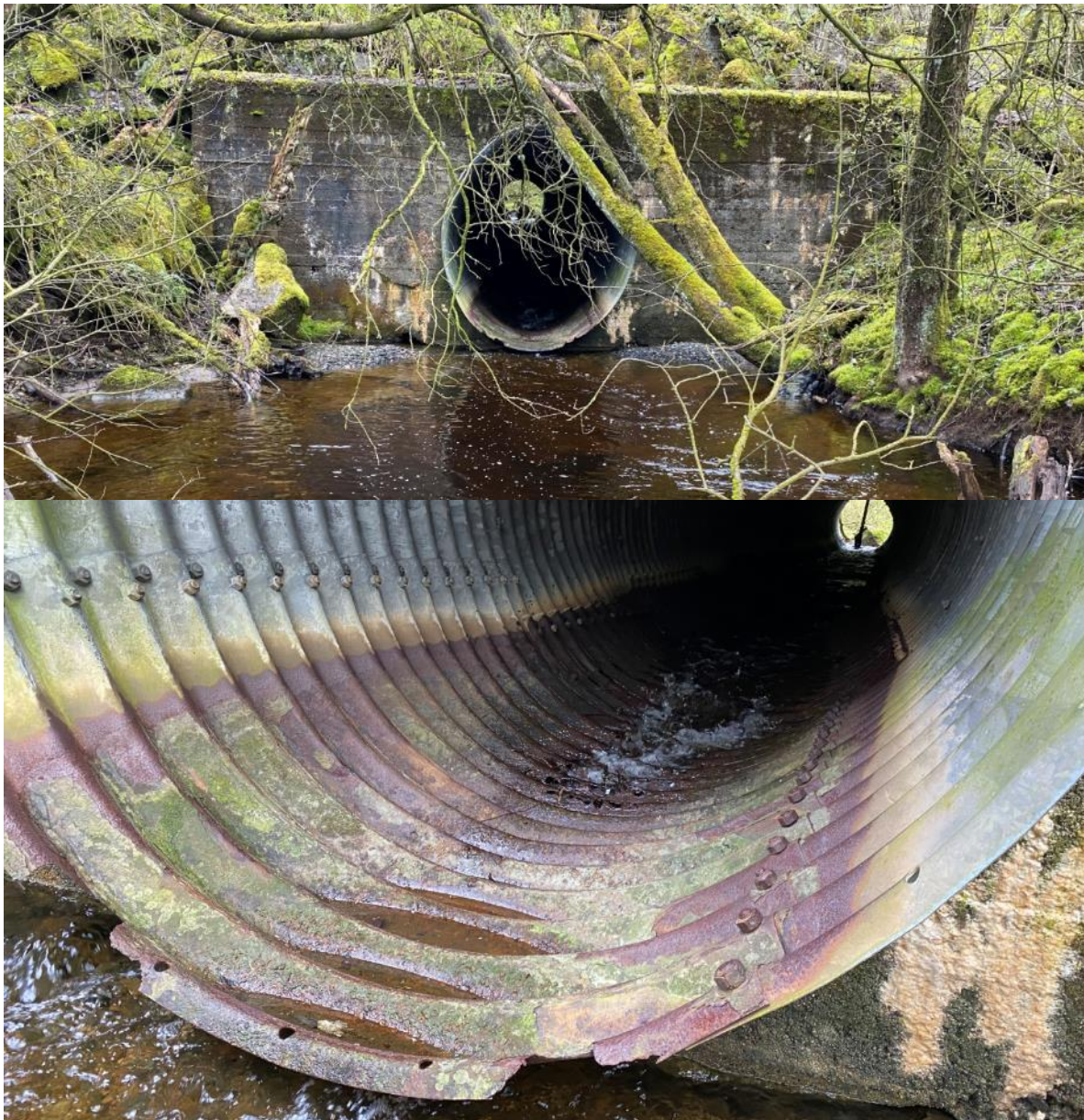
Foto 30. Kulvert under Fylkesvei 710 i Storlibekken har sammenrast bunn og er kraftig underdimensjonert for flomvannføring. Inngrepet er svært vandringshindrende. Foto: Morten André Bergan.
