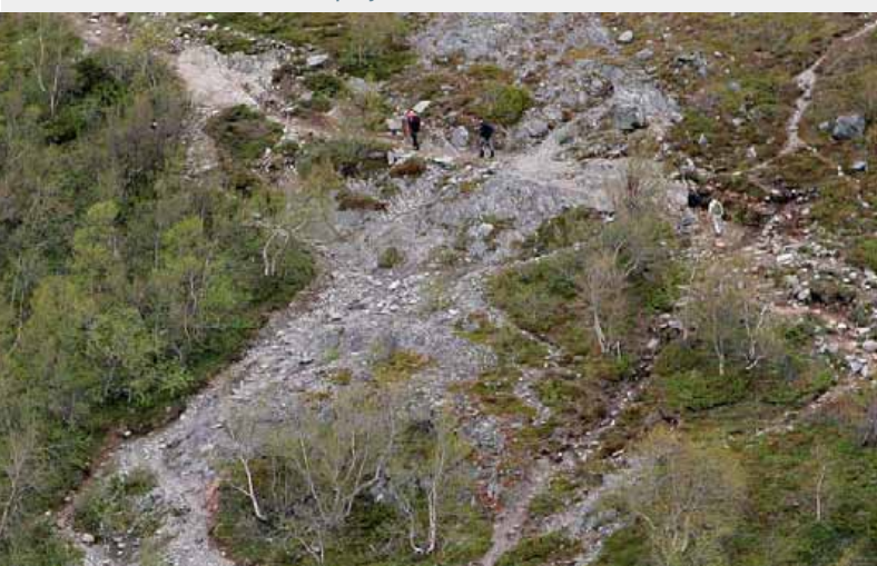
Figur 2. Erosjon langs stier ved Besseggen før arbeidet ble startet i 2005. - Erosion along the path at Besseggen prior to the restoration project started in 2005. Foto/Photo: R. Solem.
