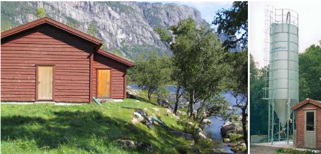
Figur 2. Eksempler på kalkingsanlegg i norske vassdrag. I Espedalselva (til venstre) ble kalkingen på utløpet av Espedalsvatnet startet i 1996. Som ved de fleste nyere kalkingsanlegg ble det benyttet en liggende kalkdoserer som er bygget inn i en driftsbygning. I Ogna (til høyre) ble kalkingen startet allerede i 1991, da stående kalkdoserere var det mest vanlige. - Examples of liming facilities in Norwegian rivers. In River Espedalselva (left) liming started at the outflow of Lake Espedalsvatnet in 1996. As for most modern liming facilities a built-in horizontal dispenser was used. In River Ogna (right) the liming started already in 1991, when standing dispensers were most common. Foto/Photo: B. M. Larsen.
