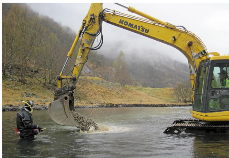
Figur 16. Fra utlegging av gytegrus med gravemaskin i Aurlandselva. Kvalifisert personell i snorkelutstyr angir plassering og mengde til maskinfører, og finfordeler grusen med rive/grafse. Foto: Bjørn Barlaup
