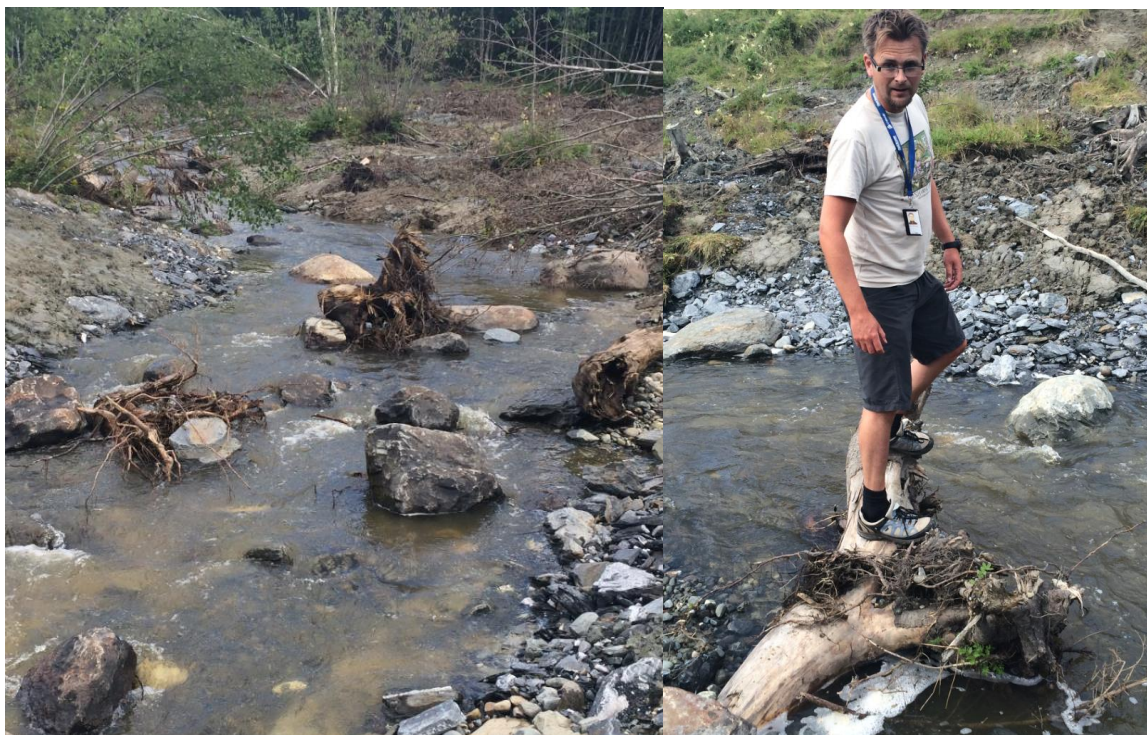
Figur 20. Utlegging og forankring av røtter i kombinasjon med storstein etter ras-sikring av Hofstadelva. Foto: NINA.
