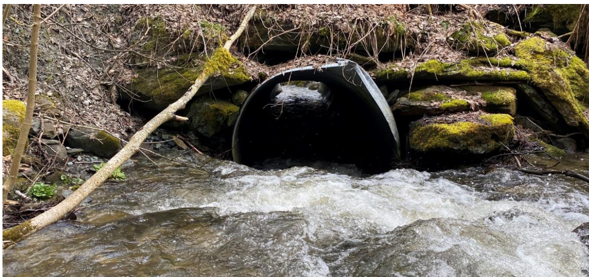
Foto 14. Kulvert under vei til trafo-stasjon. Foto: NINA.
