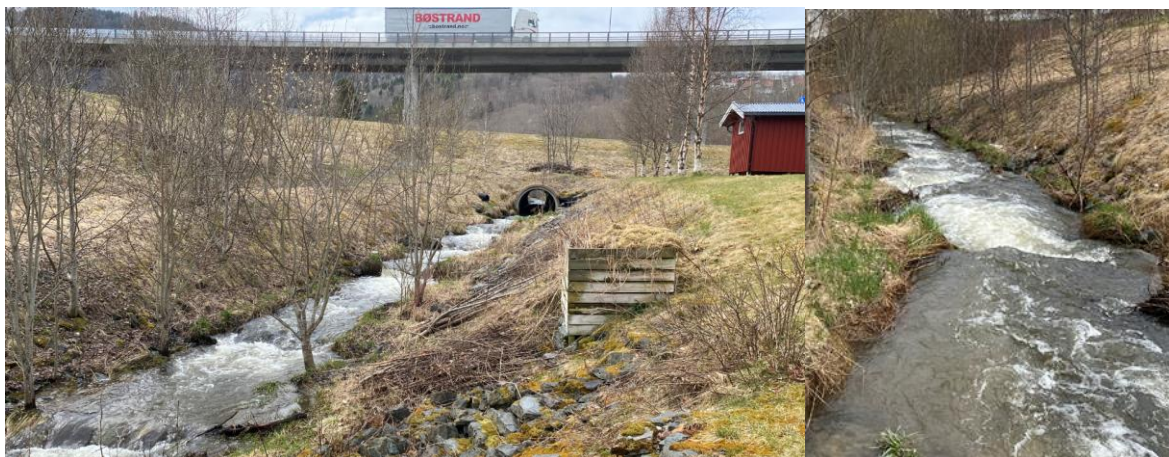
Foto 12. Storstein og blokk lagt i kanaliserte bekkestrekninger opp mot bekkelukking under Snøfuglveien og E39. Foto: NINA.
