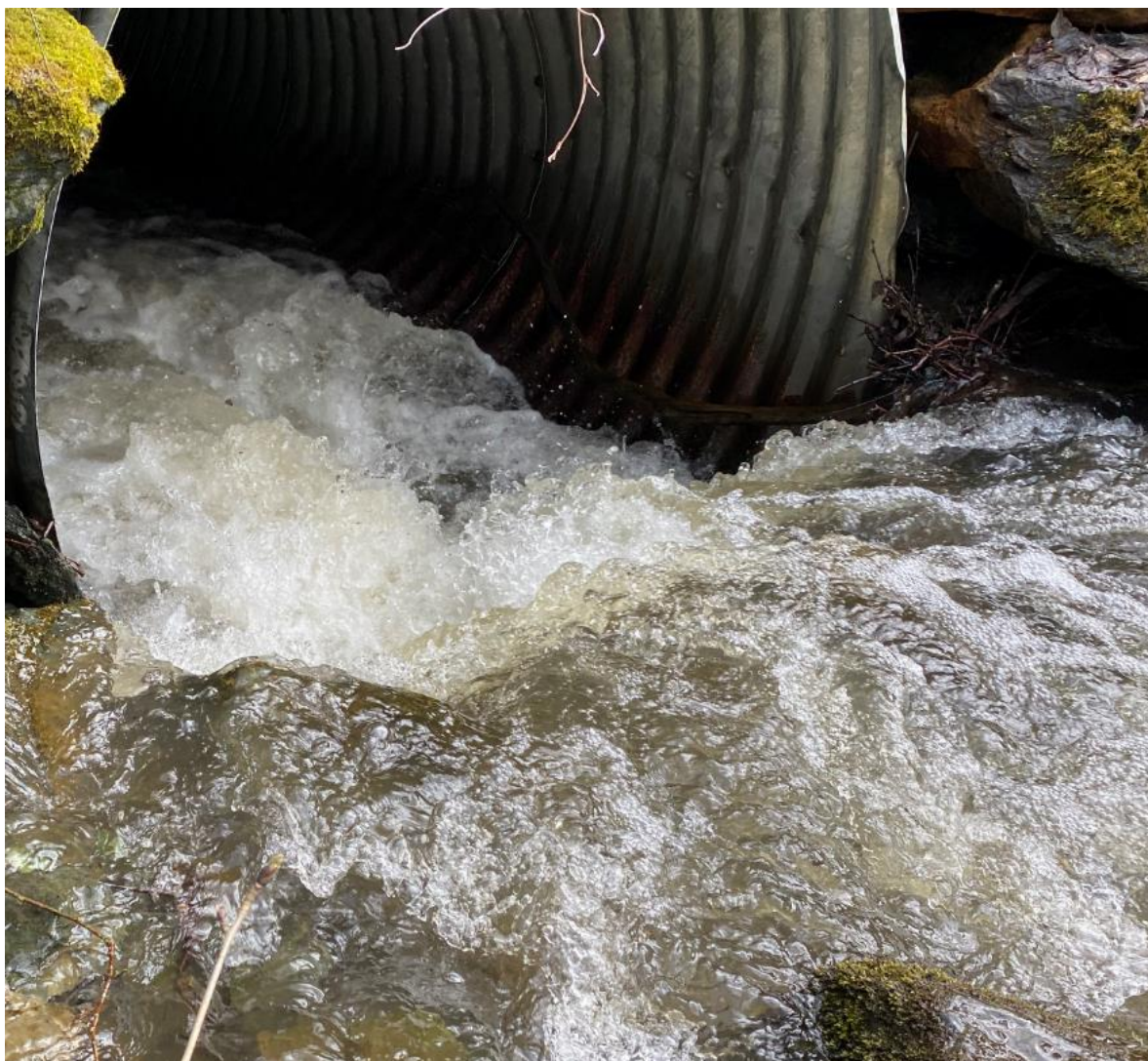
Foto 15. Kulvert under vei til trafo-stasjon. Foto: NINA.
