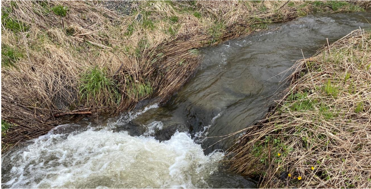
Foto 9. Storstein og blokk lagt i kanaliserte bekkestrekninger i Hammerbekken ved Hammerdalen 11. Bekkeløpet er her avsmalnet fra opprinnelige 3-5 meter til omlag 1 meter. Foto: NINA.
