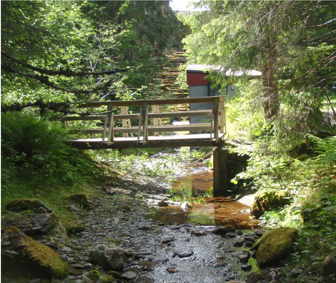
Foto 32. Strekning i Hammerbekken opp mot demningen ved Nydammen. Foto fra 2008, da lekkasjer i damkonstruksjonen opprettholdt minstevannsføring. Foto: Morten Andre Bergan.
