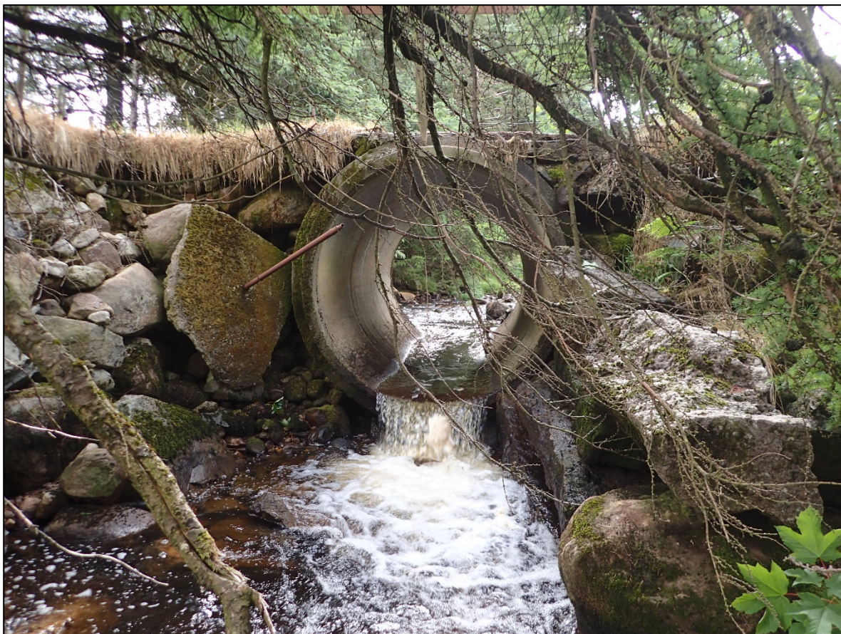
Foto 3.2.2. Kulvert ved Ualand. Kulverten fungerer som et vandringshinder, spesielt ved lav vannføring. Fotografiet er hentet fra foto 4 i Magerøy (2018a).
