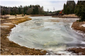
Bilde 8.4. Etter nærmere en måned med graving er dammen 2/3 ferdig den 28.02.2020. Bilde er tatt i den sørvestre enden av tjernet og breddene og øye på øst-siden gjenstår.
