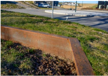
Bilde 9.24. Fastmontert ledegjerde av stål på Kjeller i Lillestrøm. Toppen er i plan med bakken på baksiden.
