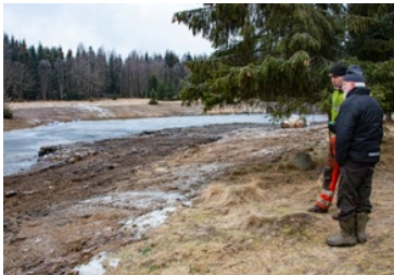
Bilde 8.2. Trond Vedum fra Våtmarksgruppe i prat med marskinfører Pål Lovin Hansen om neste steget i utgravingen av dammen på Bjørsrud.
