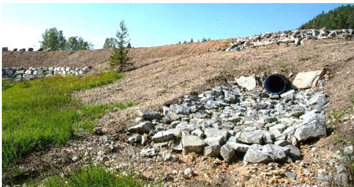
Figur 4.9. Utløpet av overvannsledningen vest for tjernet på Arsenalet 27. august 2019. Sideløpene kommer ut i bakken på hver side av hovedløpet. Foto: Børre K. Dervo, NINA ©.
