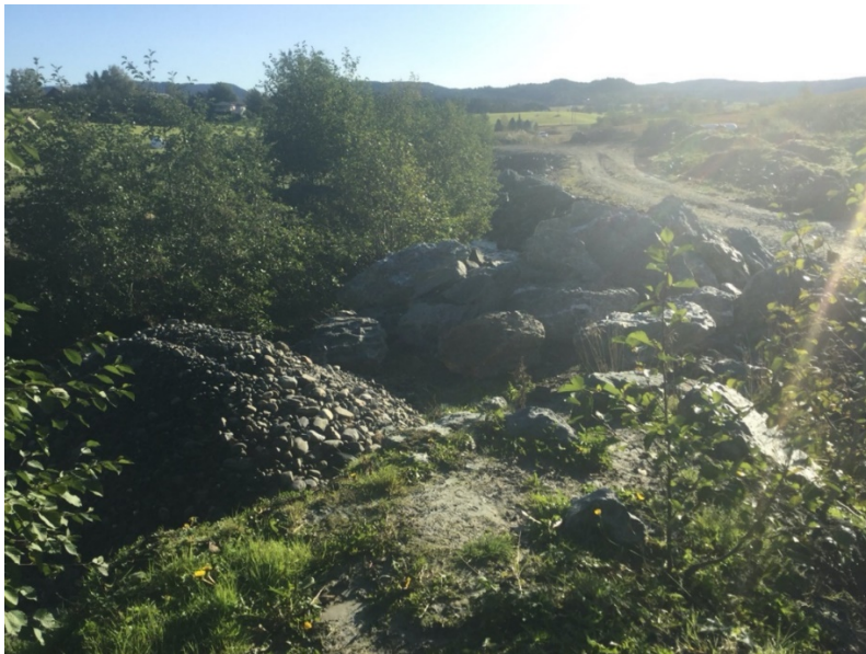
Figur 3.4.18. Anlegg under bygging like nedenfor samløpet mellom Dalelva og Lundbekken. Foto: Gunnar Kristiansen, Natur og Samfunn AS.
