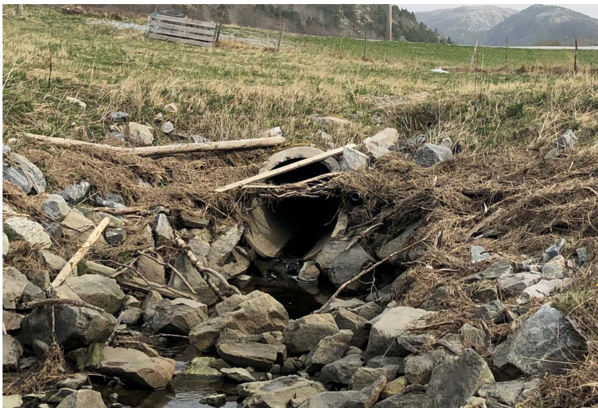
Foto 3: Kulvert under FV 715 i navnløs bekk til Nordvika. Foto NINA.
