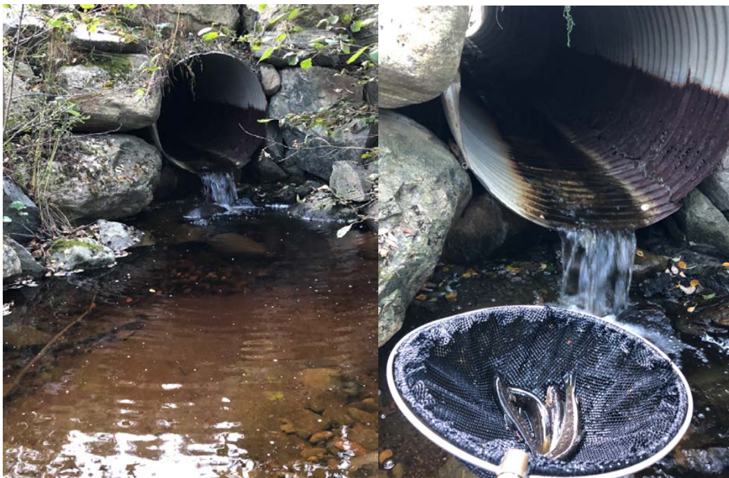
Figur 19. Kulvert i forbindelse med krysning av Sørnelansveien er vandringstoppende for små fisk, og sterkt vandringshindrende for større gytefisk ved mange vannføringer. Foto: NINA.
