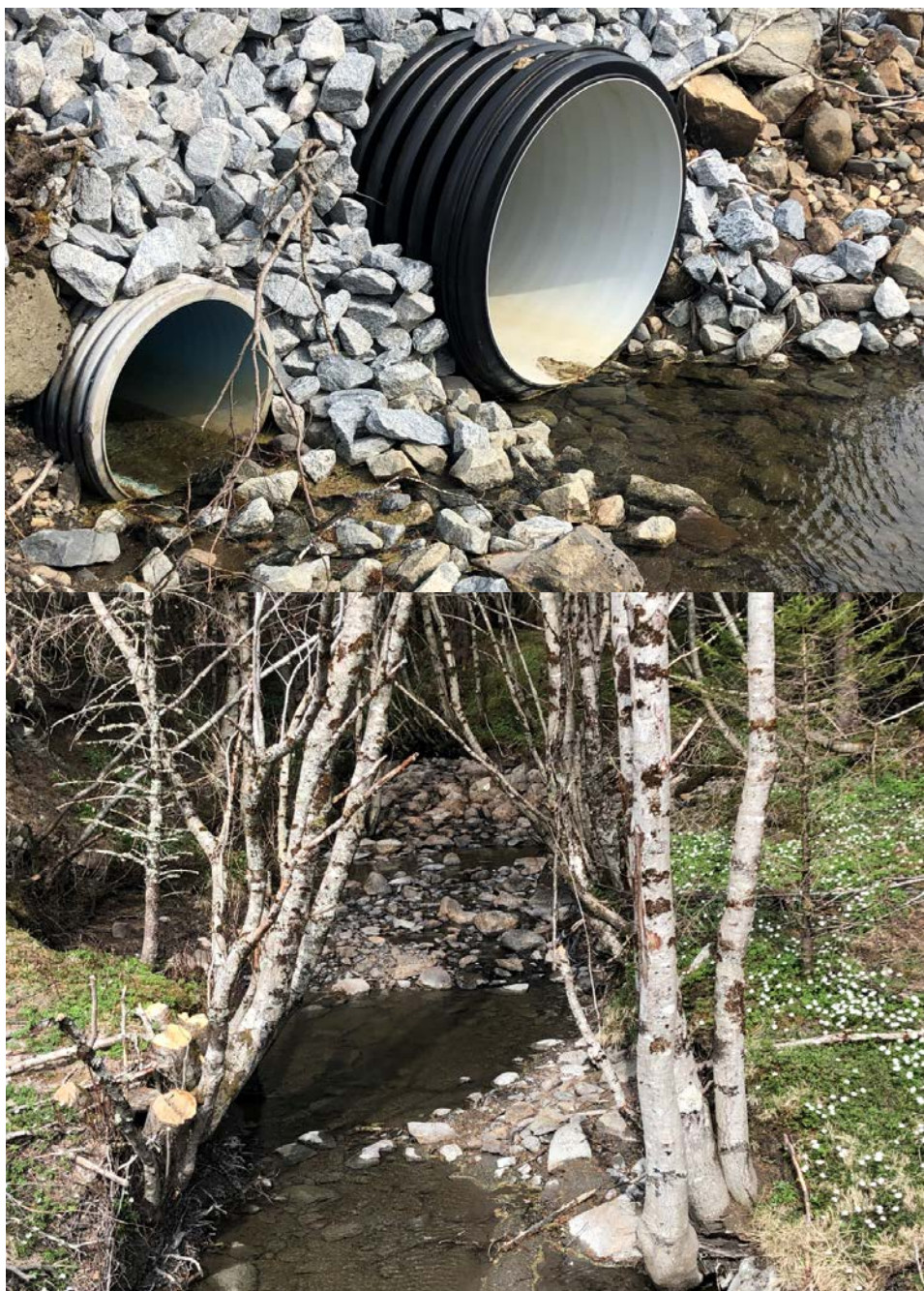
Foto 17: Ny kulvert under anleggsvei i Slåttbekken (øverst), og bekkpartier ovenfor anleggsveien (øverst). Foto: NINA.
