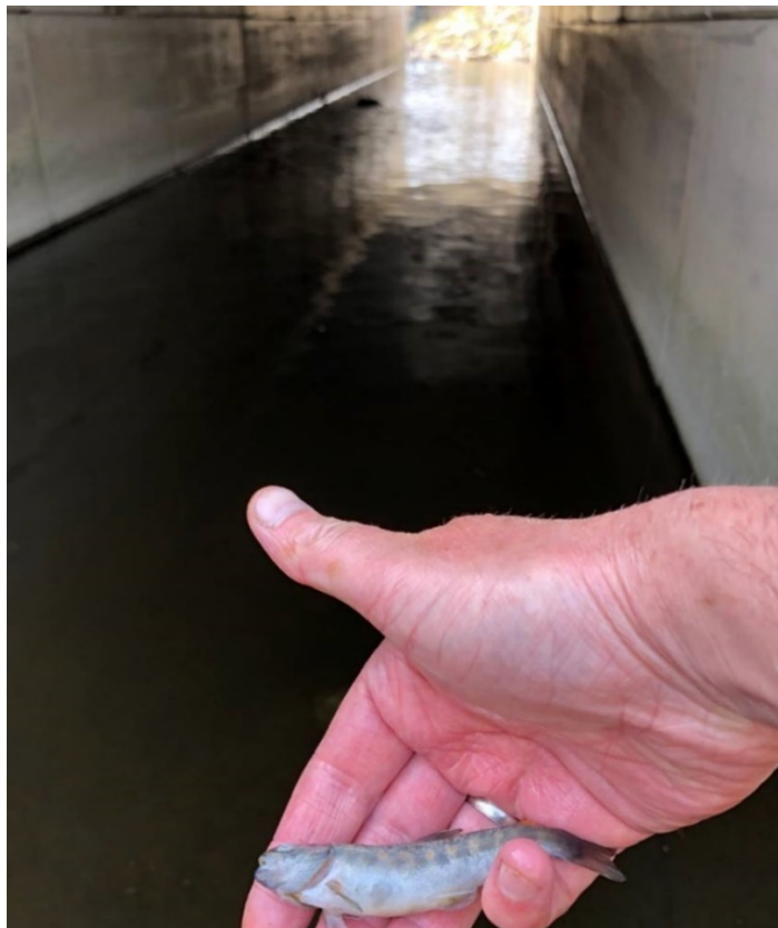
Figur 8. Nederste registrert dødfisk ble funnet like oppstrøms veikulvert under Fv 715.
