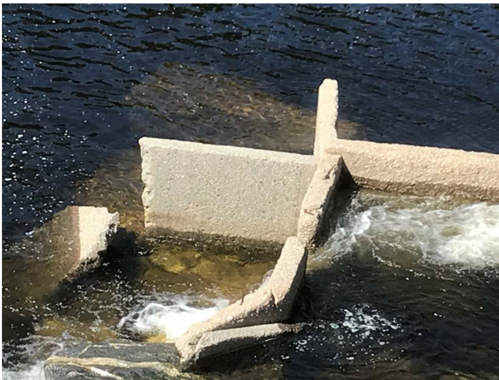
Figur 67. Nederste terskel i Åseggfossen er slått i stykker av is og flom i juli 2018. Foto: Anton Rikstad/Ståle Øverdal. .
