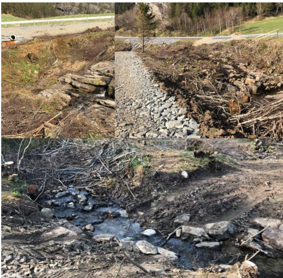
Figur 6. Utslippsrør med avrenning jernholdig vann til Skautjønnbekken nedstrøms Fv 715 (t.v.), og privat hogst/gravearbeid nedstrøms Fv 715 (t.h. og nederst). Foto fra april 2019. Foto: NINA.
